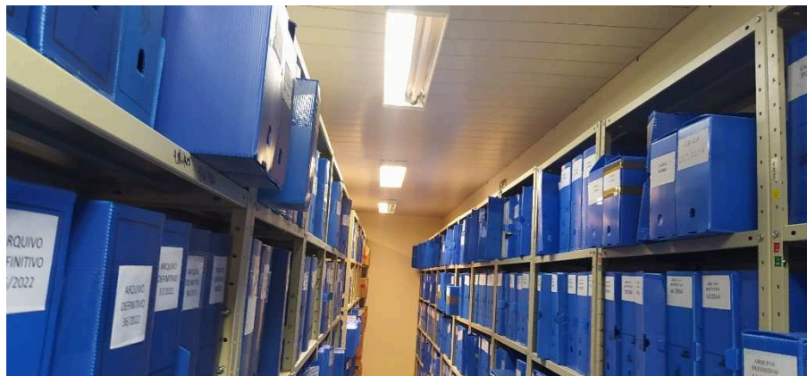
Imagem 05: Através do “embarrigamento” do forro se pode perceber que a estrutura de cobertura do arquivo encontra-se selada, oferecendo risco à segurança no caso da instalação de telha mais pesada que a existente
