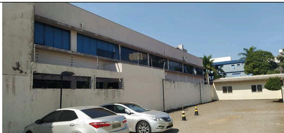
Imagem 07: Muro e elevações, na divisa lateral esquerda, com pintura bastante desgastada
