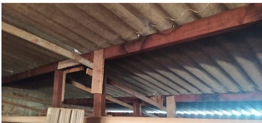
Imagem 03: Fragilidade e estado de deterioração do madeiramento e das terças sugerem a substituição da estrutura de cobertura por material metálico, com maior durabilidade e rigidez
