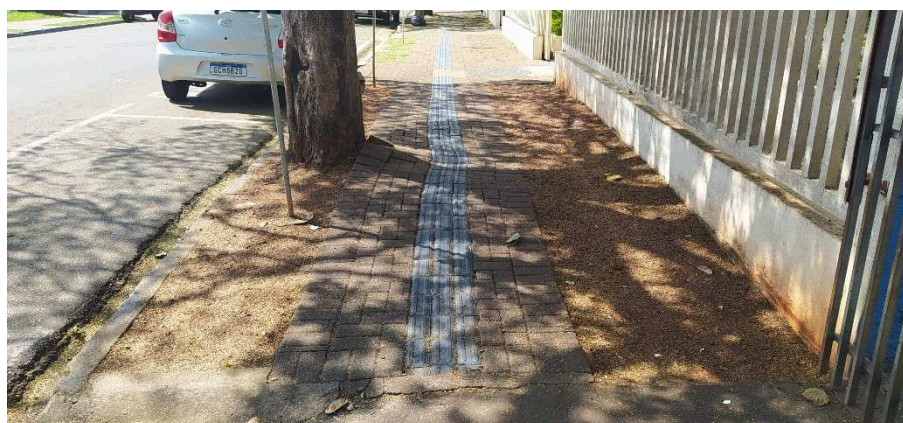
Imagem 17: Calçamento em paver e piso tátil no passeio público apresenta irregularidades devido às deformações ocasionadas pelas raízes das árvores. O gramado encontra-se praticamente morto em vários trechos.
