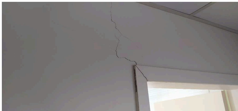
Imagem 11: Fissuras existentes em paredes do prédio principal
