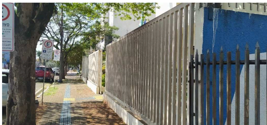
Imagem 06: Gradil frontal e mureta, ambas com a pintura deteriorada
