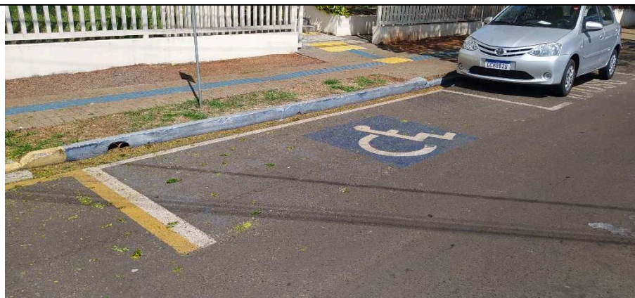
Imagem 18: Não há rampa de acesso PNE entre o pavimento asfáltico e o passeio público
