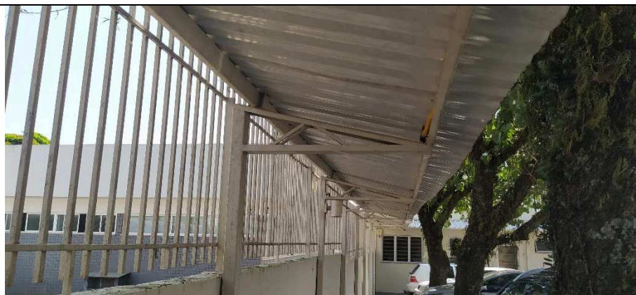
Imagem 14: Sugestão de instalação de concertina sobre o gradil, complementando a existente (apenas num único trecho) e sobre a cobertura do arquivo
