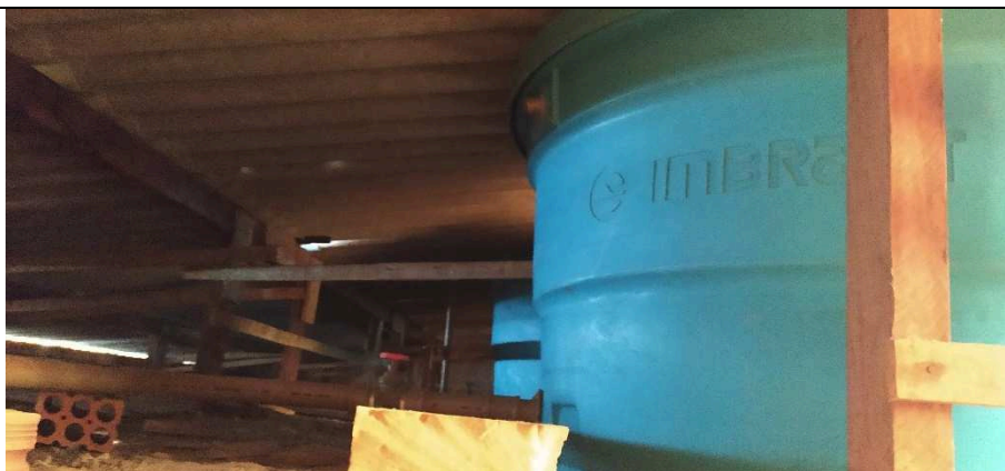
Imagem 02: A pequena altura da estrutura de cobertura impede a abertura do reservatório para execução da limpeza e reparos
