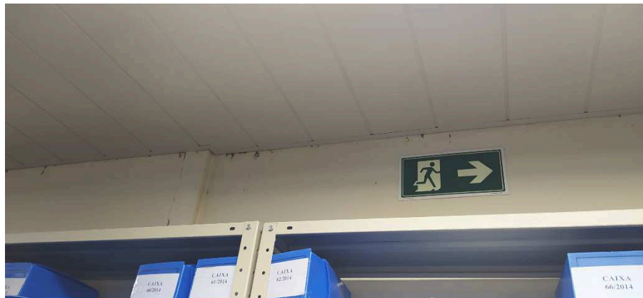
Imagem 10: Focos de infiltração em paredes do arquivo, mancharam a pintura
