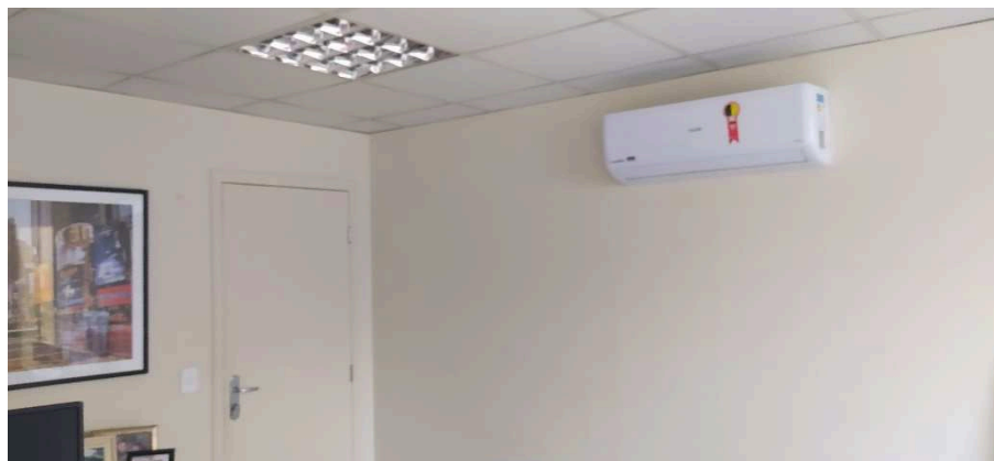
Imagem 12: Aparelho de ar condicionado split convencional, instalado no gabinete do juiz titular. Deverá ser substituído por split inverter
