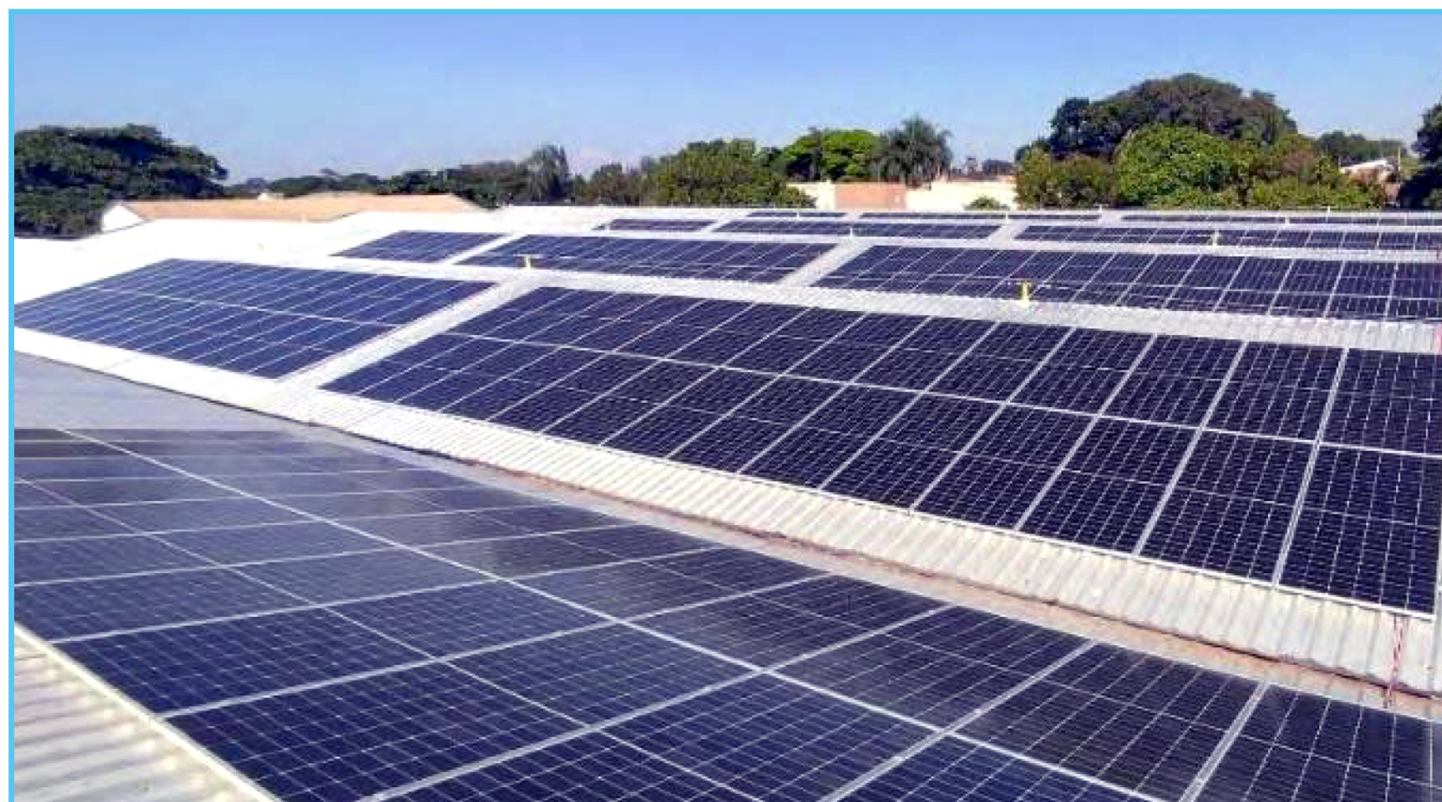
Usina solar da Vara do Trabalho de Londrina/PR
