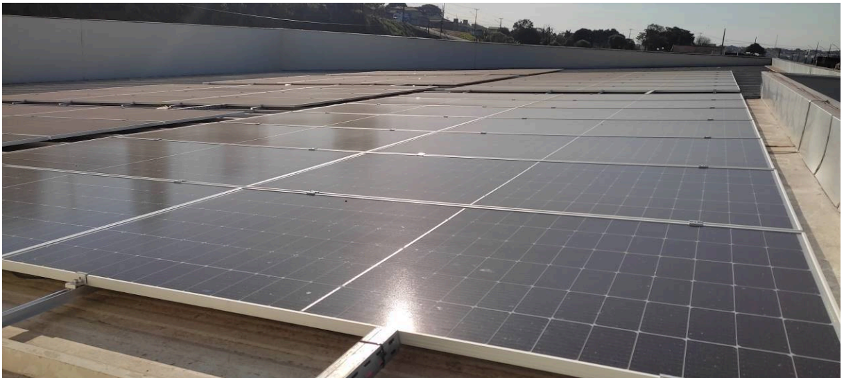
Figuras 01 – Cobertura com placas instaladas – Apucarana
