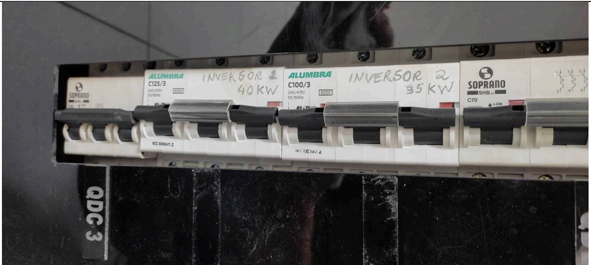
Figuras 03 – Conexão à rede elétrica do imóvel – Apucarana
