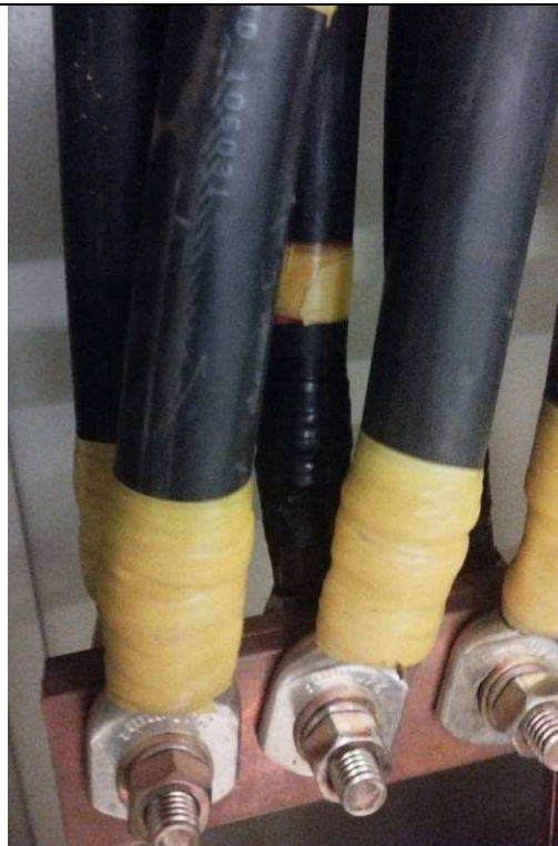
Figura 03 – Ligação elétrica QDGBT
