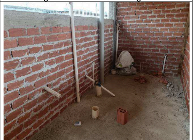
Figura 36: Pontos de esgoto.
