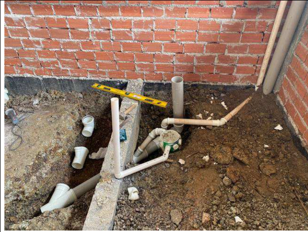
Figura 31: Pontos de esgoto.
