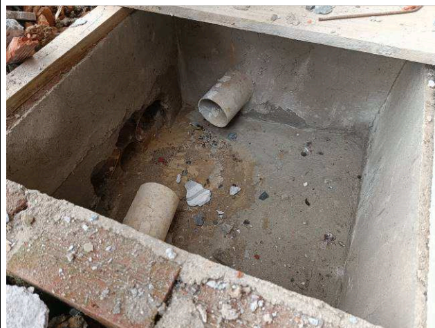
Figura 38: Pontos de esgoto.
