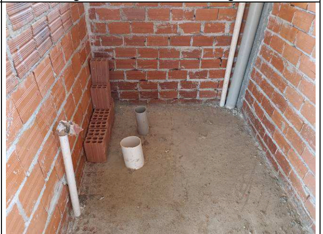
Figura 34: Pontos de esgoto.
