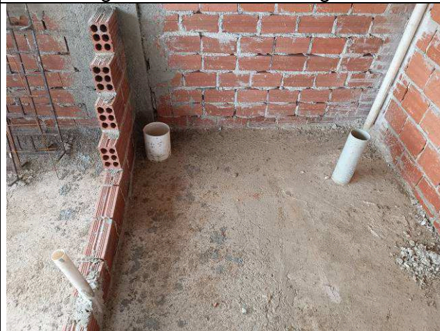
Figura 33: Pontos de esgoto.
