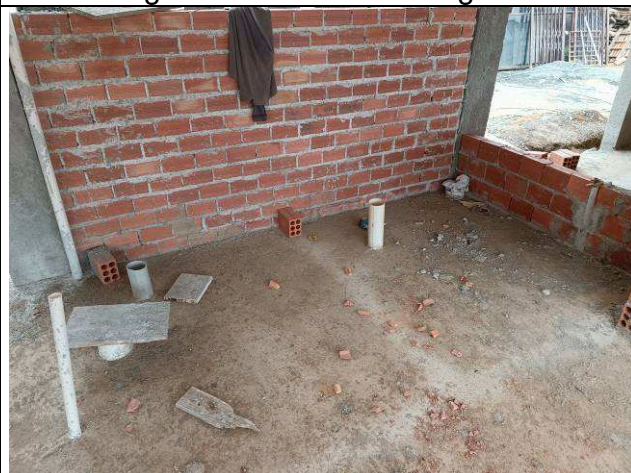
Figura 35: Pontos de esgoto.
