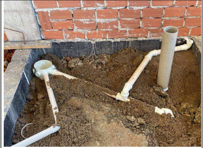
Figura 32: Pontos de esgoto.
