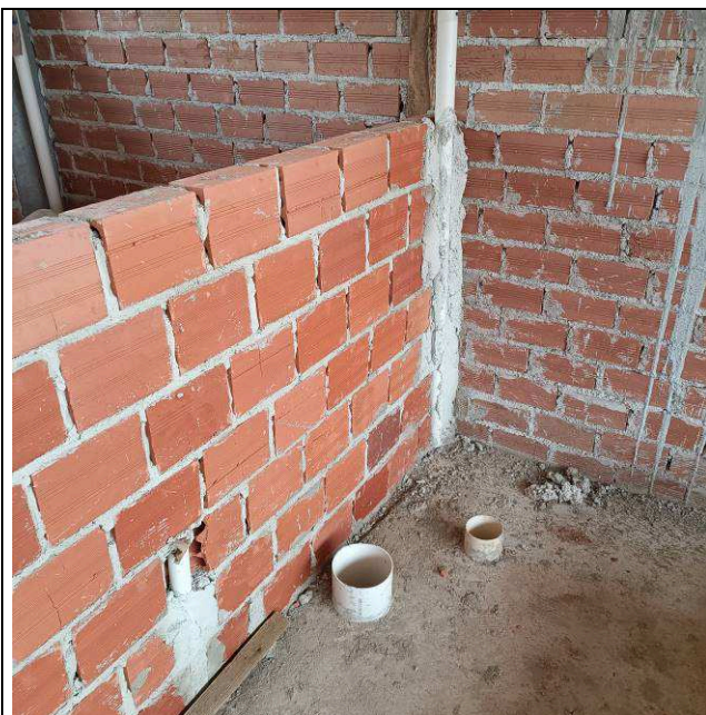
Figura 37: Pontos de esgoto.
