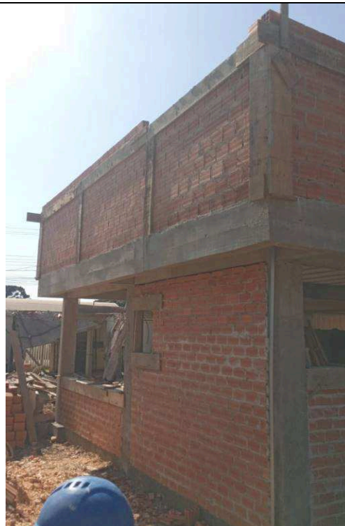
Figura 08: Alvenarias das platibandas.
