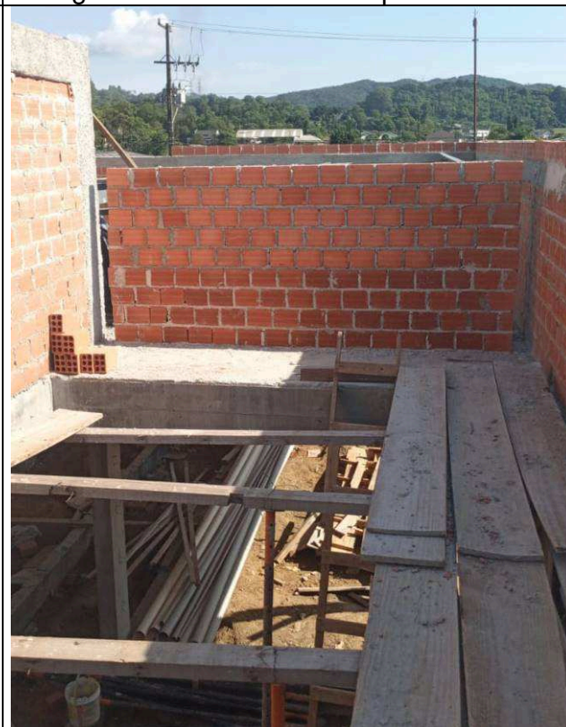
Figura 10: Alvenarias das platibandas.
