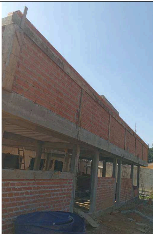
Figura 07: Alvenarias das platibandas.
