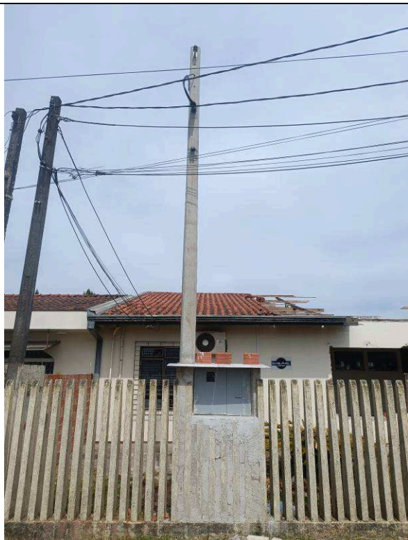
Figura 25: Entrada de Energia.
