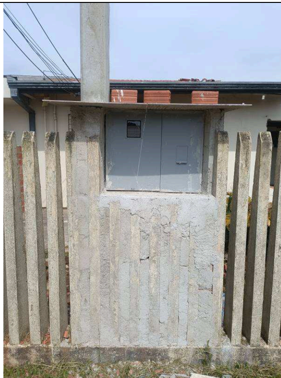
Figura 26: Entrada de Energia.
