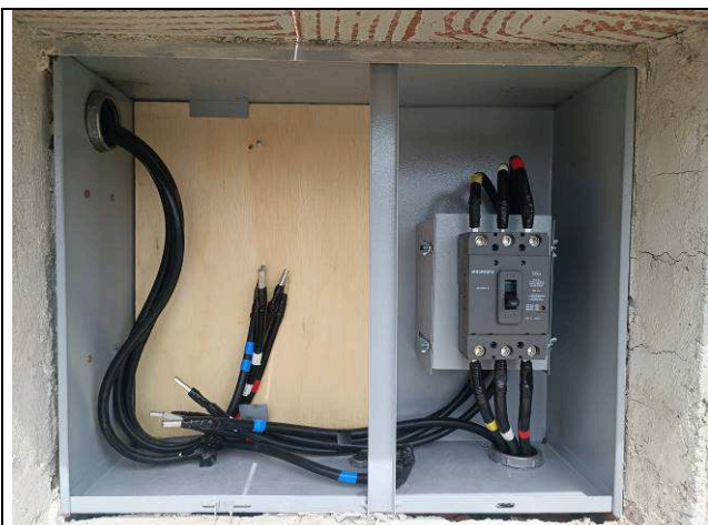
Figura 29: Entrada de Energia.
