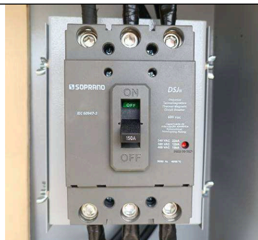
Figura 30: Entrada de Energia.
