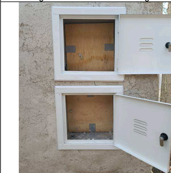
Figura 31: Entrada de Energia.
