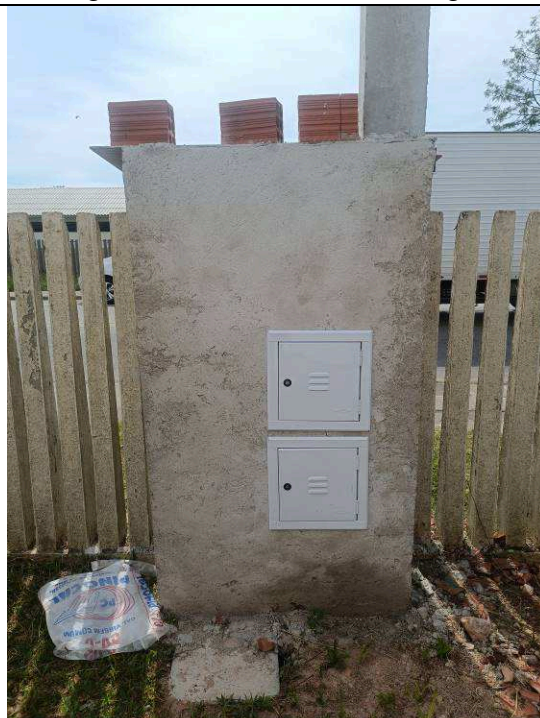
Figura 28: Entrada de Energia.
