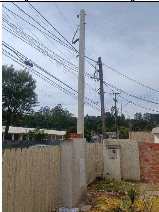
Figura 27: Entrada de Energia.
