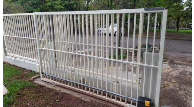
Figura 07C: Portão metálico de correr automatizado. Instalado na entrada do estacionamento público
