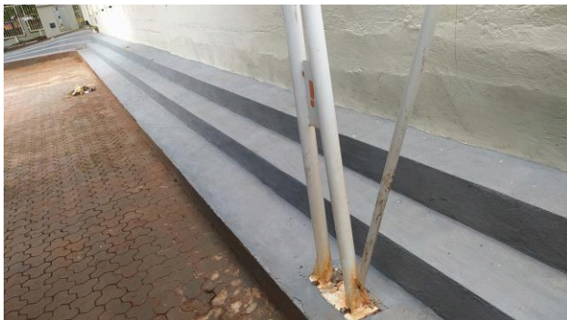
Figura 29C: Execução da contenção escalonada junto à divisa posterior e lateral direita do imóvel
