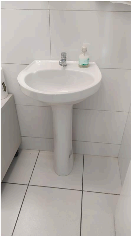
Figura 13C: Lavatório instalado no banheiro do juiz titular
