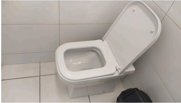
Figura 16C: Vaso sanitário e assento, instalados no banheiro do juiz titular
