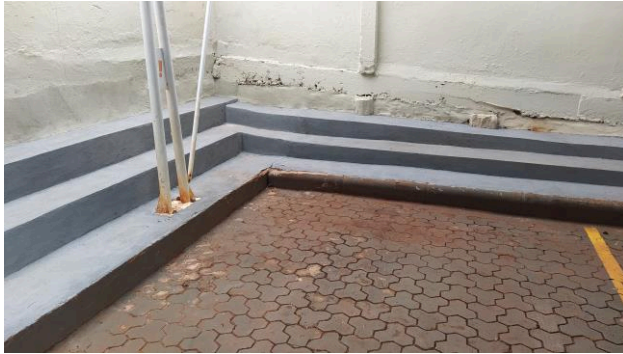
Figura 27C: Execução da contenção escalonada junto à divisa posterior e lateral direita do imóvel
