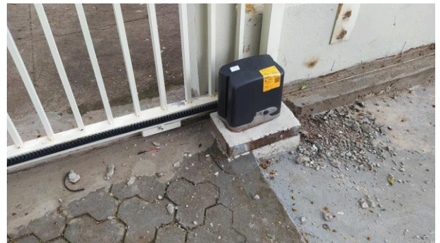
Figura 11C: Motor do portão do acesso ao estacionamento privativo
