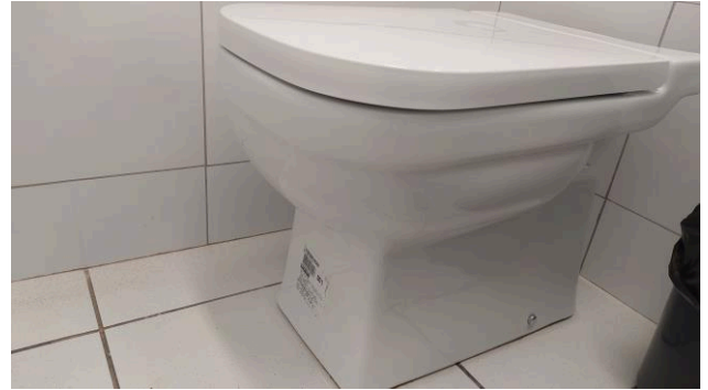
Figura 17C: Vaso sanitário e assento, instalados no banheiro do juiz titular
