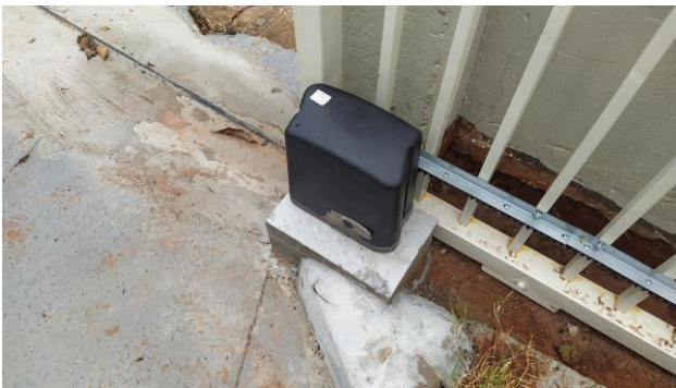
Figura 10C: Motor de um dos portões do acesso ao estacionamento público
