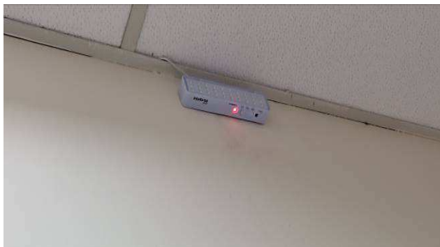
Figura 75: Blocos de emergência
