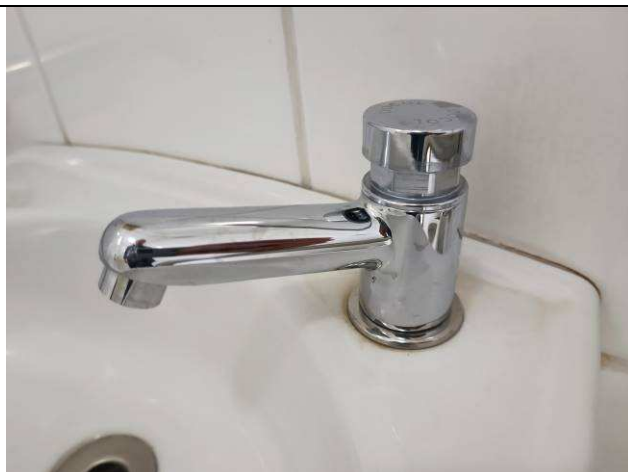
Figura 98: Torneira lavatório – banheiro público feminino.
