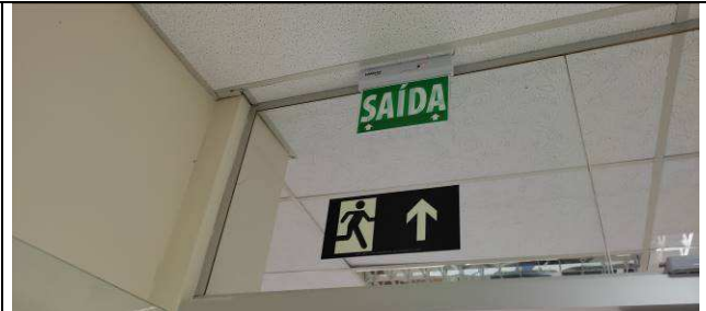
Figura 78: Blocos balizadores de emergência
