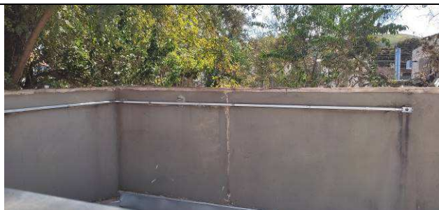
Figura 104: Infraestrutura elétrica nas platibandas
