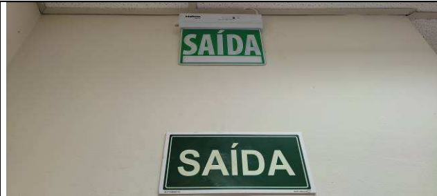
Figura 77: Blocos balizadores de emergência
