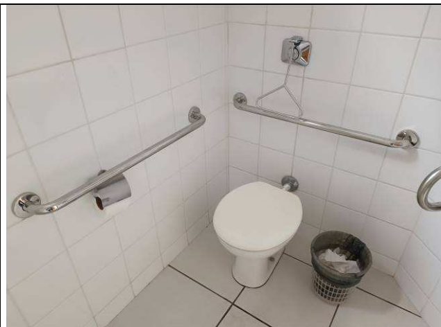
Figura 97: Barras de apoio bacia sanitária – banheiro público masculino.
