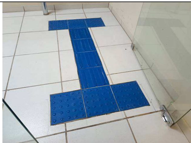
Figura 92: Piso podotátil interno.
