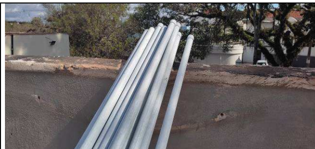
Figura 103: Infraestrutura elétrica nas platibandas
