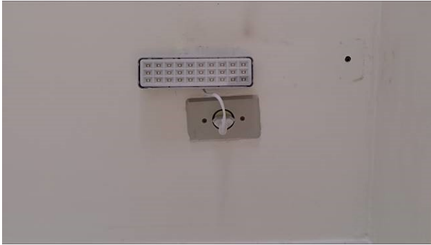
Figura 17E: iluminação de emergência – bloco
