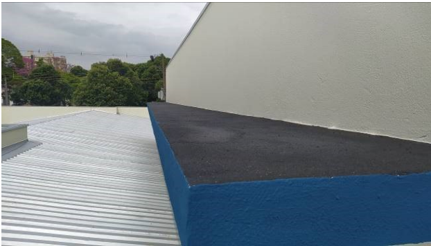
Figura 14C: Pintura asfáltica impermeabilizante na face superior da marquise posterior do saguão
