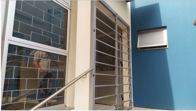
Figura 24C: Gradil de proteção da porta de acesso ao saguão dos PABs
