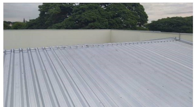
Figura 11C: Pintura das faces internas das platibandas – região dos PABs
