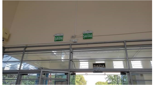
Figura 18E: iluminação de emergência – balizador
