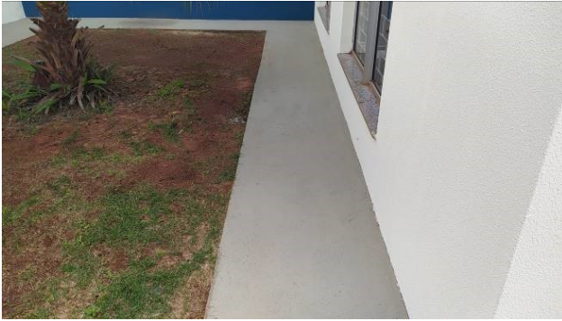
Figura 18C: Pintura das calçadas no perímetro do prédio – região da sala de audiência 2
