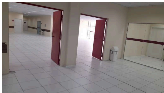
Figuras 20 – Portas corta-fogo.
