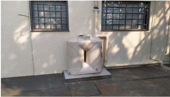
Kit instalado no FT de Umuarama
