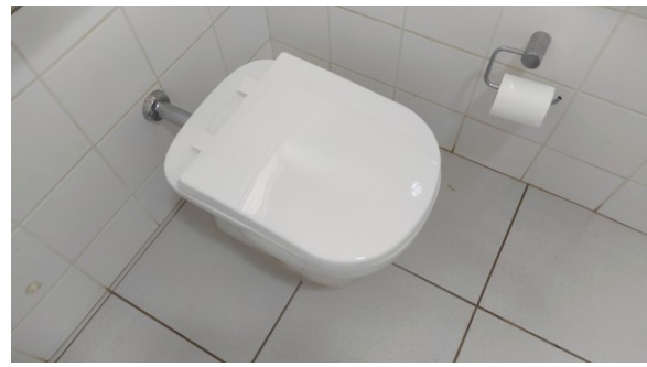
Detalhe do assento instalado em vasos sanitários, em Ivaiporã
