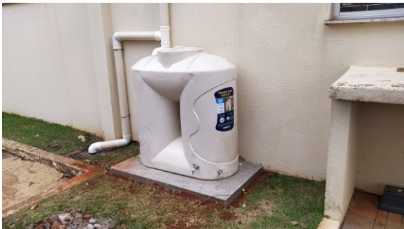
Kit de reserva e aproveitamento de águas pluviais, instalado na VT de Ivaiporã
