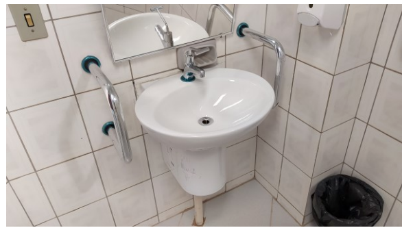
Lavatório com coluna suspensa, barras de apoio para lavatório e torneira de pressão, instalados no FT de Umuarama
