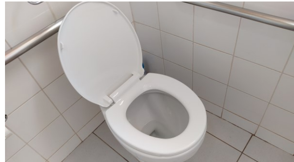
Assento sanitário, instalado em Cianorte
