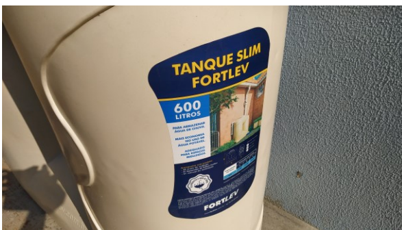
Etiqueta do fabricante, mostrando a capacidade do tanque instalado em Paranavaí
