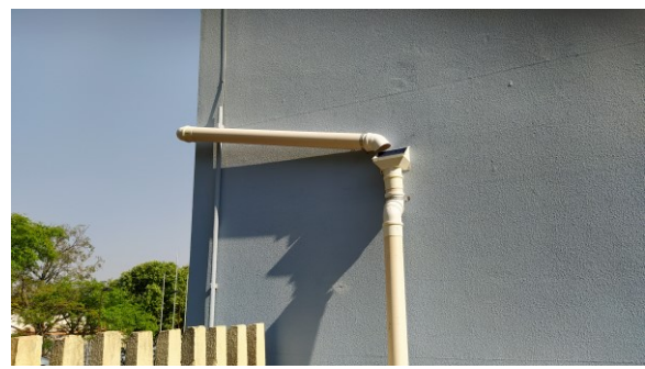
Filtro separador de folhas, instalado em Paranavaí
