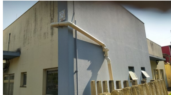
Detalhe da tubulação de captação pluvial e abastecimento do reservatório, em Paranavaí
