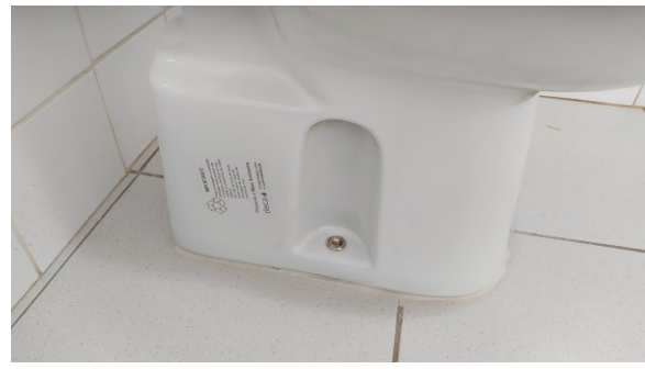
Detalhe de um vaso em perfil, instalados em Ivaiporã
