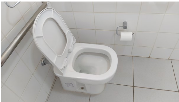
Vaso sanitário PNE, instalado em Ivaiporã
