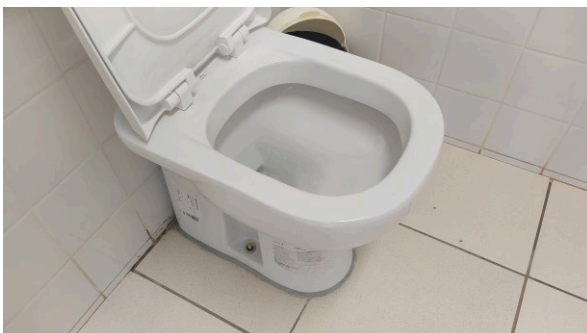
Vaso sanitário PNE, instalado em Paranavaí
