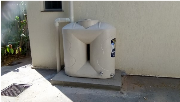
Kit de reserva e aproveitamento de águas pluviais, instalado na VT de Nova Esperança
