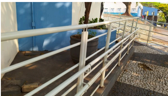
Transformação de corrimão simples em corrimão duplo e correção da altura do guarda-corpo, na rampa de acesso PNE ao FT de Umuarama
