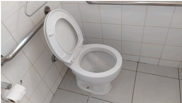
Vaso sanitário PNE, instalado em Cianorte
