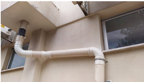
Detalhe da tubulação de captação pluvial e abastecimento do reservatório, em Ivaiporã
