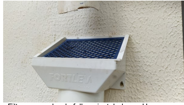
Filtro separador de folhas, instalado em Umuarama
