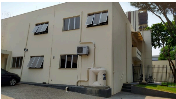
Kit instalado na VT de Cianorte
