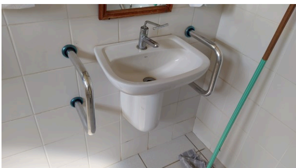
Barras de apoio para lavatório PNE, instaladas na VT de Nova Esperança
