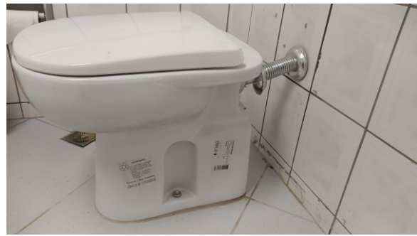
Vaso sanitário PNE, instalado em Umuarama
