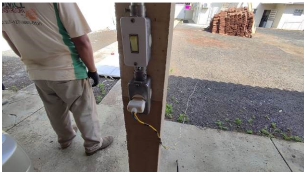
Figura 13E: infraestrutura elétrica, interruptor, tomada
