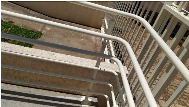
Figura 19C: Pintura do guarda-corpo e corrimãos da rampa de acesso PNE, na parte frontal do imóvel
