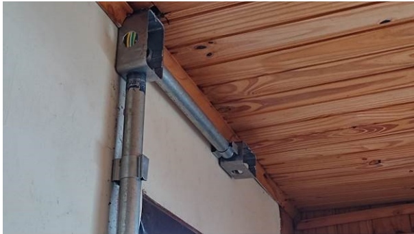
Figura 09E: infraestrutura elétrica e cabeamento parcial - edícula
