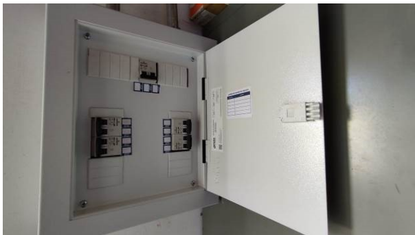
Figura 15E: quadro elétrico Edícula
