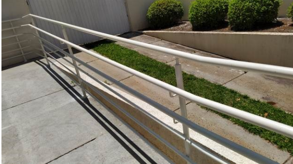
Figura 17C: Pintura do guarda-corpo e corrimãos da rampa de acesso PNE, na parte frontal do imóvel
