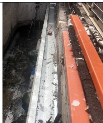
Figura 16: calha de aço galvanizado.
