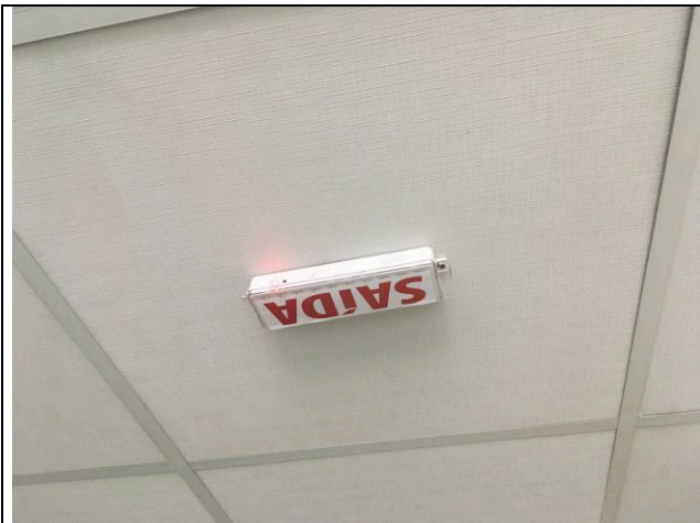
Figura 09: Luminária de emergência
