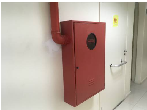
Figura 06: Abrigo de hidrante H11.
