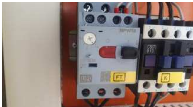
Figura 15.54 Quadros elétricos (disj térmico)
