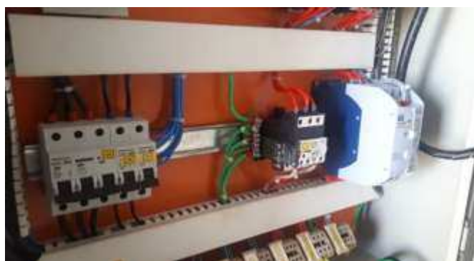
Figura 15.53 Quadros elétricos (softstarter)
