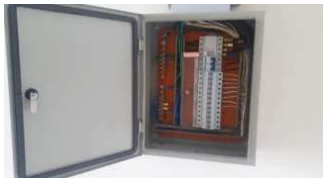
Figura 15.42 Quadros elétricos (QDC4)
