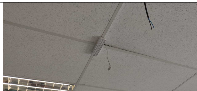
Figura 18: Bloco autônomo de iluminação de emergência 30 leds instalado.
