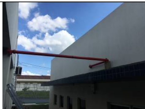
Figura 14: Tubulação aço galvanizado DN 80 mm.
