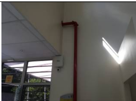
Figura 13: Tubulação aço galvanizado DN 65 mm.
