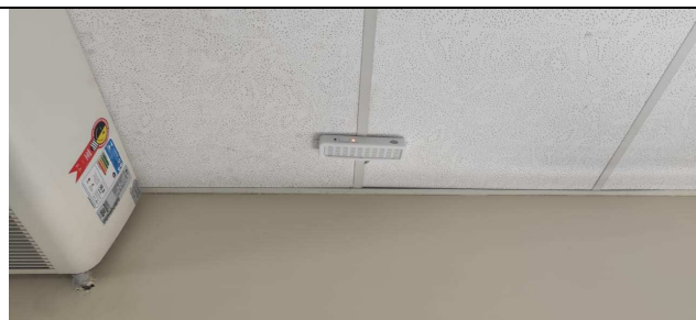
Figura 17: Bloco autônomo de iluminação de emergência 30 leds instalado.
