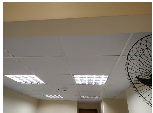
Figura 12: Detector térmico em forro de gesso monolítico
