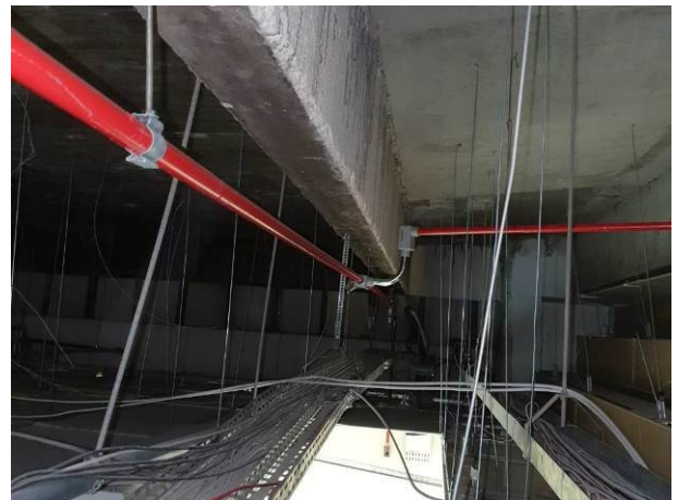
Figura 06: Infraestrutura acima do forro
