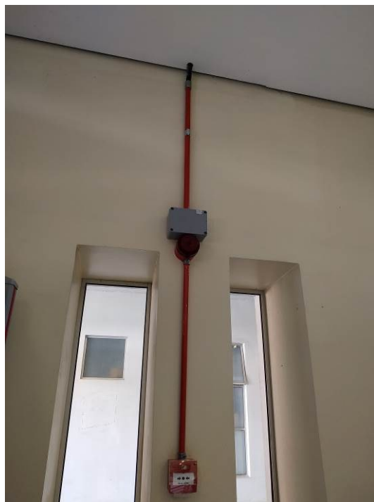
Figura 02: Infraestrutura em forro de gesso monolítico, indicador audvisual e acionador manual
