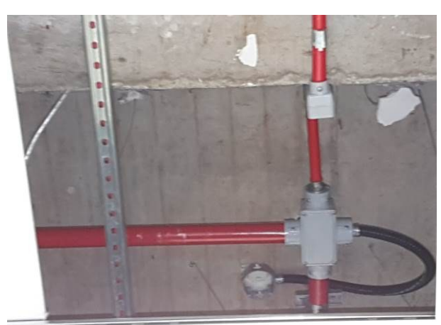
Figura 08: Infraestrutura acima do forro
