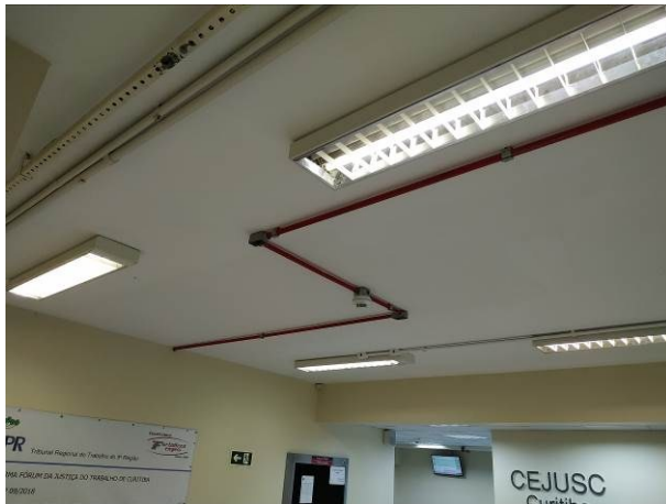
Figura 03: Infraestrutura e detector de fumaça
