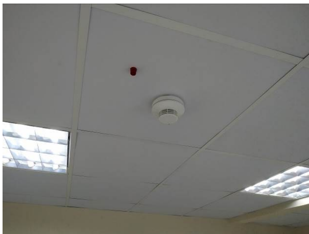
Figura 11: Detector de fumaça e sinalizador de acionamento acima do forro
