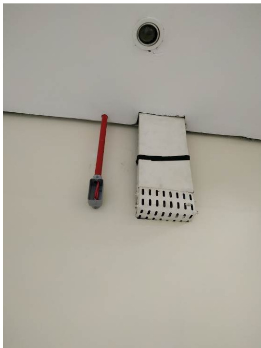
Figura 01: Infraestrutura em forro de gesso monolítico e cabeamento
