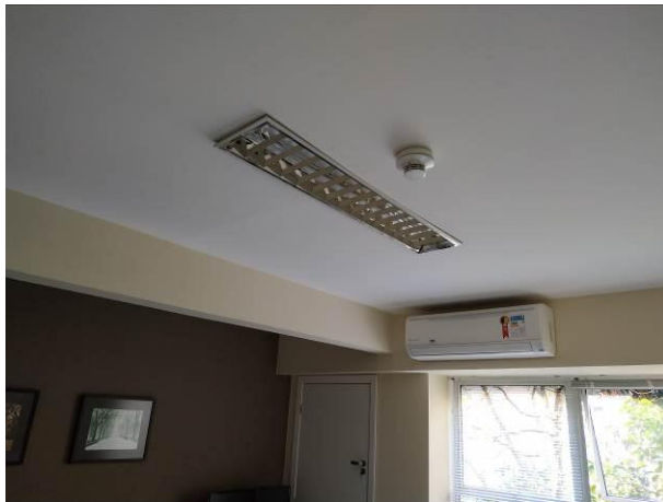
Figura 13 - Detector óptico de fumaça em forro de gesso monolítico
