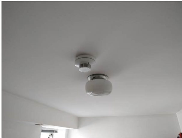
Figura 11: Detector térmico em forro de gesso monolítico
