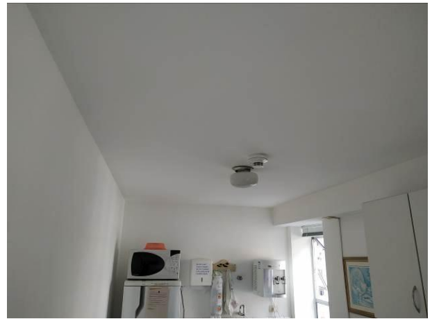
Figura 12: Detector térmico em forro de gesso monolítico
