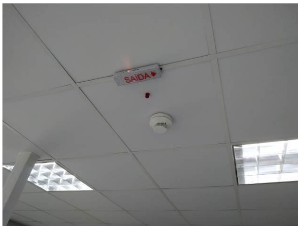
Figura 09: Detector óptico de fumaça e avisador de acionamento
