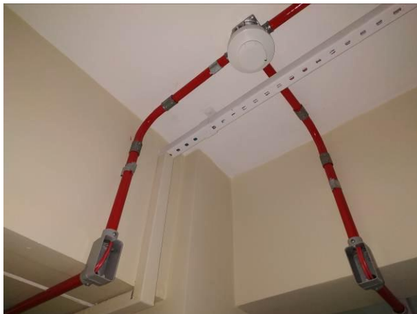
Figura 05: Infraestrutura, cabeamento e detector óptico de fumaça
