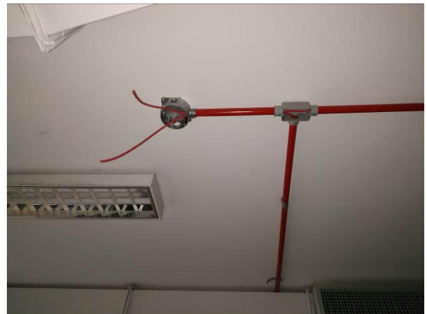
Figura 06: Infraestrutura e cabeamento
