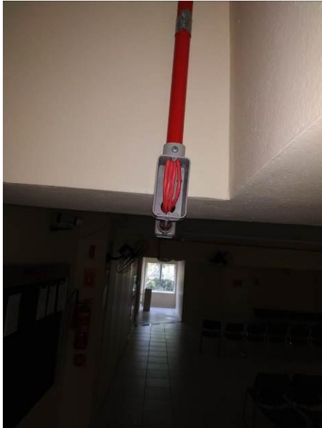
Figura 03: Infraestrutura e cabeamento
