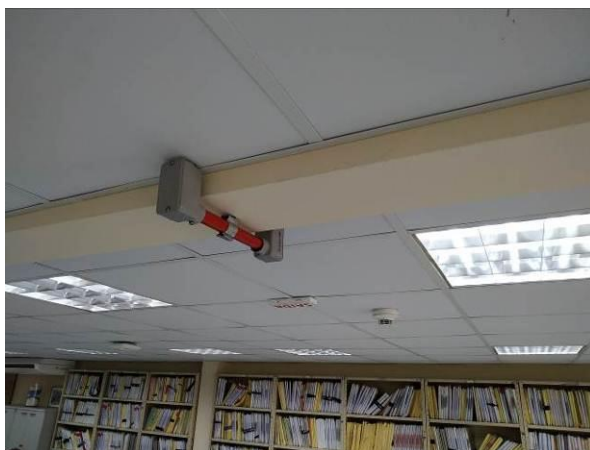
Figura 13 - Infraestrutura para transição de viga e detector óptico de fumaça
