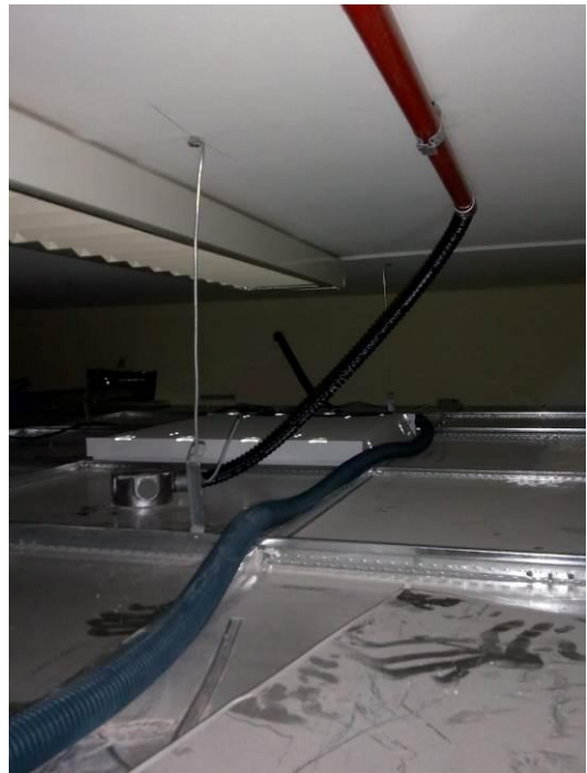
Figura 02: Infraestrutura no entreforro
