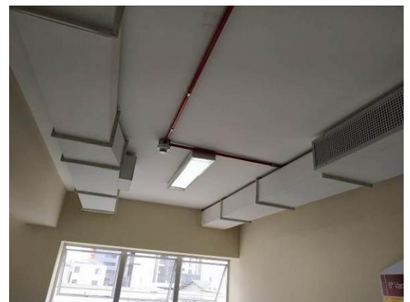
Figura 12: Infraestrutura e detector óptico de fumaça (área de espera)
