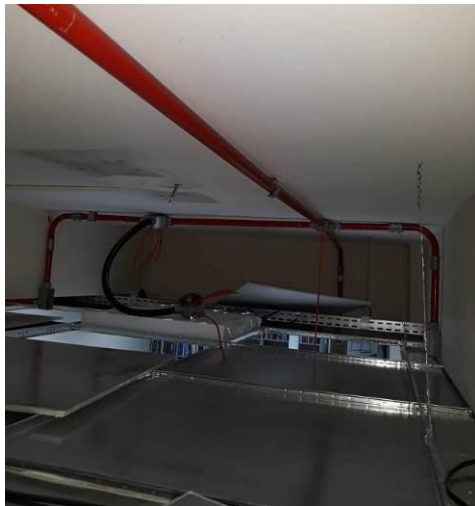
Figura 05: Infraestrutura e cabeamento (entreforro)
