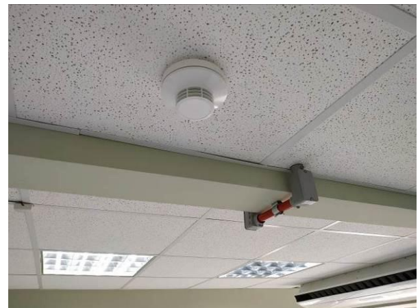
Figura 14 - Infraestrutura para transição de viga e detector óptico de fumaça
