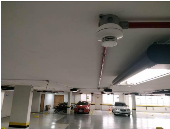
Figura 17 - Detector termovelocimétrico (garagem)
