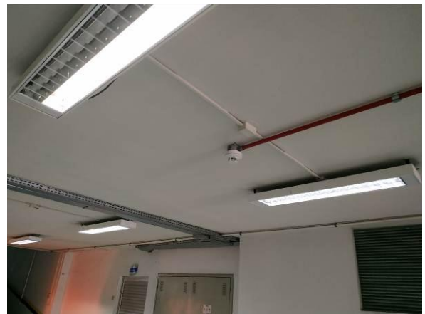
Figura 18 - Detector termovelocimétrico (garagem)
