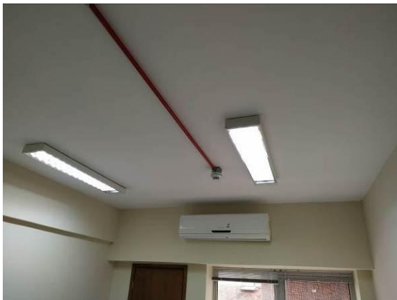
Figura 11: Infraestrutura e detector óptico de fumaça (sala de audiências)
