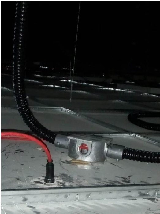
Figura 01: Infraestrutura e cabeamento (entreforro)
