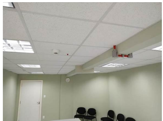
Figura 16 - Infraestrutura de transição de viga e detector óptico de fumaça
