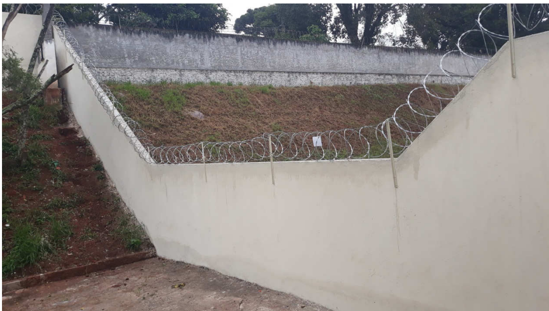
Figuras 22 - Pinturas nos muros externos.
