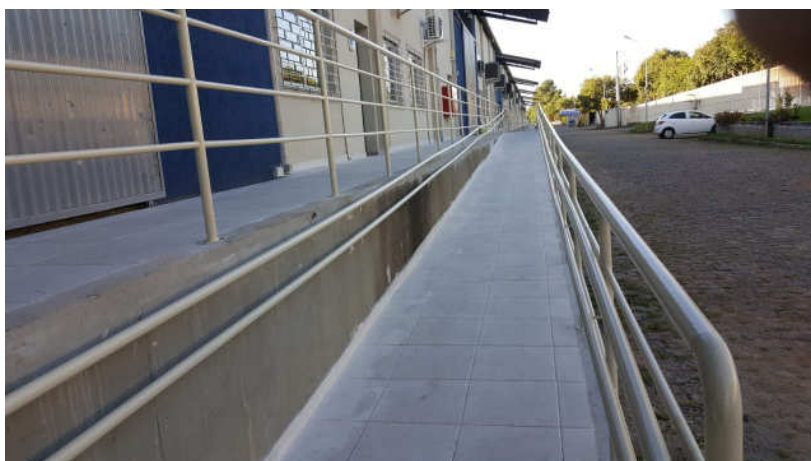
Figura 20 - Pintura nos guarda corpos.
