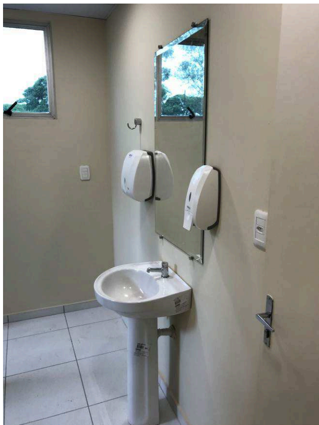
Figura 49C: Lavatório e acessórios - VESTIÁRIO FEMININO.
