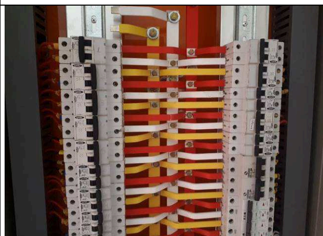
Figura 74C: Instalações elétricas - quadro elétrico QDFL3 - Setorial
