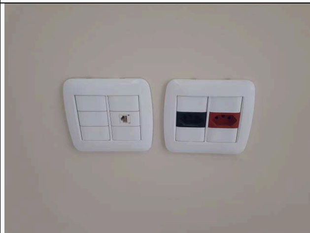
Figura 62C: Instalações elétricas e cabeamento - CEJUSC
