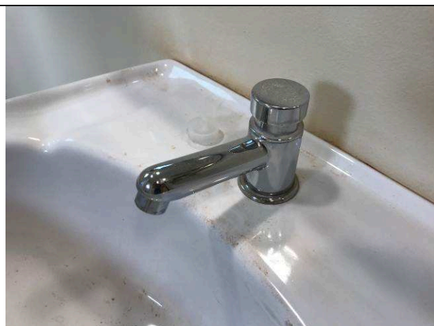
Figura 51C: Torneira com fechamento automático - VESTIÁRIO FEMININO.
