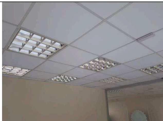
Figura 67C: Instalações elétricas - iluminação - CEJUSC
