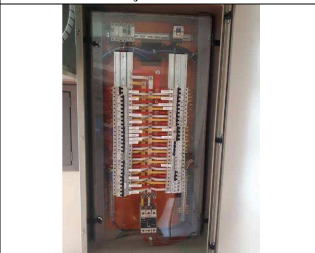
Figura 72C: Instalações elétricas - quadro elétrico QDFL3 - Setorial
