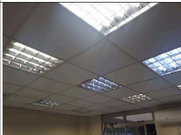
Figura 66C: Instalações elétricas - iluminação - CEJUSC
