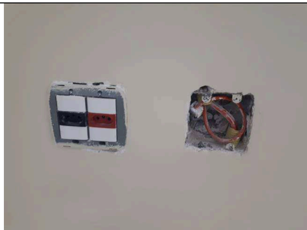
Figura 61C: Instalações elétricas e cabeamento - CEJUSC
