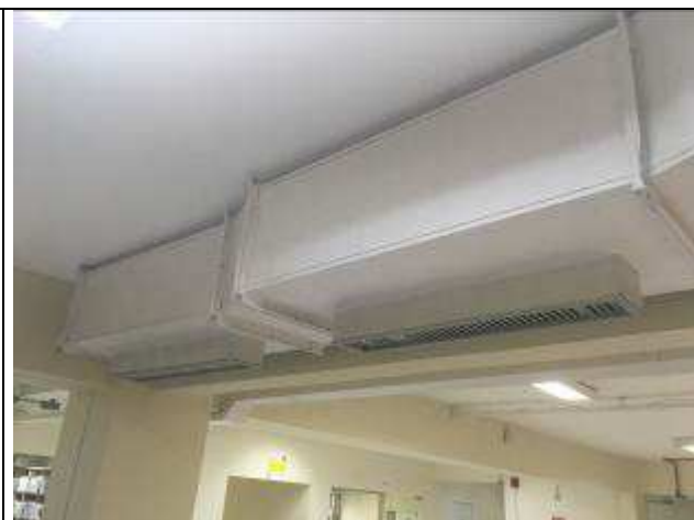
Figura 46C - dutos insuflamento e exaustão - hall 13ª e 15ª VTs
