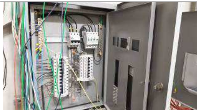
Figura 03E - quadro elétrico comum 16ª VT
