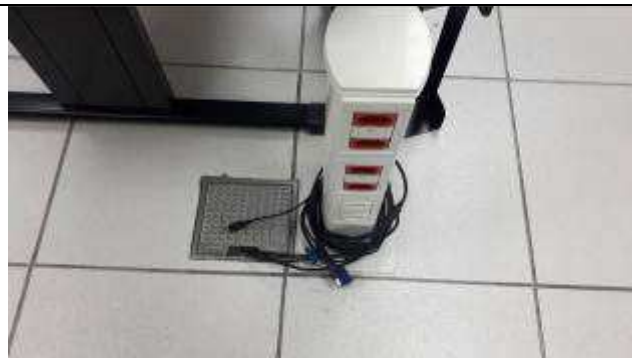
Figura 11E - instalações elétricas e lógicas 14ª VT
