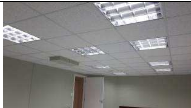
Figura 26E - iluminação 15ª VT
