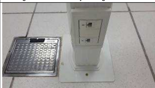
Figura 22E - caixas de piso 13ª VT
