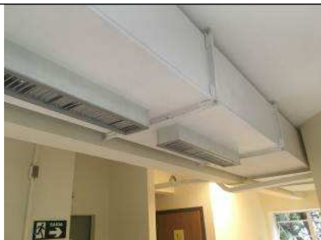
Figura 45C - dutos insuflamento e exaustão - hall 13ª e 15ª VTs
