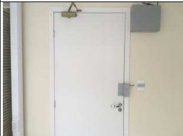
Figura 14C - pintura portas - 14ª VT
