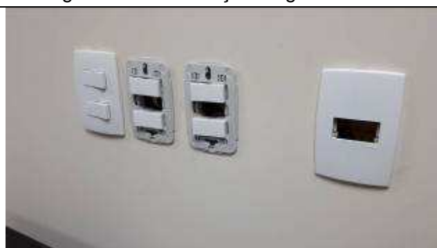
Figura 21E - interruptores 13ª VT
