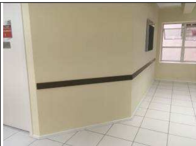
Figura 40C - protetores reinstalados - 15ª VT
