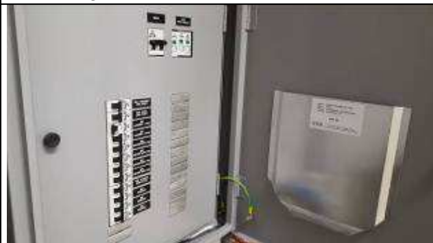
Figura 04E - quadro elétrico estabilizado 16ª VT
