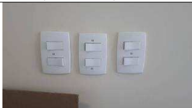
Figura 09E - instalações elétricas 14ª VT
