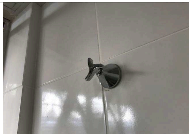
Figura 15C: Registro da válvula de descarga - BWC PNE público masculino.
