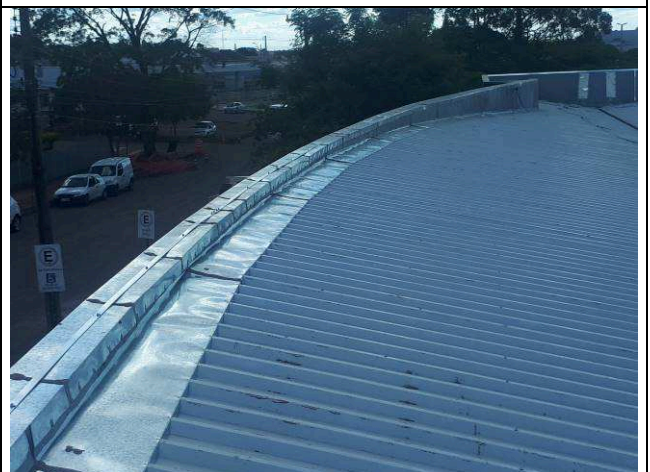
Figura 22E: SPDA edificação principal
