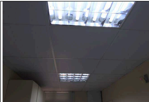
Figura 35C: Forro da copa localizada em frente à Distribuição.
