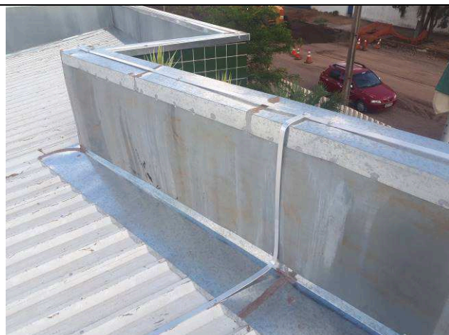
Figura 21E: SPDA edificação principal
