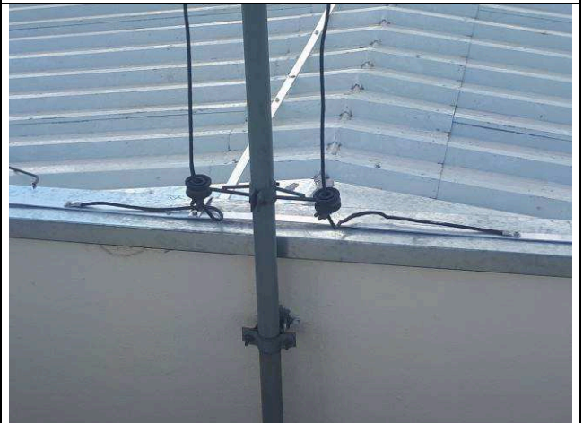
Figura 20E: SPDA edificação principal
