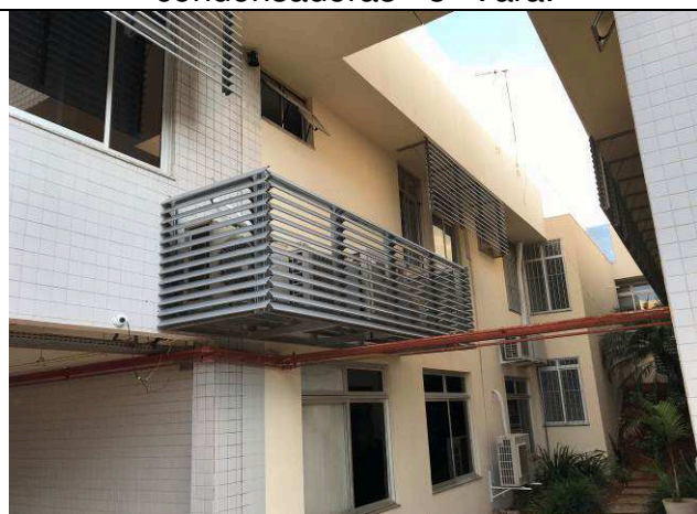
Figura 51C: Estrutura de apoio das condensadoras - 4ª Vara e site.
