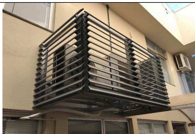
Figura 43C: Estrutura de apoio das condensadoras - Auditório e Distribuição.
