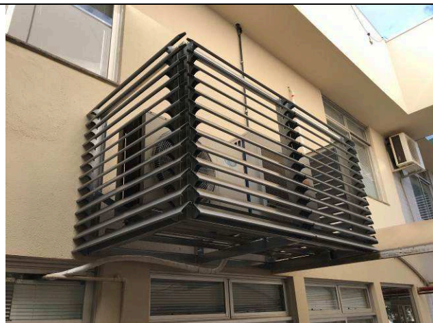
Figura 107C: Rede frigorígena nova e condensadoras - Auditório e Distribuição.
