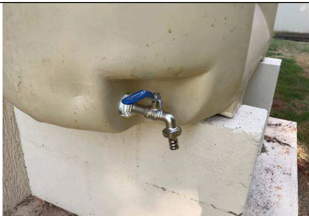
Figura 07C: Torneira de pressão - reservatório de águas pluviais.
