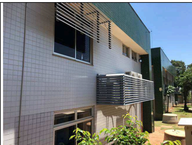
Figura 48C: Estrutura de apoio das condensadoras - 1ª Vara.
