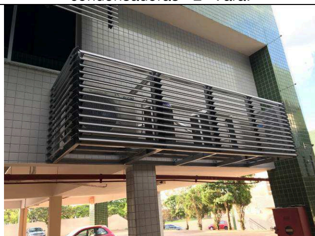
Figura 55C: Estrutura de apoio das condensadoras - 4ª Vara.
