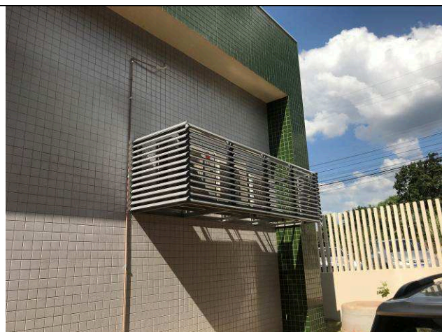
Figura 47C: Estrutura de apoio das condensadoras - 3ª Vara.
