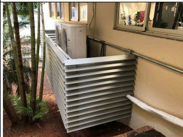
Figura 50C: Estrutura de apoio das condensadoras - 1ª Vara.
