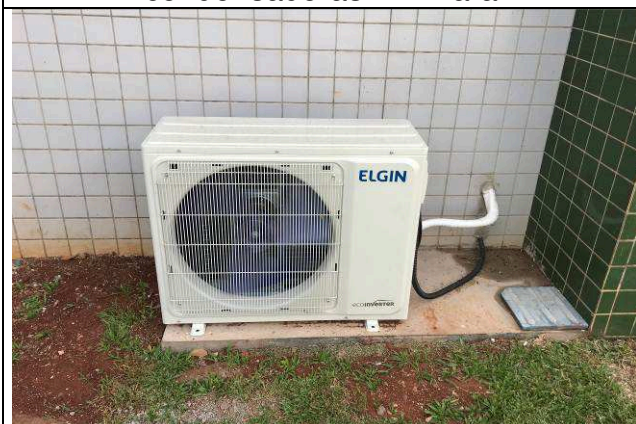
Figura 105C: Rede frigorígena nova e condensadora - sala Nobreak.
