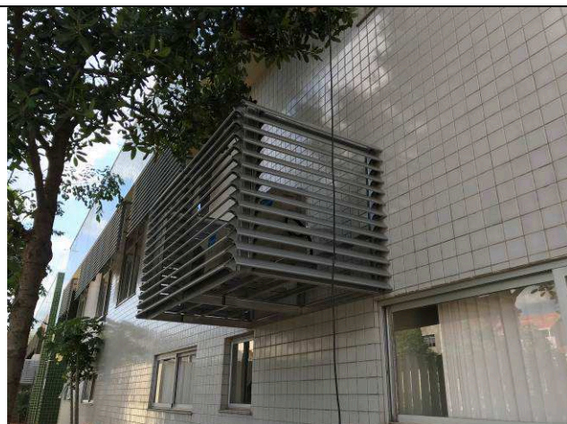
Figura 49C: Estrutura de apoio das condensadoras - 3ª Vara.
