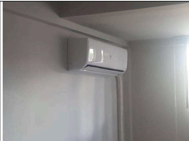
Figura 01E: ar condicionado sala site
