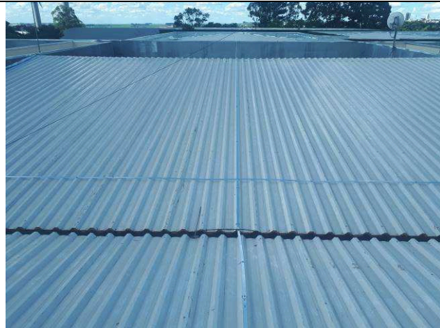
Figura 23E: SPDA edificação principal
