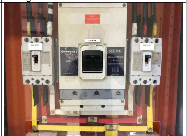
Figura 06E: instalações elétricas QDG
