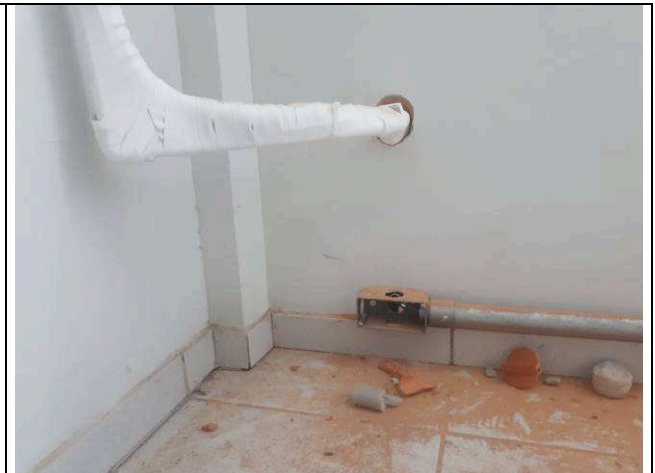
Figura 02E: ar condicionado sala site
