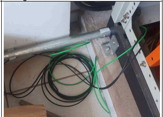
Figura 04E: ar condicionado sala site
