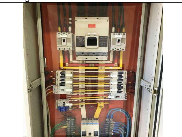
Figura 05E: instalações elétricas QDG
