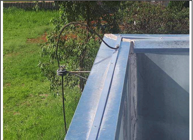
Figura 24E: SPDA edificação principal
