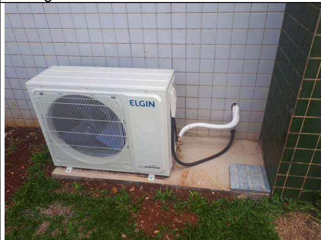
Figura 03E: ar condicionado sala site
