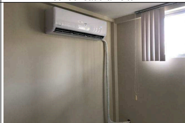
Figura 106C: Rede frigorígena nova e evaporadora - sala Nobreak.
