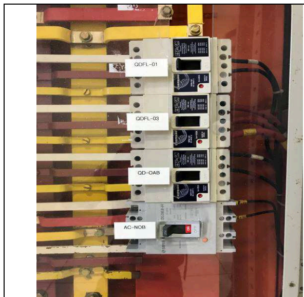
Figura 07E: instalações elétricas QDG
