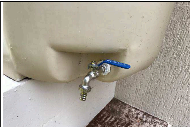
Figura 08C: Torneira de pressão - reservatório de águas pluviais.
