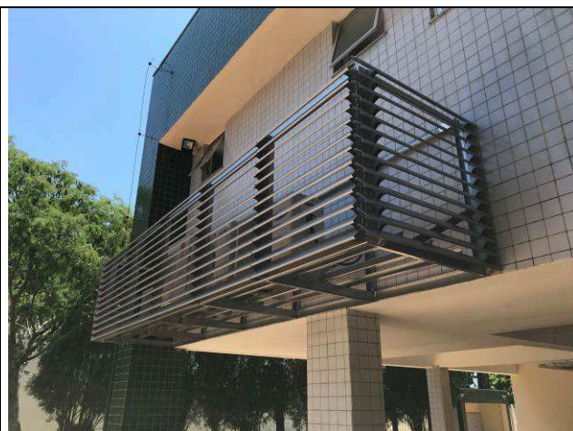
Figura 54C: Estrutura de apoio das condensadoras - 3ª Vara.
