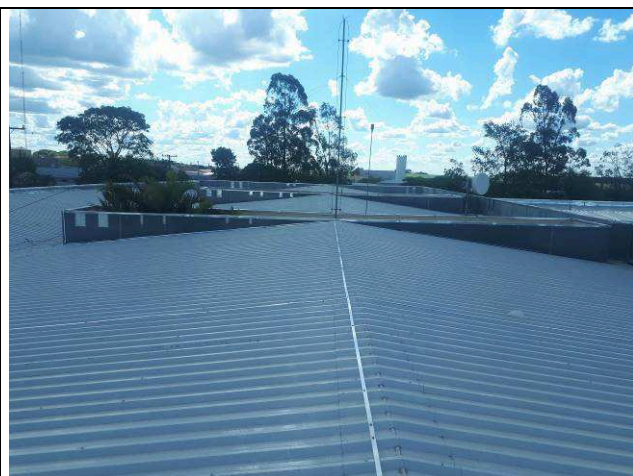
Figura 15E: SPDA edificação principal
