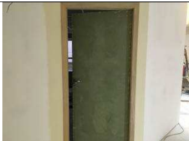
Figura 31C - Porta acústica - sala de audiências - 15ª VT
