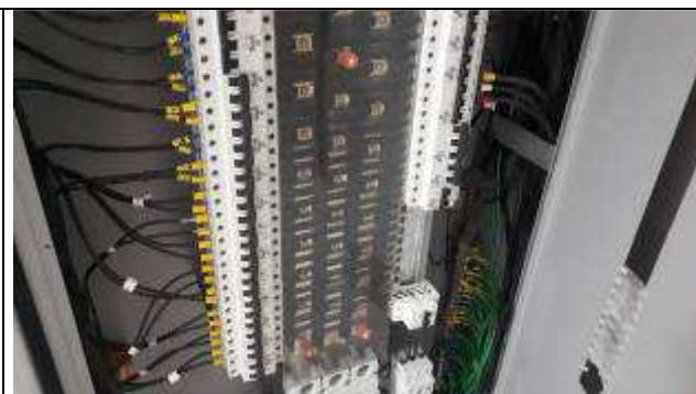
Figura 34E: instalações frente VM400
