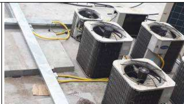
Figura 32E: instalações frente VM400
