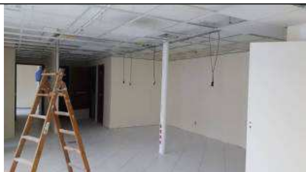
Figura 05E - infraestrutura e colunas técnicas 14ª VT
