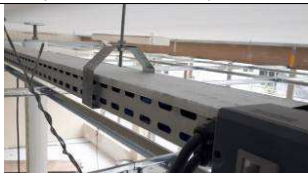
Figura 03E - infraestrutura e colunas técnicas 14ª VT
