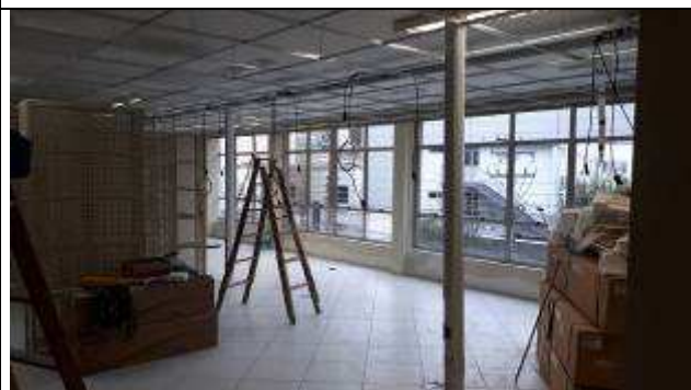
Figura 06E - infraestrutura e colunas técnicas 14ª VT
