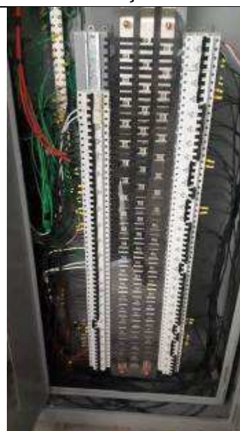
Figura 36E: instalações lateral direita VM362
