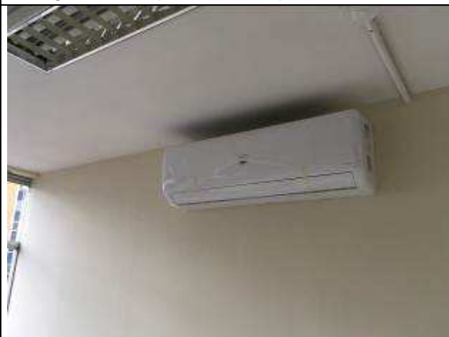
Figura 20C - Equipamentos SPLIT - Gabinete Juiz - 14ª VT
