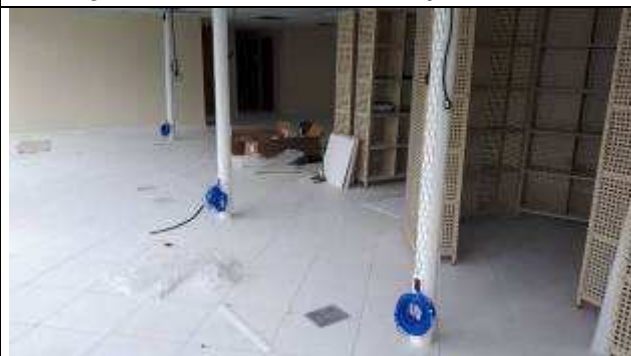
Figura 04E - infraestrutura e colunas técnicas 14ª VT
