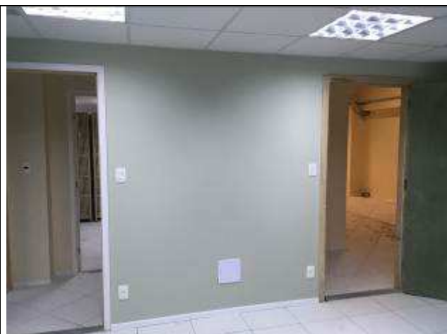
Figura 10C - paredes de gesso acartonado - 14ª VT
