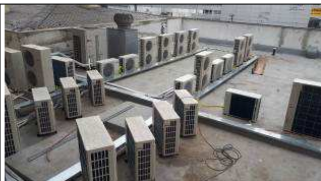
Figura 31E: instalações frente VM400
