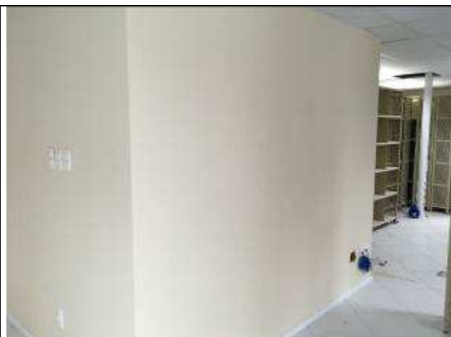
Figura 9C - paredes de gesso acartonado - 14ª VT
