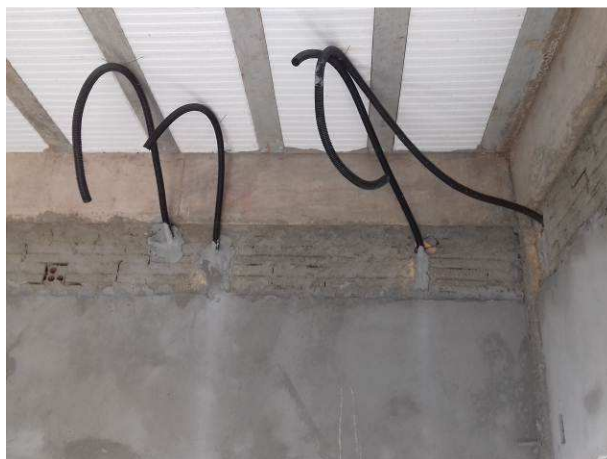
Figura 06E: Eletroduto corrugado de 32mm - infraestrutura interna - Audiência 2
