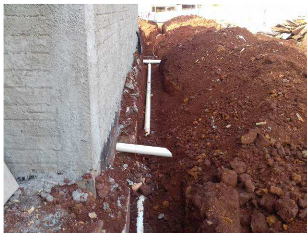
Figura 92C: Tubos de esgoto de 100mm (lateral direita)
