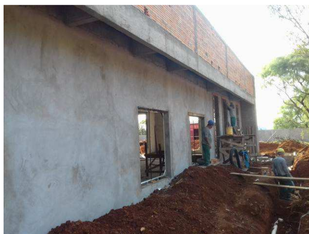
Figura 59C: Rebôco aplicado na fachada frontal - OAB, Perícia e Arquivo
