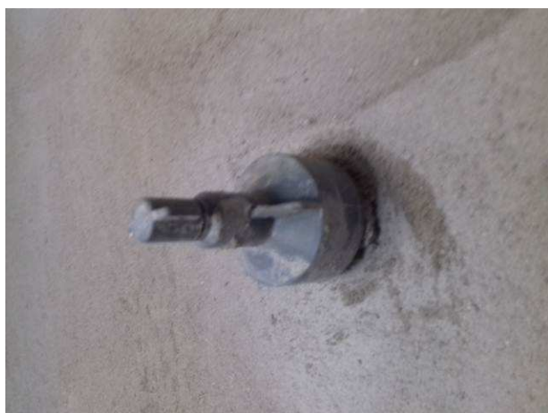
Figura 72C: Registro de gaveta de 3/4", instalado em BWC público
