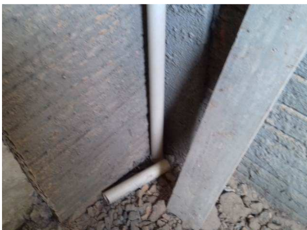
Figura 78C: Tubulação de ventilação - BWC da secretaria
