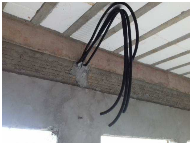
Figura 03E: Eletroduto corrugado de 32mm - infraestrutura interna - secretaria
