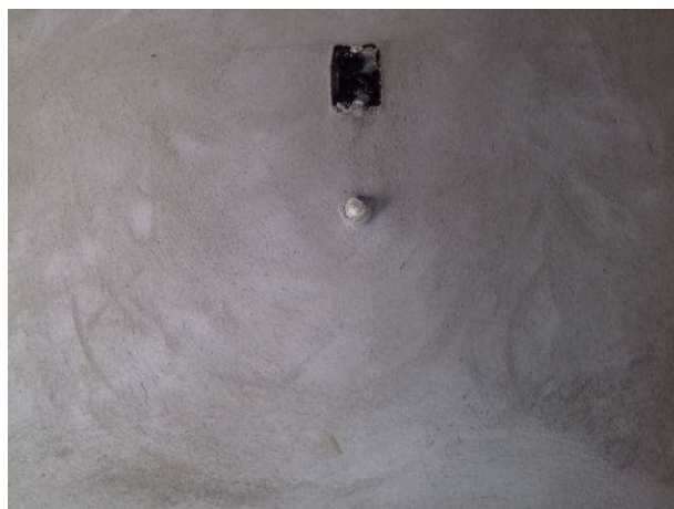
Figura 69C: Ponto de água fria (3/4"), para instalação de chuveiro - Terceirizados
