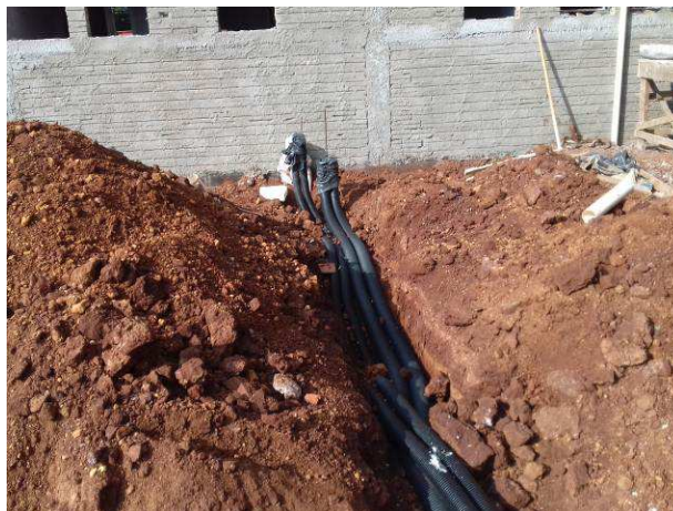
Figura 02E: Tubulação PEAD de 40mm e 100mm atravessando a lateral direita para alcançar a sala técnica, a partir da parte frontal
