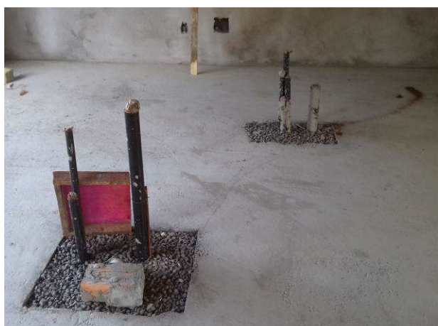
Figura 09E: Eletroduto de 60mm - utilizado na sala de audiência 1
