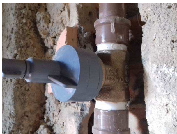
Figura 73C: Registro de gaveta de 3/4", instalado em BWC da secretaria (masculino)
