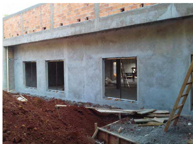
Figura 58C: Rebôco aplicado na fachada frontal - Sala de audiência e sala de testemunhas
