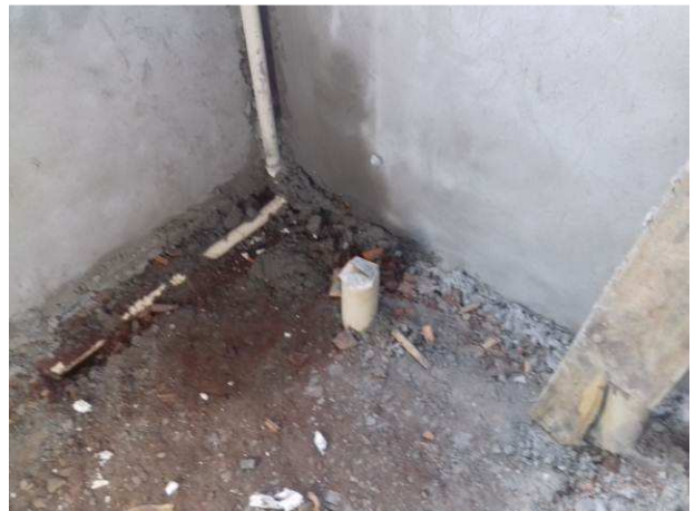
Figura 77C: Tubulação de ventilação - BWC público
