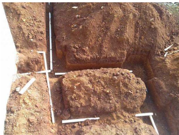
Figura 91C: Tubos de drenagem pluvial e esgoto de 100mm (lateral direita)
