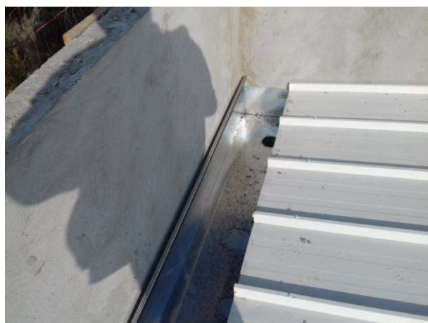
Figura 38C: Final de calha com ponto de coleta pluvial
