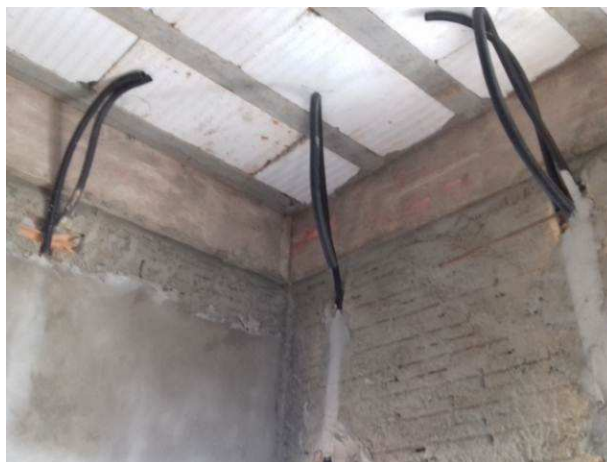
Figura 04E: Eletroduto corrugado de 32mm - infraestrutura interna - sala técnica
