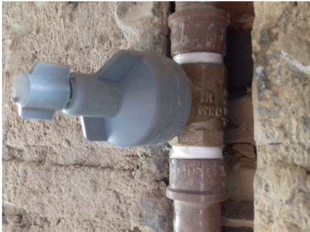
Figura 74C: Registro de gaveta de 3/4", instalado em BWC da secretaria (feminino)
