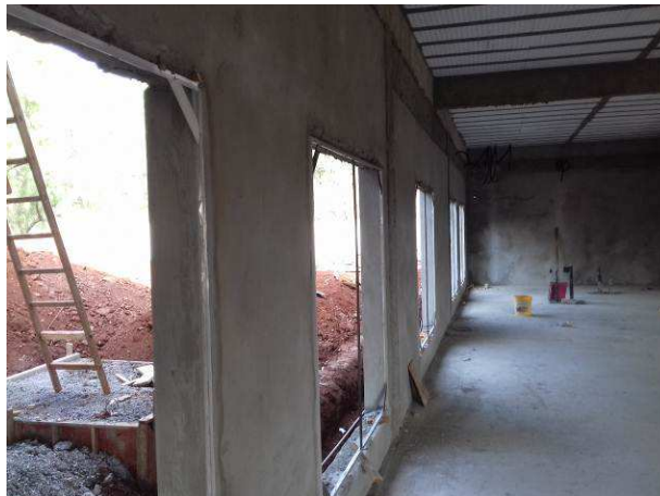
Figura 16C: Requadro e contramarcos nas janelas das salas de audiência, testemunhas e conciliação
