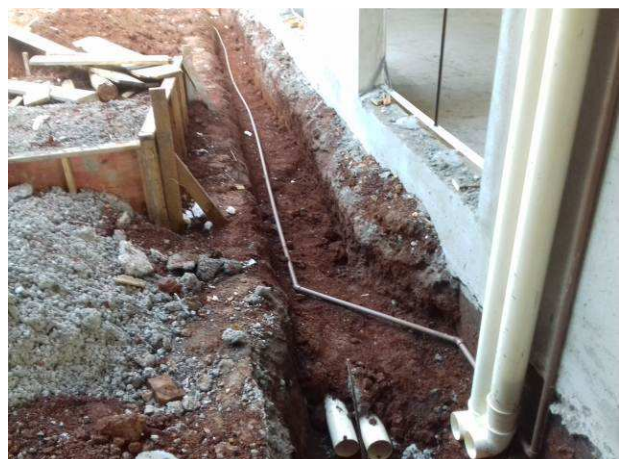
Figura 79C: Rede de água fria de 3/4" (25mm) - PVC marrom, proveniente da rede externa, alimentando os reservatórios
