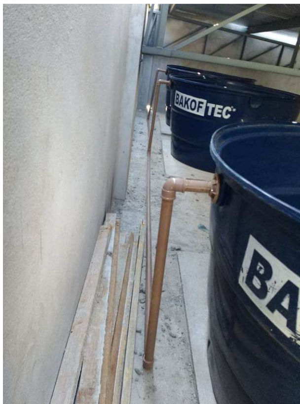
Figura 87C: Tubulação dos extravasores dos reservatórios
