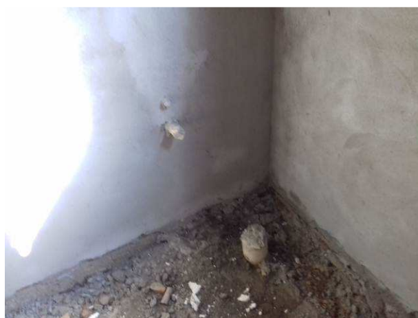
Figura 71C: Pontos de água fria (3/4") e ponto de esgoto primário - BWC público Feminino
