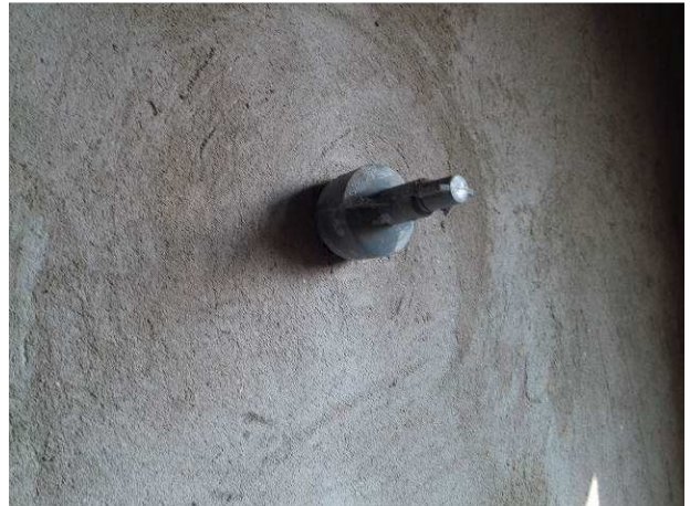
Figura 75C: Registro de pressão de 3/4", instalado em BWC dos terceirizados
