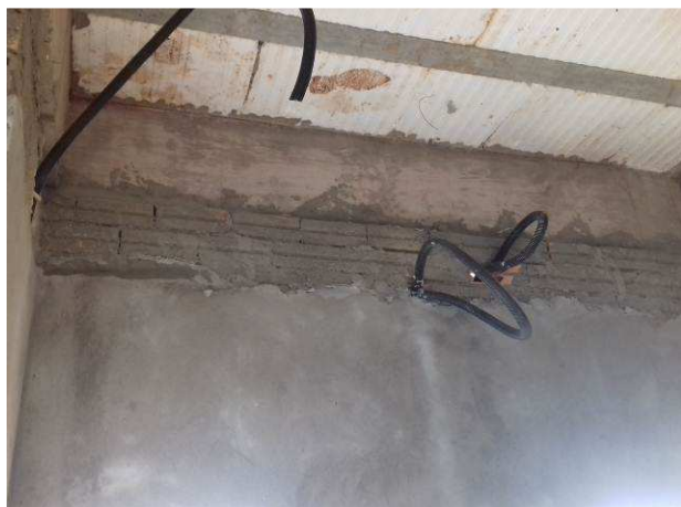
Figura 05E: Eletroduto corrugado de 32mm - infraestrutura interna - copa
