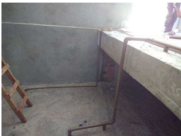
Figura 84C: Rede de água-fria proveniente dos reservatórios - Distribuição
