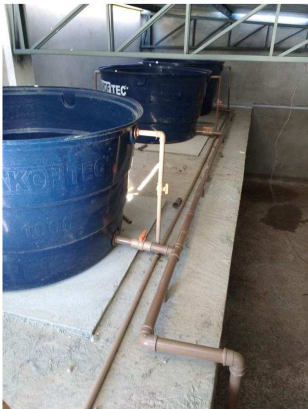
Figura 86C: Registros de esfera instalados junto aos reservatórios
