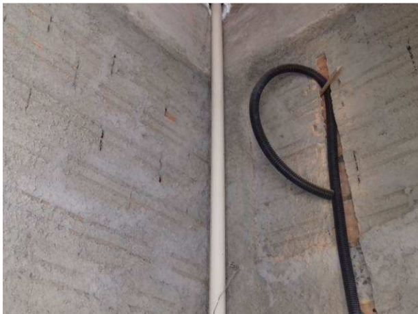
Figura 76C: Tubulação de ventilação - BWC do Juiz Auxiliar
