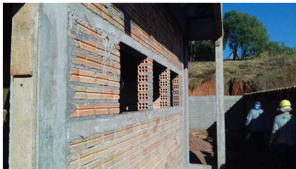
Figura 04C: Vergas e contravergas em janelas da copa - fundos do imóvel
