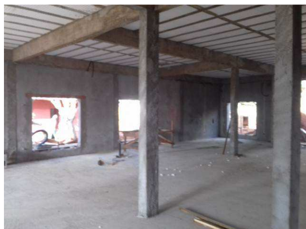
Figura 64C: Contrapiso executado - Perícia, OAB e PAB
