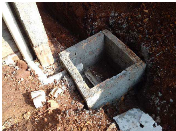
Figura 99C: Caixa de inspeção (pluvial) executada nos fundos do imóvel
