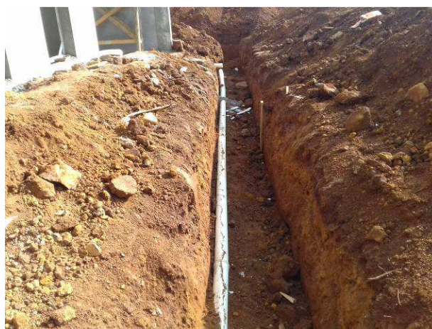
Figura 94C: Tubos de esgoto de 100mm (lateral esquerda)
