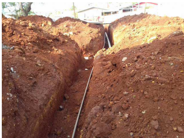
Figura 80C: Rede de água fria de 3/4" (25mm) - PVC marrom, proveniente da rede externa, alimentando os reservatórios
