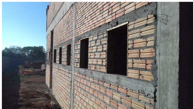
Figura 03C: Vergas e contravergas em janelas de sanitários - fundos do imóvel
