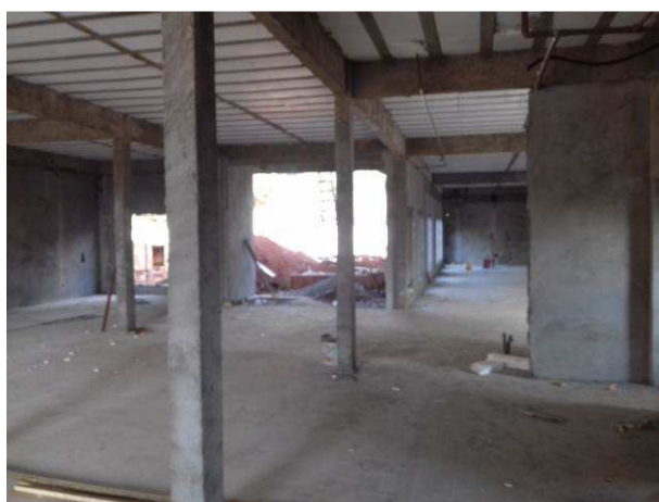
Figura 47C: Rebôco executado na região do arquivo
