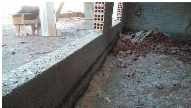
Figura 07C: Vergas e contravergas em janelas da sala de audiência - frente do imóvel
