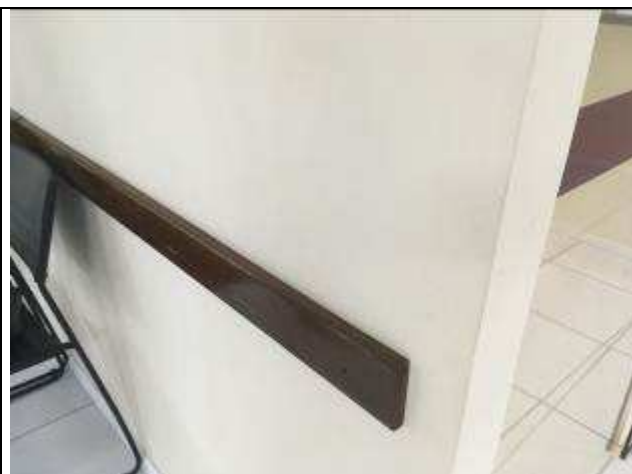
Figura 06C - protetores de parede - 17ª/18ª VTs
