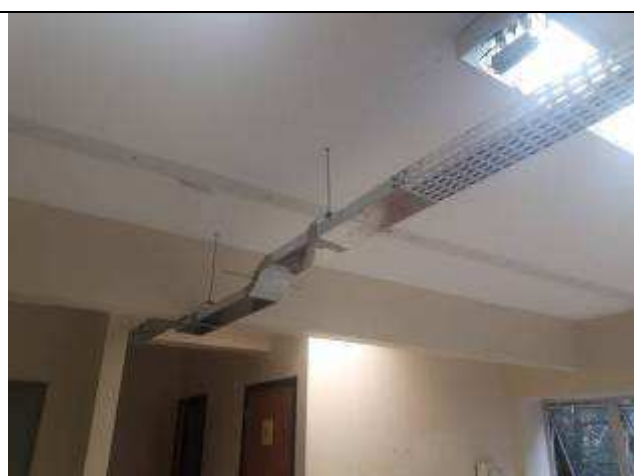
Figura 17E - infraestrutura, condutes, cabeamento 13ª e 15ª VT
