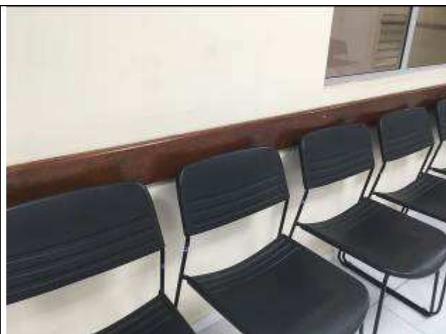
Figura 05C - protetores de parede - 17ª/18ª VTs
