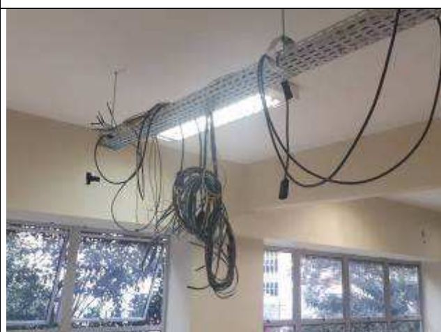
Figura 18E - infraestrutura, condutes, cabeamento 13ª e 15ª VT
