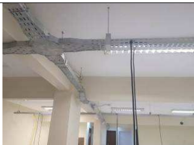
Figura 15E - infraestrutura, condutes, cabeamento 13ª e 15ª VT
