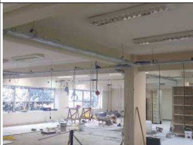
Figura 16E - infraestrutura, condutes, cabeamento 13ª e 15ª VT
