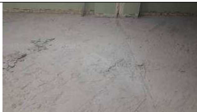
Figura 11E - rasgo em piso sala de audiências
