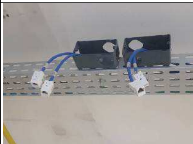
Figura 08E - infraestrutura, condutes, cabeamento, pontos lógicos 14ª VT
