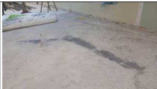
Figura 12E - rasgo em piso sala de audiências
