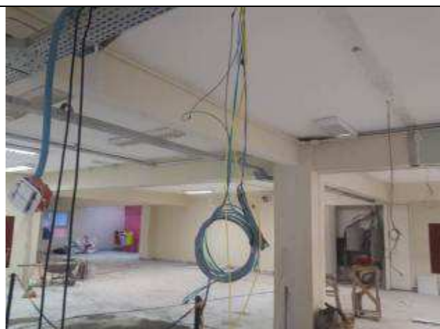
Figura 21E - infraestrutura, condutores, cabeamento 13ª e 15ª VT
