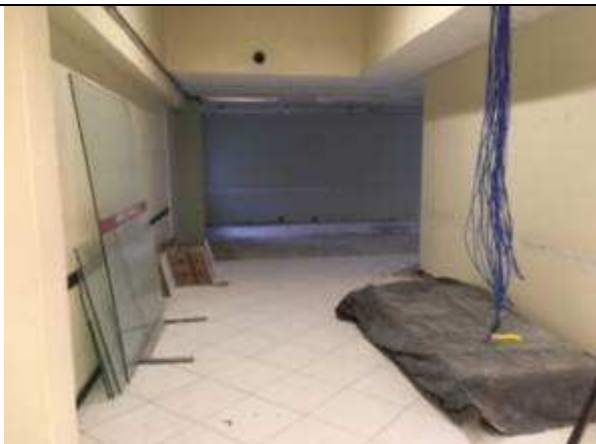
Figura 10C - retirada portas de vidro - 14ª VT
