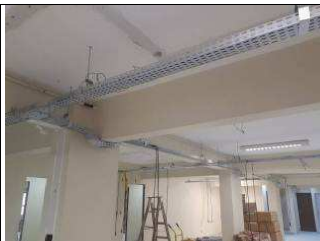
Figura 14E - infraestrutura, condutes, cabeamento 13ª e 15ª VT
