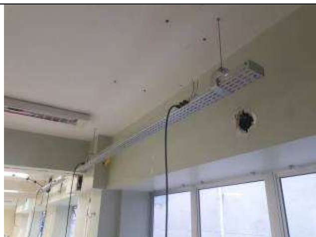
Figura 13E - infraestrutura, condutes, cabeamento 13ª e 15ª VT
