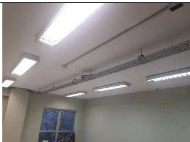
Figura 07E - infraestrutura, condutes, cabeamento, pontos lógicos 14ª VT
