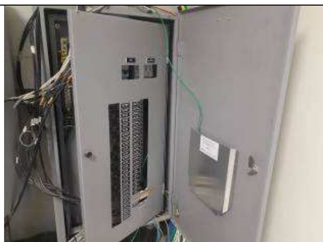
Figura 23E - Quadro QDC1A
