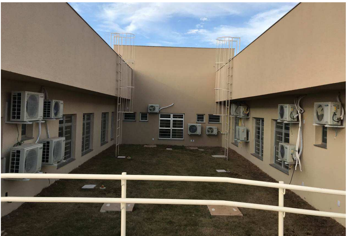
Figura 3 – Fórum - Vista externa - Condensadoras dos equipamentos split.
