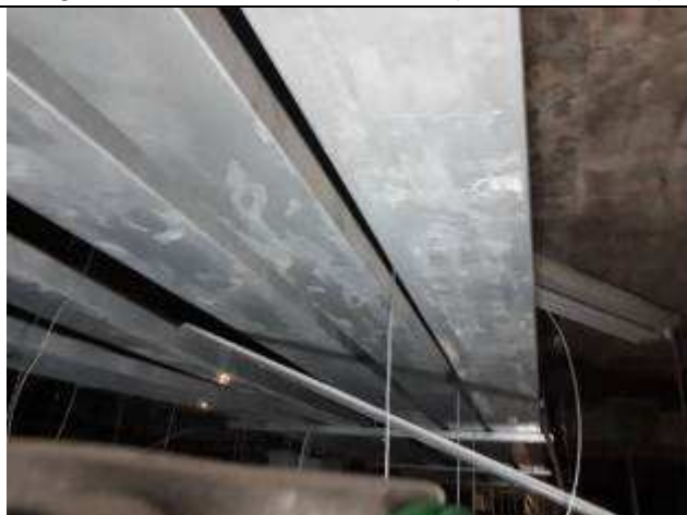
Figura 41E: infraestrutura ar corredor lateral VM362
