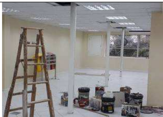
Figura 03E: colunas técnicas, iluminação - 12ª VT
