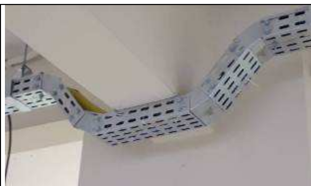
Figura 14E: eletrocalhas tampadas
