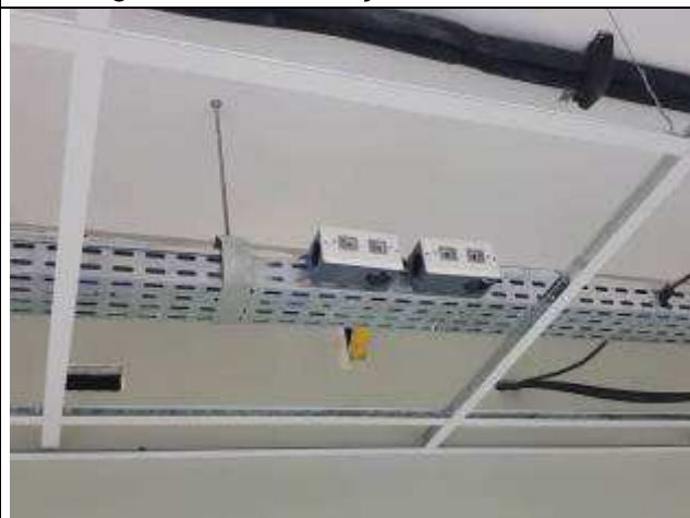
Figura 31E: cabeamento estruturado 10ª e 11ª VT
