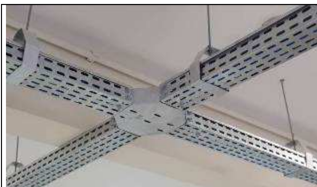
Figura 13E: eletrocalhas tampadas
