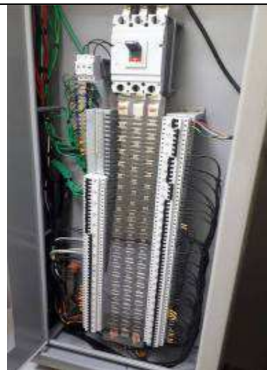
Figura 38E: Quadro QD-AR3 (lateral VM362)
