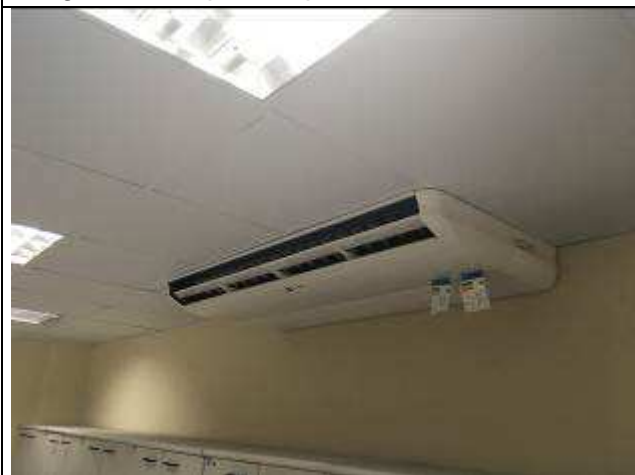
Figura 17C - equipamentos SPLIT - 12ª VT
