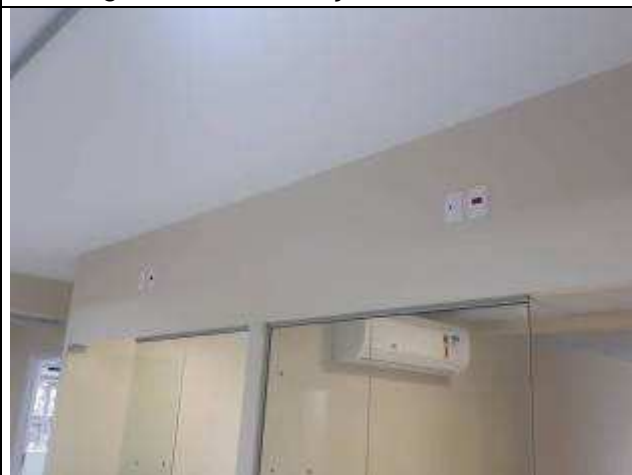
Figura 32E: cabeamento estruturado - pontos TV 10ª e 11ª VT
