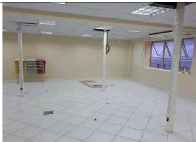
Figura 05E: colunas técnicas, iluminação - 12ª VT
