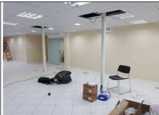
Figura 02E: cabos lógicos, colunas técnicas, iluminação - 12ª VT
