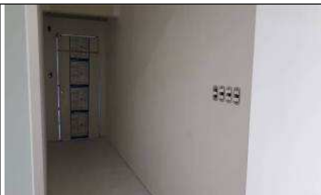
Figura 17E: interruptores e tomadas 10ª e 11ª VT
