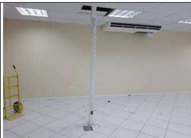
Figura 04E: colunas técnicas, iluminação - 12ª VT
