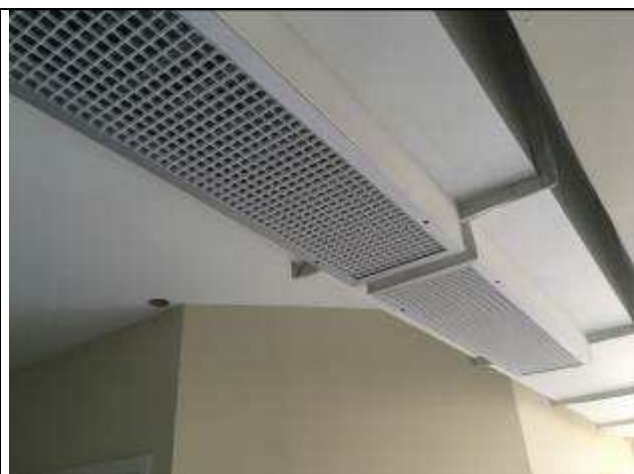
Figura 51C - grelhas de ventilação/exaustão
