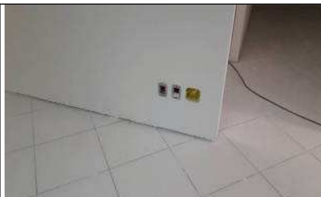
Figura 18E: interruptores e tomadas 10ª e 11ª VT
