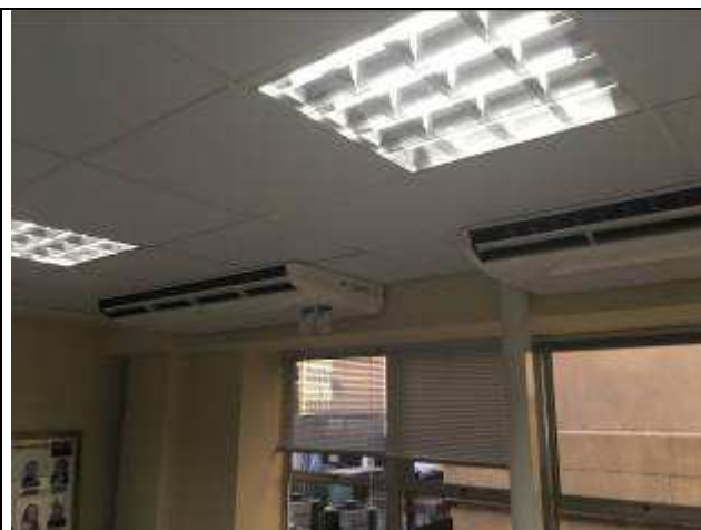
Figura 49C - equipamentos SPLIT - 11ª VT
