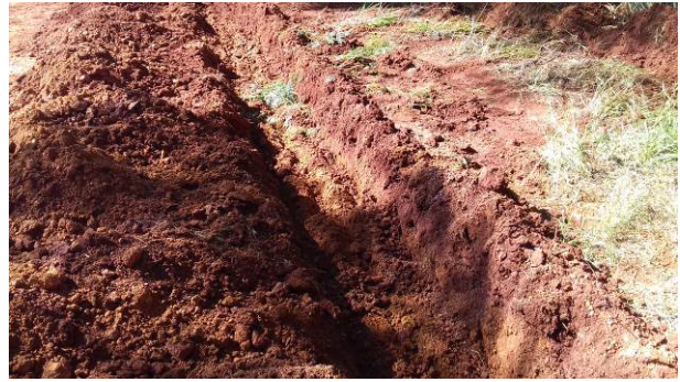
Figura 28C: Abertura de vala para execução de fôrmas da viga baldrame do muro
