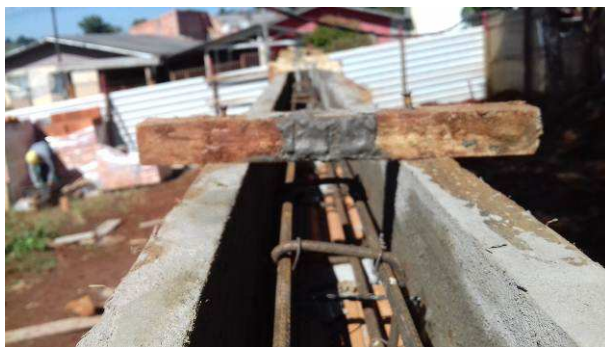
Figura 36C: No detalhe, fôrma e armaduras da viga cinta de coroamento do muro
