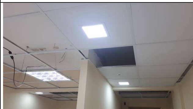
Figura 12E: luminárias 4x10W com aletas e plafons LED - 4a e 5a VT
