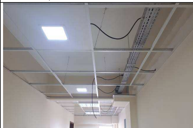
Figura 14E: luminárias 4x10W com aletas e plafons LED - 4a e 5a VT
