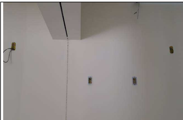
Figura 15E: infraestrutura interna e cabeamento som 4a e 5a VT
