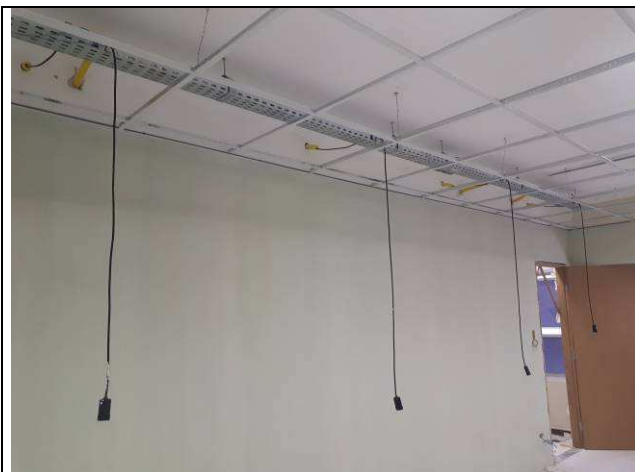
Figura 25E: infraestrutura interna, cabeamento 7a e 8a VT
