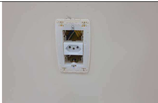
Figura 05E: interruptores, tomadas elétricas, cabeamento elétrico 4a e 5a VT
