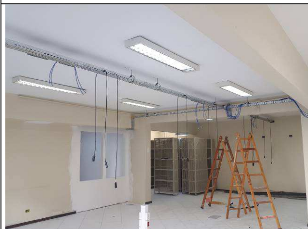
Figura 27E: infraestrutura interna, cabeamento 7a e 8a VT
