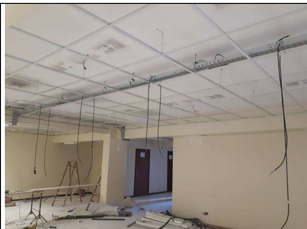
Figura 26E: infraestrutura interna, cabeamento 7a e 8a VT
