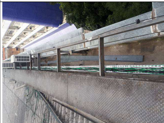
Figura 40E: cabeamento elétrico alimentação aparelhos ar - cobertura VM362
