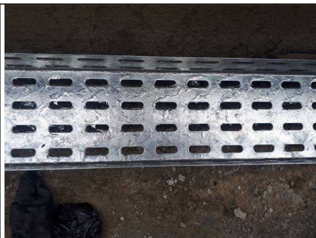
Figura 38E: infraestrutura de eletrocalhas - cobertura VM362
