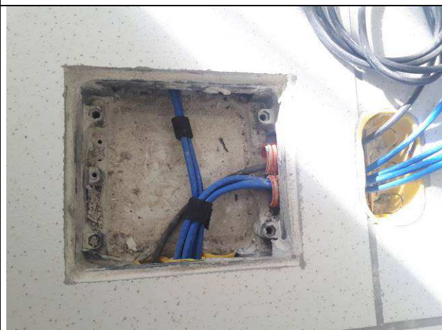
Figura 18E: cabeamento UTP cat6 4a e 5a VT
