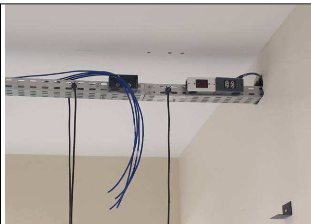
Figura 30E: infraestrutura interna, cabeamento, tomadas - 7a e 8a VT
