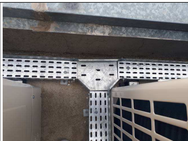
Figura 37E: infraestrutura de eletrocalhas - cobertura VM362
