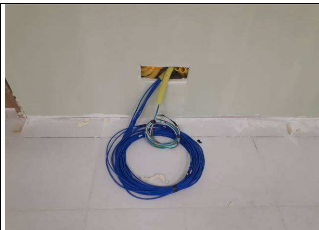
Figura 32E: cabeamento UTP cat6 - 7a e 8a VT
