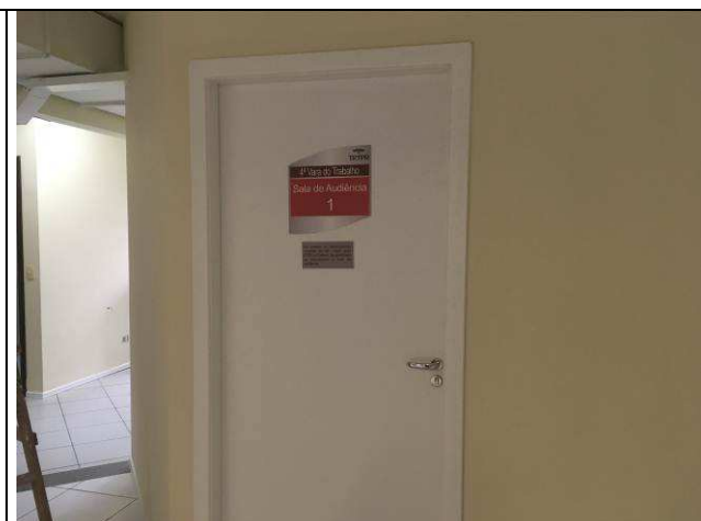
Figura 02C - portas acústicas instaladas
