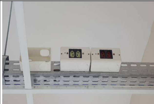
Figura 04E: interruptores, tomadas elétricas, cabeamento elétrico 4a e 5a VT
