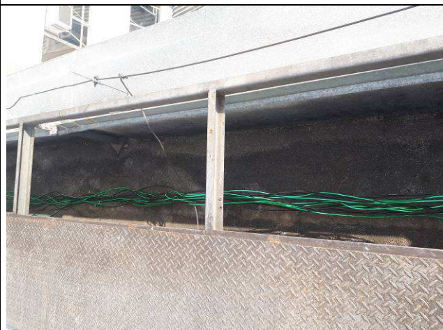
Figura 39E: cabeamento elétrico alimentação aparelhos ar - cobertura VM362
