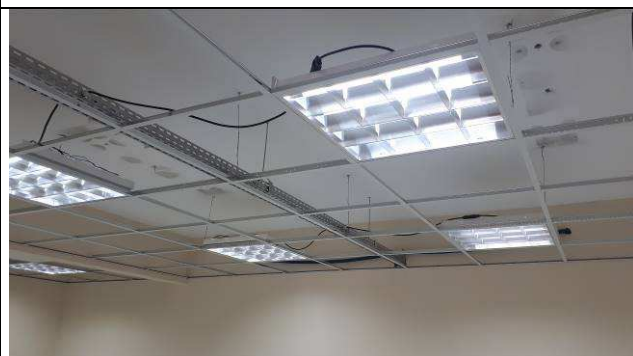
Figura 11E: luminárias 4x10W com aletas e plafons LED - 4a e 5a VT
