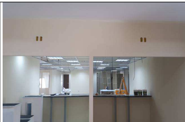
Figura 16E: infraestrutura interna e cabeamento TV 4a e 5a VT
