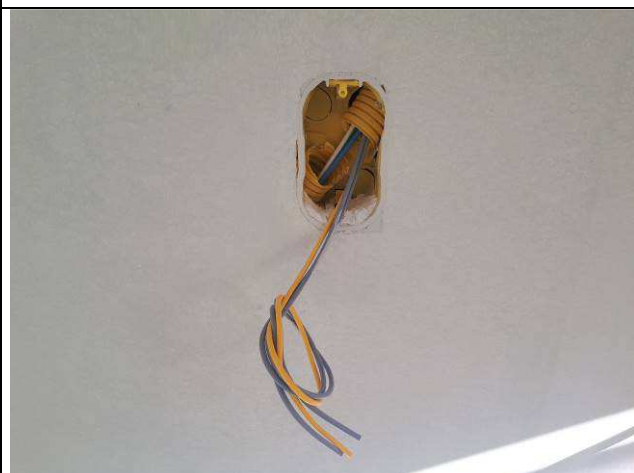
Figura 28E: infraestrutura interna, cabeamento 7a e 8a VT
