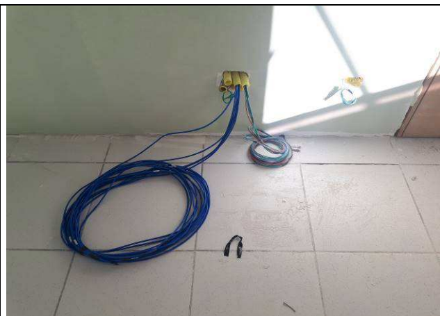
Figura 31E: cabeamento UTP cat6 - 7a e 8a VT
