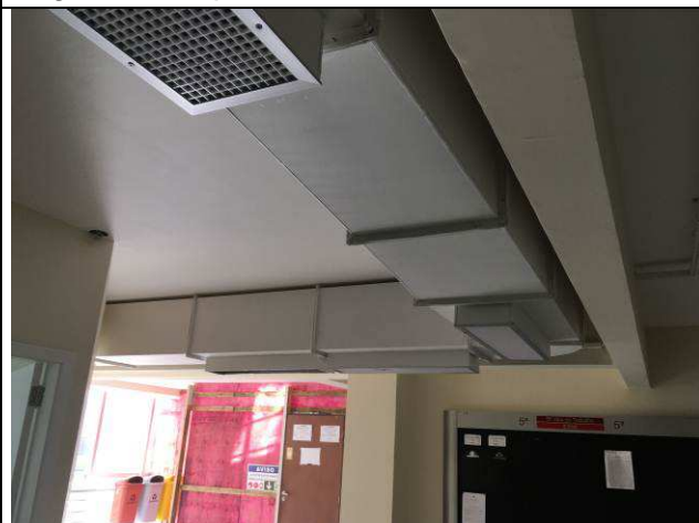
Figura 12C - Dutos de insuflamento e exaustão instalados.
