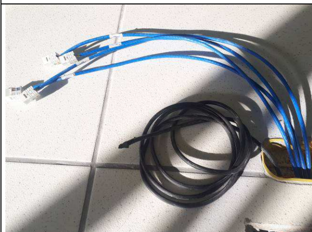
Figura 17E: cabeamento UTP cat6 4a e 5a VT
