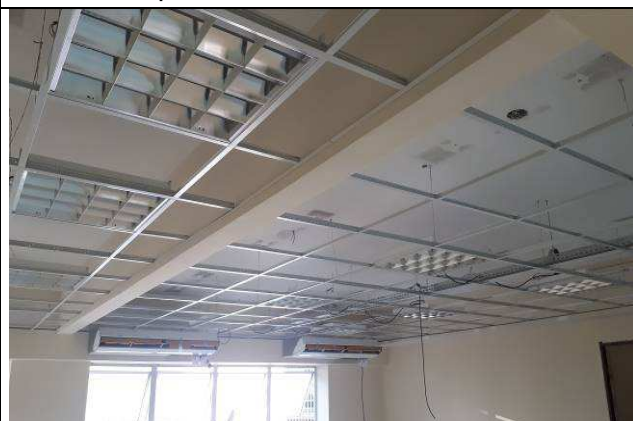
Figura 13E: luminárias 4x10W com aletas e plafons LED - 4a e 5a VT
