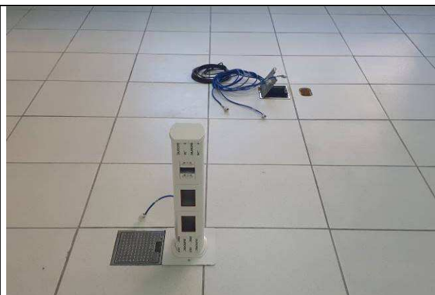
Figura 09E: instalações salas de audiências 4a e 5a VT
