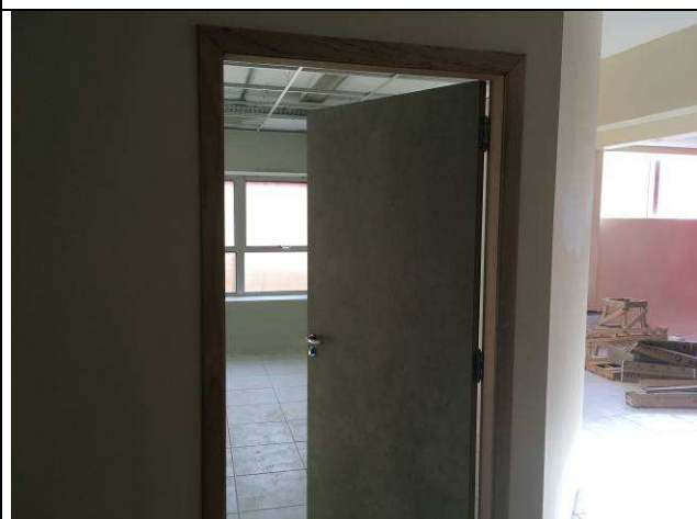
Figura 16C - portas acústicas instaladas.
