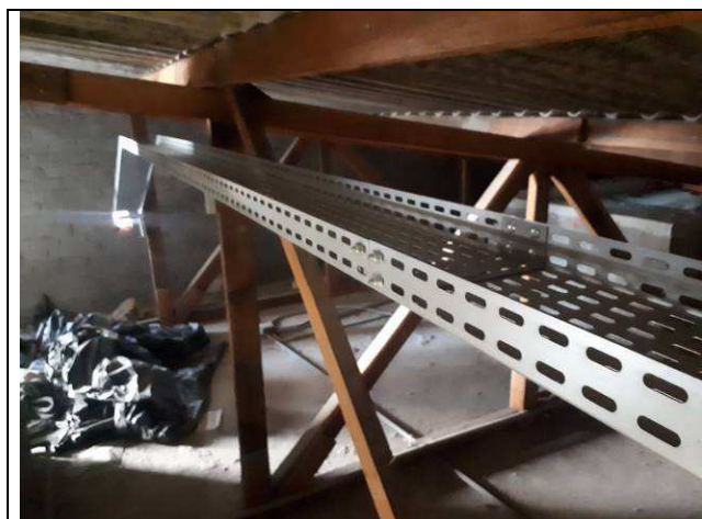
Figura 35E: infraestrutura de eletrocalhas - cobertura VM362
