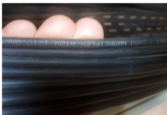
Figura 14E: cabeamento elétrico - ramais alimentadores quadros
