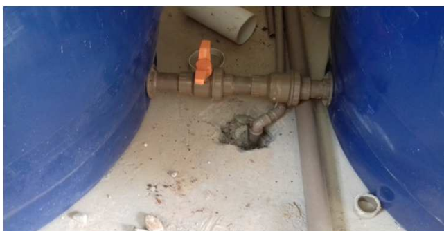
Figura 21C: Tubos e conexões do reservatório de reúso
