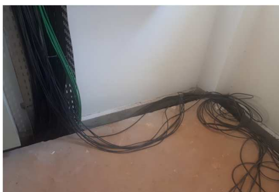
Figura 19E: cabeamento elétrico - ramal alimentador quadro QDEG - 25/16mm 2
