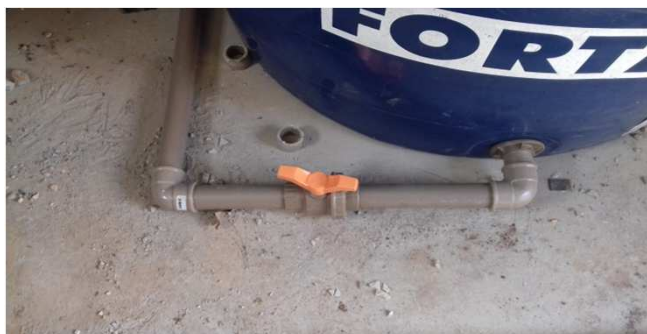
Figura 22C: Tubos e conexões do reservatório de reúso
