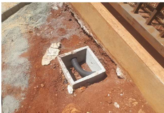
Figura 03E: infraestrutura externa de eletrodutos e caixas 30x30
