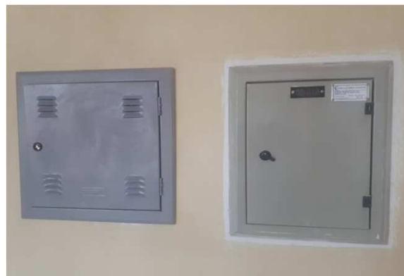
Figura 30E: infraestrutura interna - caixa telefonia OAB
