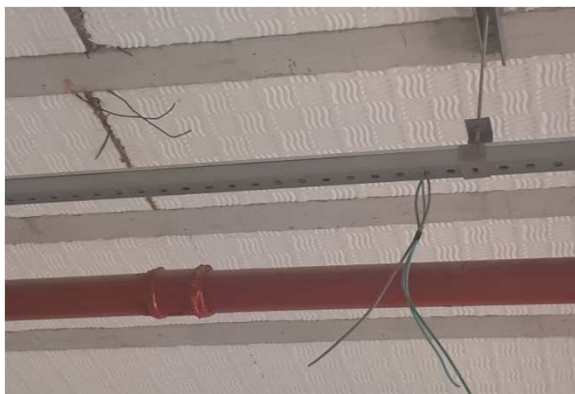
Figura 11E: infraestrutura interna - eletrocalhas e perfisados tampados
