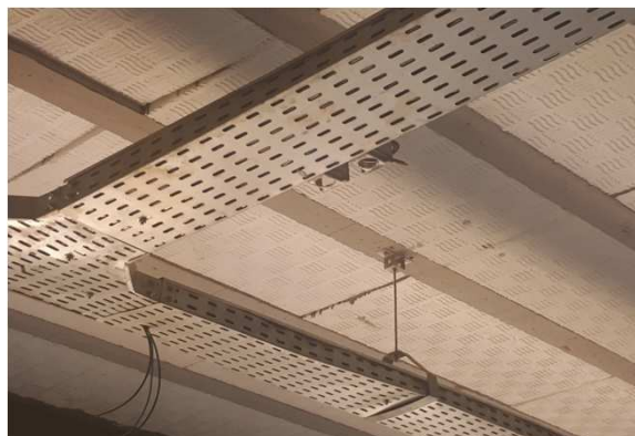
Figura 12E: infraestrutura interna - eletrocalhas e perfisados tampados
