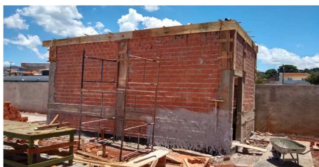
Figura 06C: Estrutura de pilares e vigas, além de alvenaria do reservatório de incêndio
