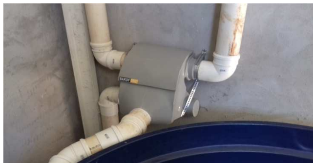
Figura 23C: Tubos de PVC de alimentação dos reservatórios de reúso
