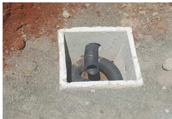
Figura 02E: infraestrutura externa de eletrodutos e caixas 30x30
