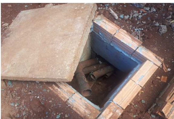
Figura 27E: infraestrutura externa - caixas tampadas, CFTV externo
