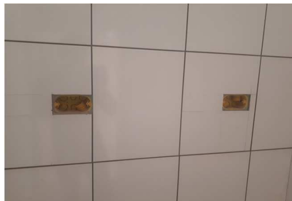
Figura 06E: infraestrutura interna - caixas e eletrodutos área central
