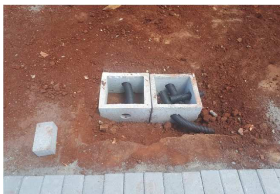
Figura 28E: infraestrutura externa - caixas tampadas, CFTV externo
