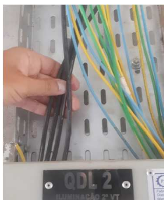
Figura 15E: cabeamento elétrico - ramal alimentador quadro QD - mm 2
