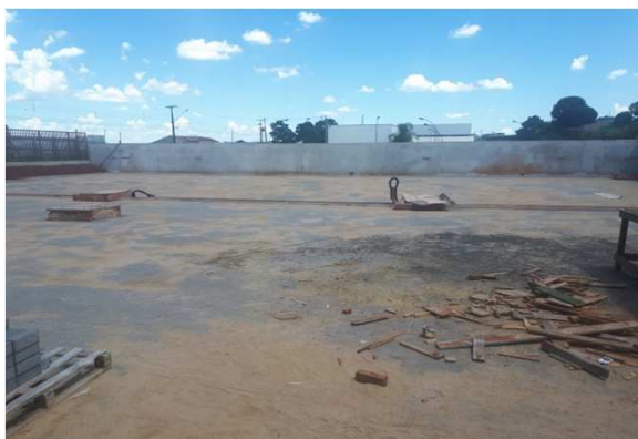
Figura 01E: infraestrutura externa de eletrodutos e caixas 30x30
