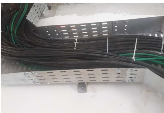
Figura 13E: cabeamento elétrico - ramais alimentadores quadros
