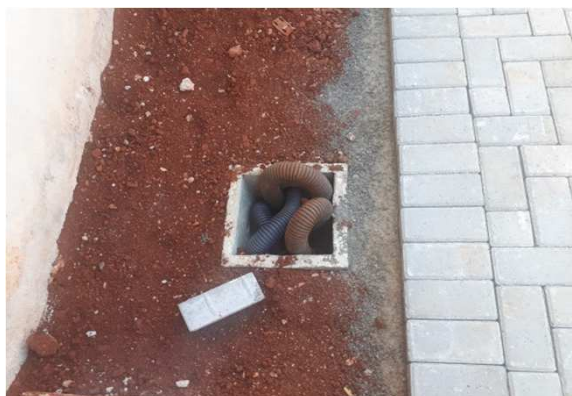
Figura 04E: infraestrutura externa de eletrodutos e caixas 30x30
