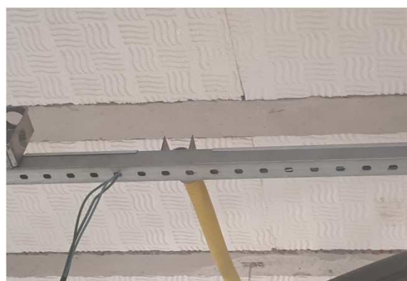
Figura 10E: infraestrutura interna - eletrocalhas e perfilados tampados
