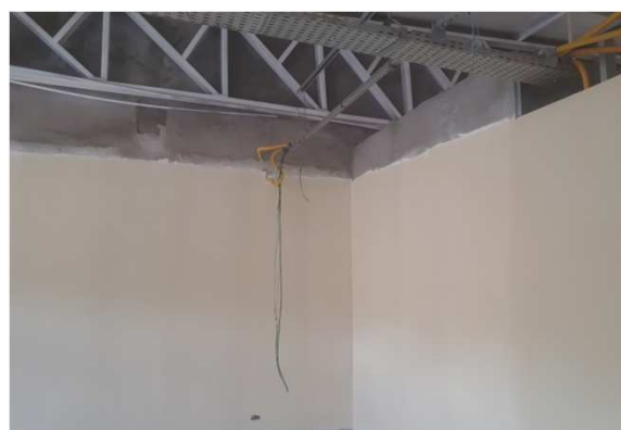
Figura 08E: infraestrutura interna - caixas e eletrodutos área central
