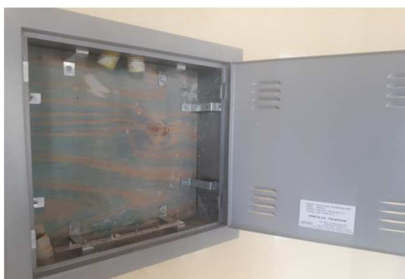
Figura 31E: infraestrutura interna - caixa telefonia OAB
