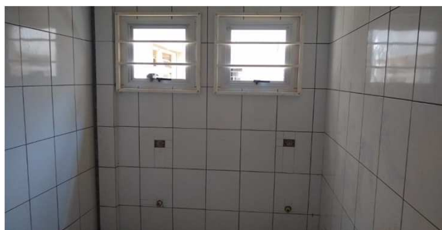
Figura 10C: Azulejo instalado em sanitário público feminino
