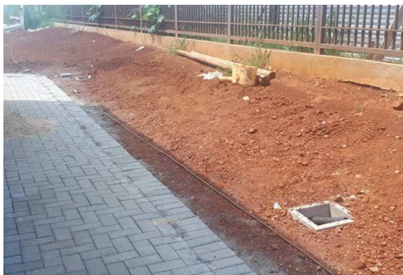
Figura 05E: infraestrutura externa de eletrodutos e caixas 30x30
