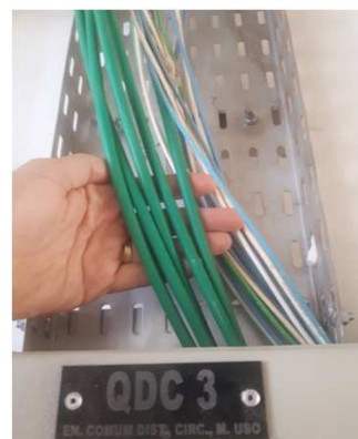
Figura 20E: cabeamento elétrico - ramal alimentador quadro QDC3 TERRA - 16 mm 2
