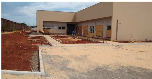
Figura 29C: Paver no estacionamento da direita e calçada defronte ao bloco da direita
