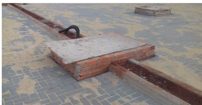
Figura 20C: Boca-de-lobo, executada no estacionamento da direita
