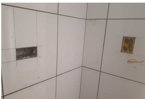
Figura 07E: infraestrutura interna - caixas e eletrodutos área central
