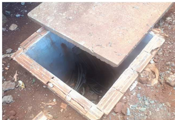
Figura 26E: infraestrutura externa - caixas tampadas, CFTV externo
