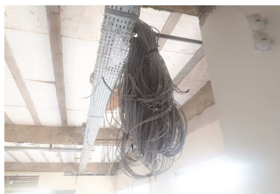
Figura 32E: cabeamento UTP
