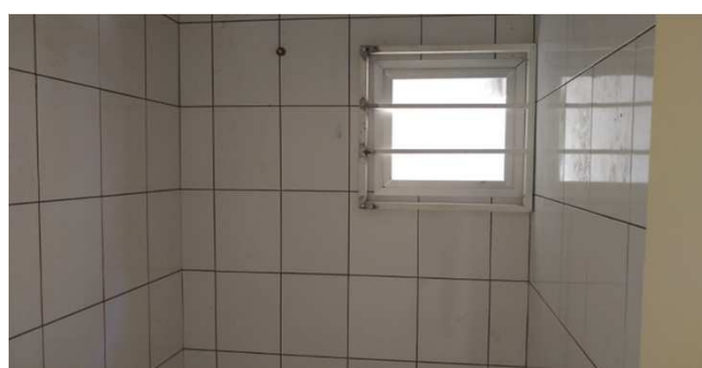
Figura 12C: Azulejo instalado em sanitário público feminino
