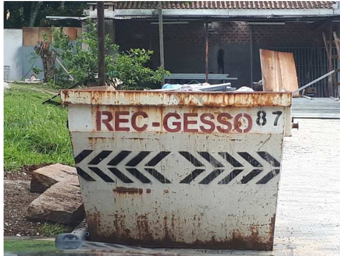
Figuras 06: Caçamba de entulho de gesso.
