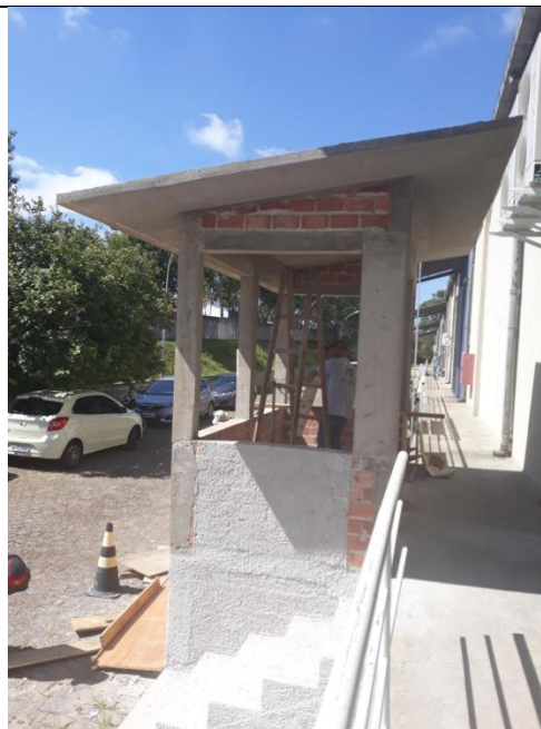
Figura 13 - Laje inclinada da Guarita da plataforma.
