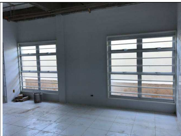
Figura 48C: Gradis de proteção.
