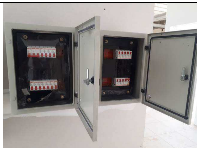
Figura 14E: quadros QDC2, QDE2, QDIL2.
