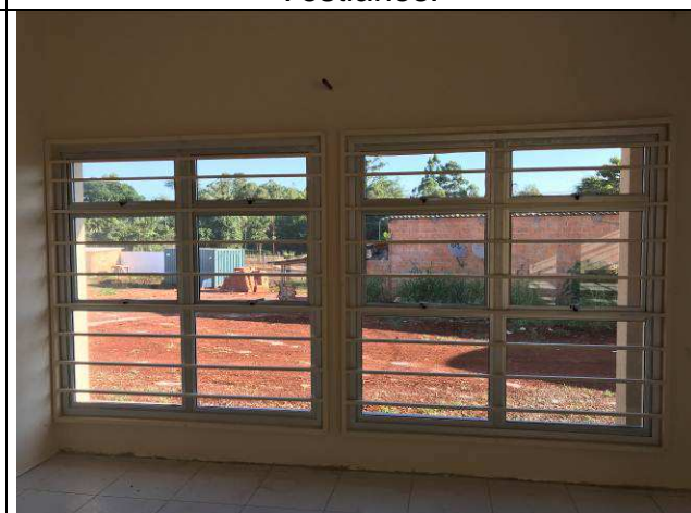
Figura 38C: Gradis de proteção.
