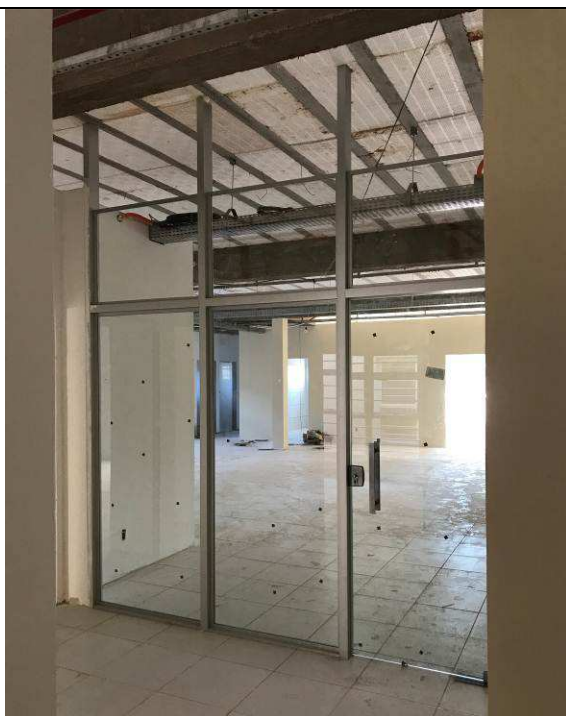
Figura 23C: Portas e painéis de vidro temperado - Balcão da 1ª Vara.
