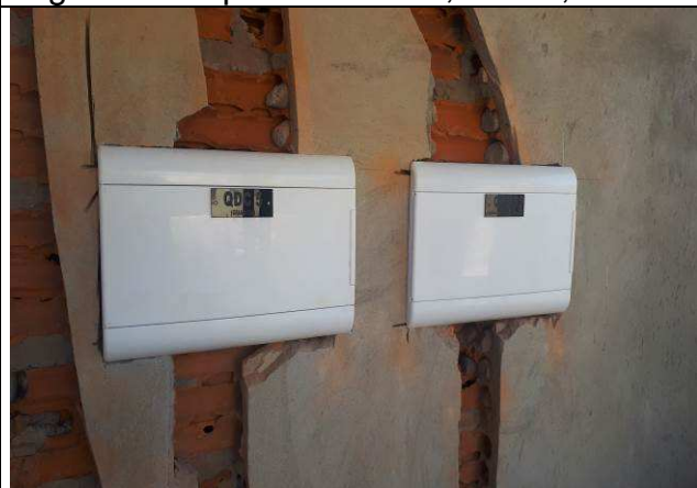
Figura 18E: quadros QDC5, QDE5.
