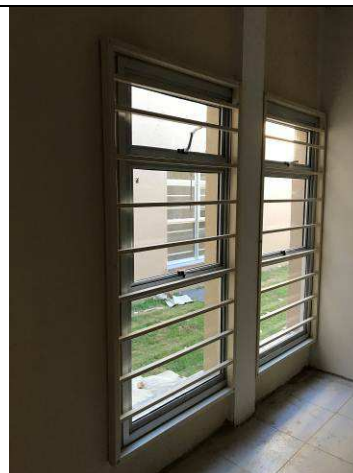
Figura 42C: Gradis de proteção.
