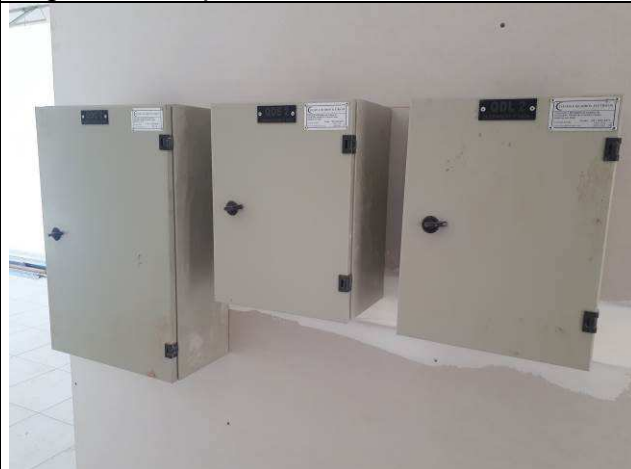
Figura 12E: quadros QDC2, QDE2, QDIL2.
