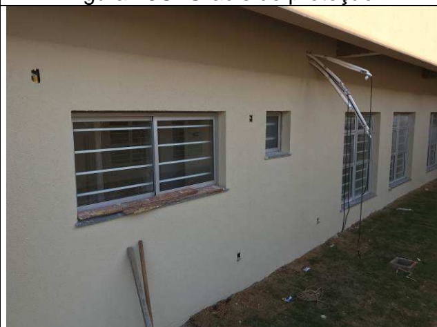
Figura 50C: Gradis de proteção.
