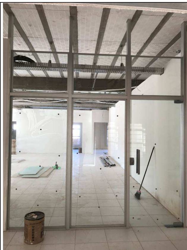
Figura 26C: Portas e painéis de vidro temperado - Balcão da 2ª Vara.
