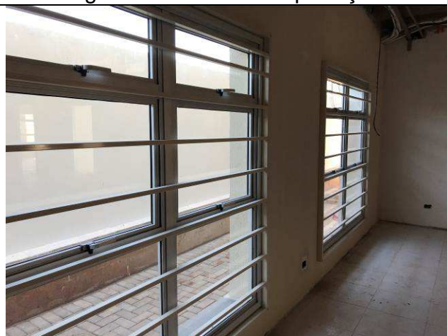
Figura 43C: Gradis de proteção.
