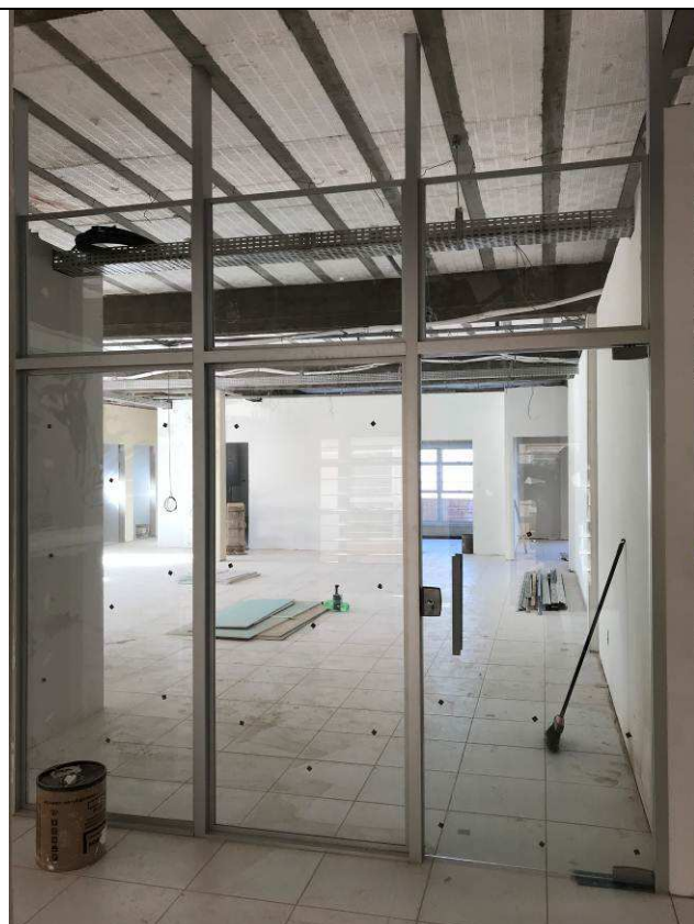
Figura 25C: Portas e painéis de vidro temperado - Balcão da 2ª Vara.
