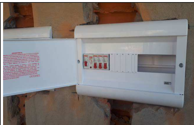
Figura 20E: quadros QDC5, QDE5.
