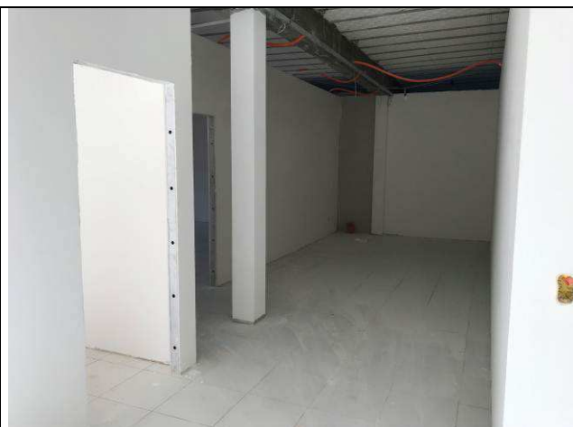
Figura 03C: Paredes de gesso acartonado - Espera Auditório e Área de Vivência.
