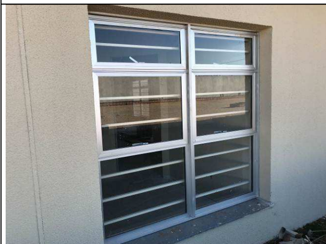
Figura 51C: Gradis de proteção.
