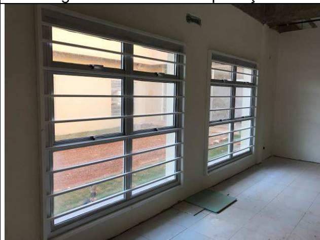
Figura 44C: Gradis de proteção.
