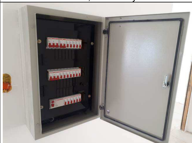
Figura 10E: quadros QDC1, QDE1, QDIL1.
