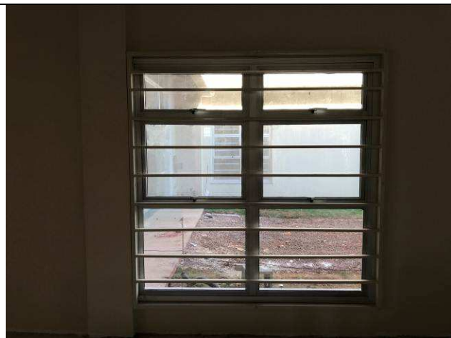
Figura 41C: Gradis de proteção.
