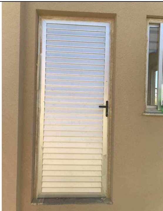
Figura 21C: Porta de Alumínio - Guarita.
