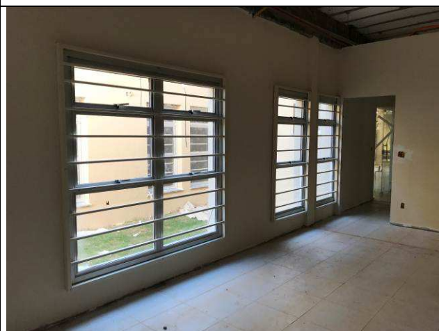
Figura 46C: Gradis de proteção.
