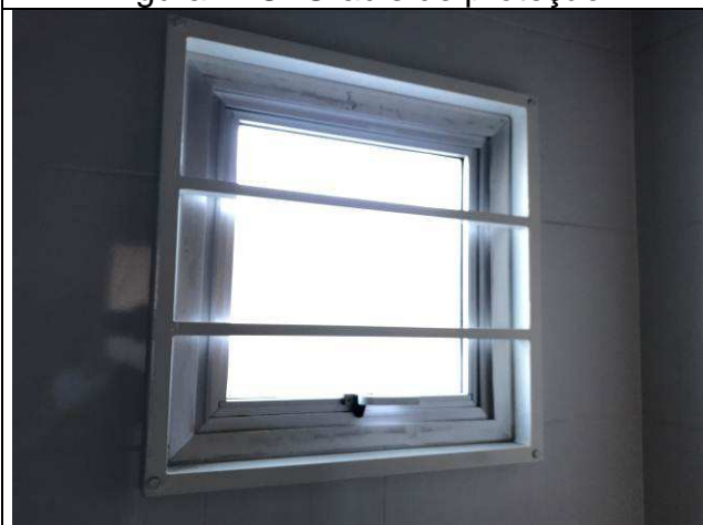
Figura 49C: Gradis de proteção.
