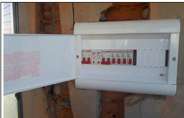
Figura 19E: quadros QDC5, QDE5.
