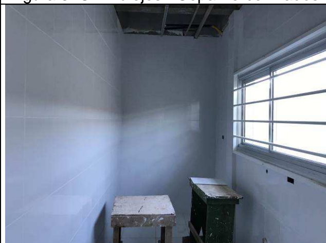
Figura 56C: Azulejos - Cozinha Terceiriz.
