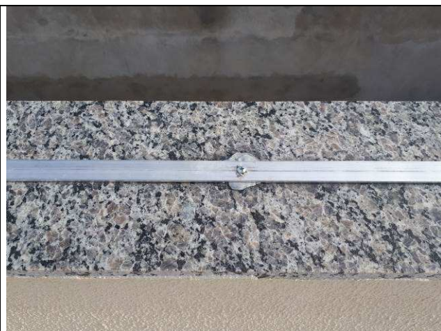
Figura 18E: captação SPDA com fitas de alumínio
