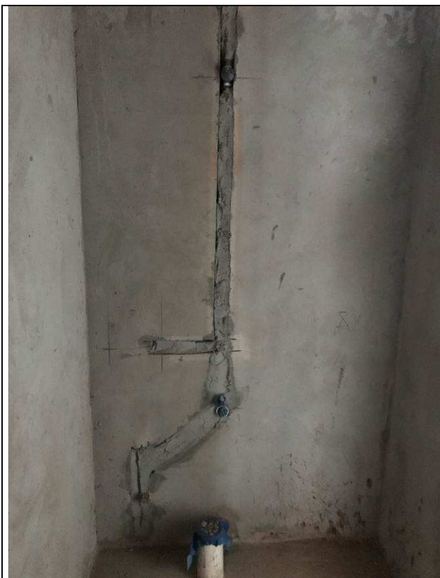
Figura 41C: Pontos de água e esgoto - Bebedouro público.
