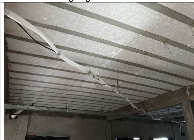
Figura 49C: Tubulações internas - rede frigorígena - PAB II.
