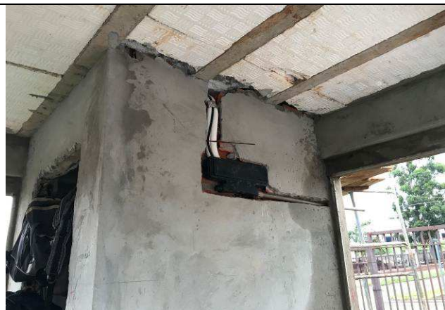
Figura 63C: Tubulações internas - rede frigorígena - Guarita.
