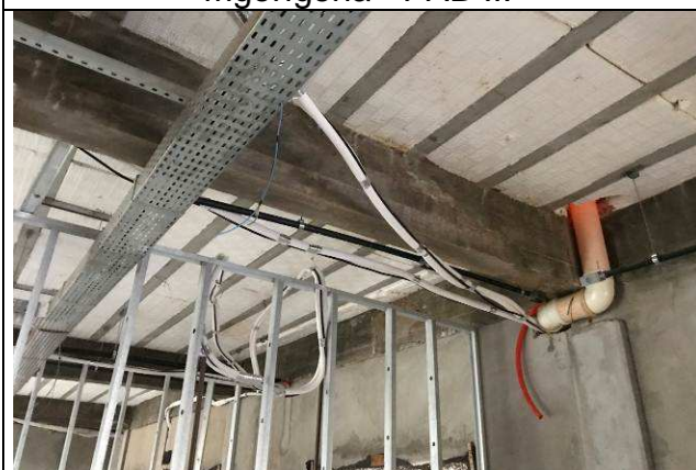
Figura 51C: Tubulações internas - rede frigorígena - 2ª Vara.
