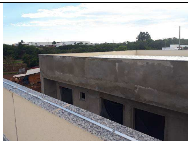
Figura 17E: captação SPDA com fitas de alumínio
