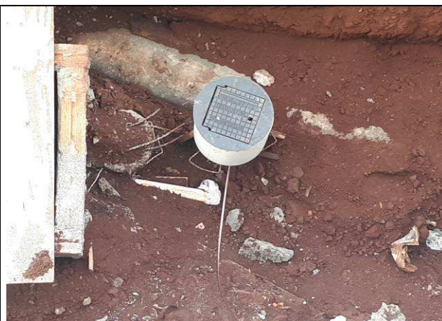
Figura 06E: malha de aterramento cobre nu, hastes, caixas de inspeção, descidas
