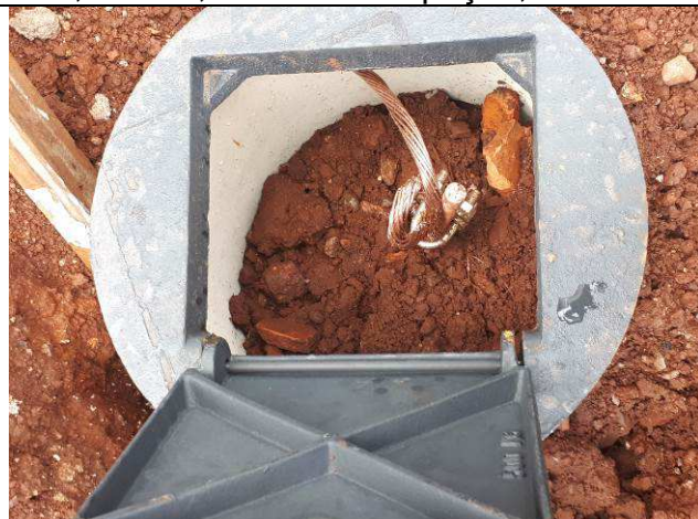
Figura 07E: malha de aterramento cobre nu, hastes, caixas de inspeção, descidas
