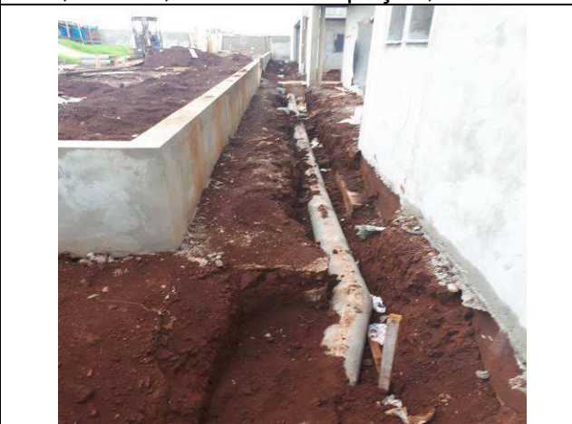
Figura 10E: malha de aterramento cobre nu, hastes, caixas de inspeção, descidas
