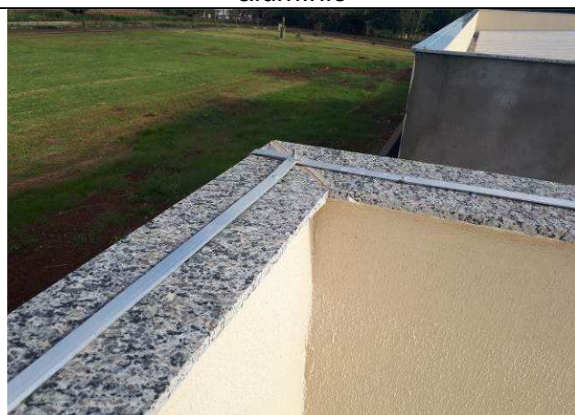
Figura 13E: captação SPDA com fitas de alumínio
