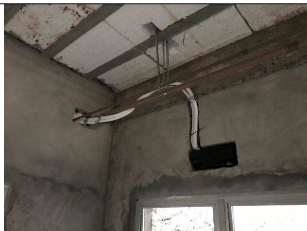
Figura 61C: Tubulações internas - rede frigorígena - 1ª Vara.
