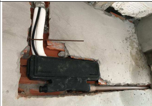
Figura 64C: Tubulações internas - rede frigorígena - Guarita.
