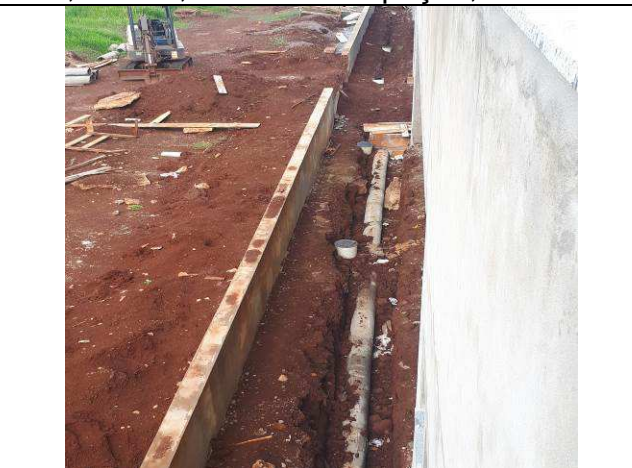
Figura 09E: malha de aterramento cobre nu, hastes, caixas de inspeção, descidas
