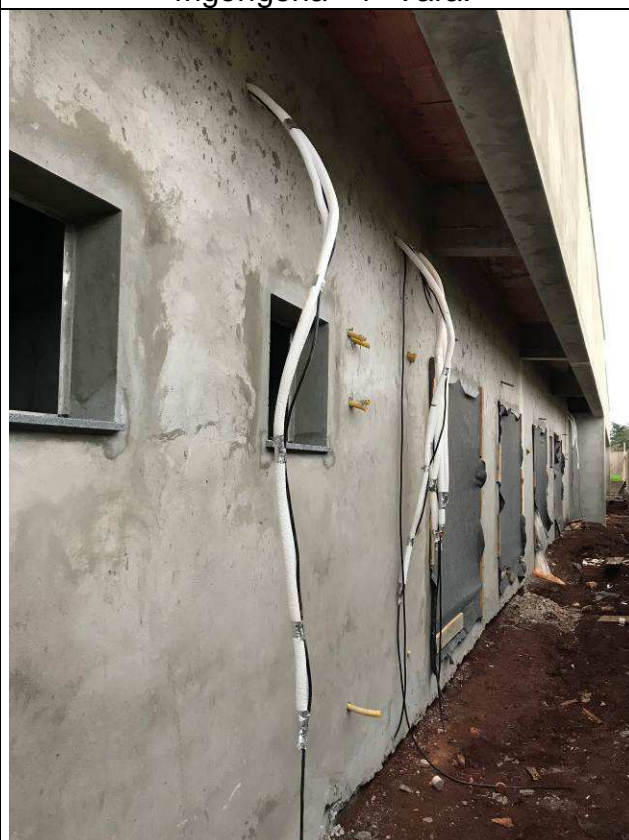
Figura 60C: Tubulações externas - rede frigorígena - 1ª Vara.
