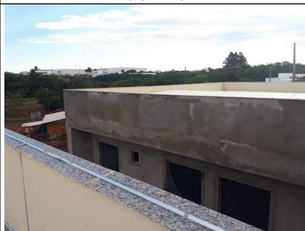
Figura 16E: captação SPDA com fitas de alumínio
