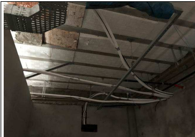
Figura 47C: Tubulações internas - rede frigorígena - OAB.
