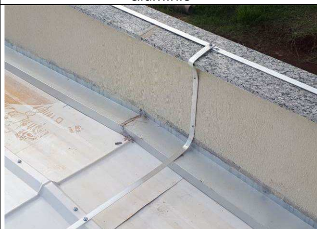
Figura 19E: captação SPDA com fitas de alumínio
