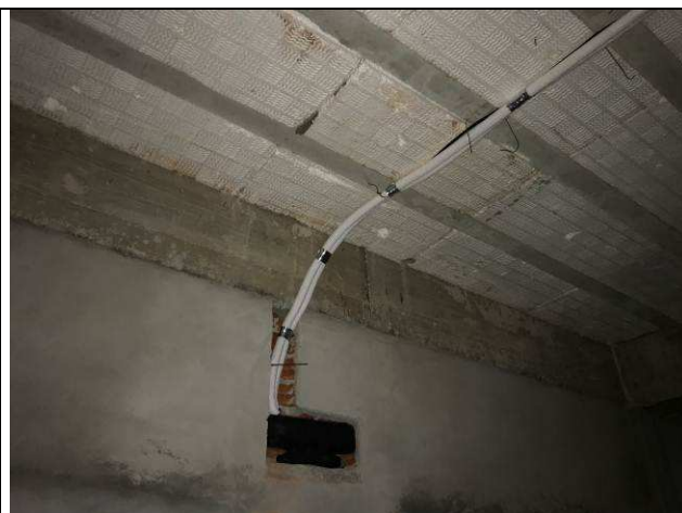
Figura 58C: Tubulações internas - rede frigorígena - 1ª Vara.
