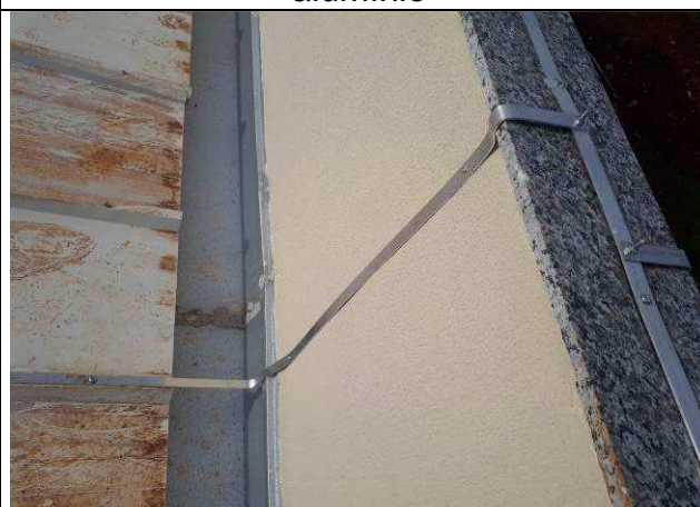
Figura 14E: captação SPDA com fitas de alumínio
