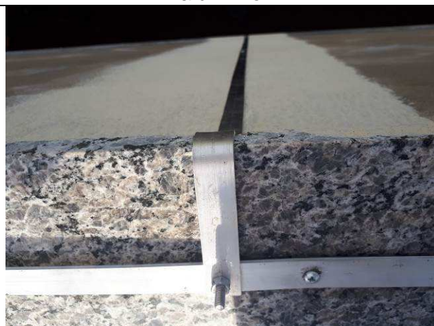
Figura 15E: captação SPDA com fitas de alumínio
