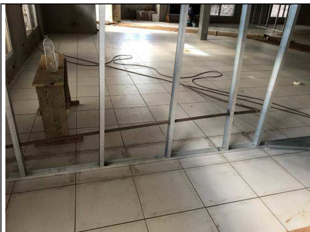
Figura 53C: Drenos embutidos nas paredes de gesso acartonado - 2ª Vara.
