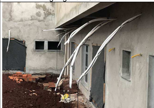
Figura 66C: Tubulações externas - rede frigorígena - 2ª Vara.
