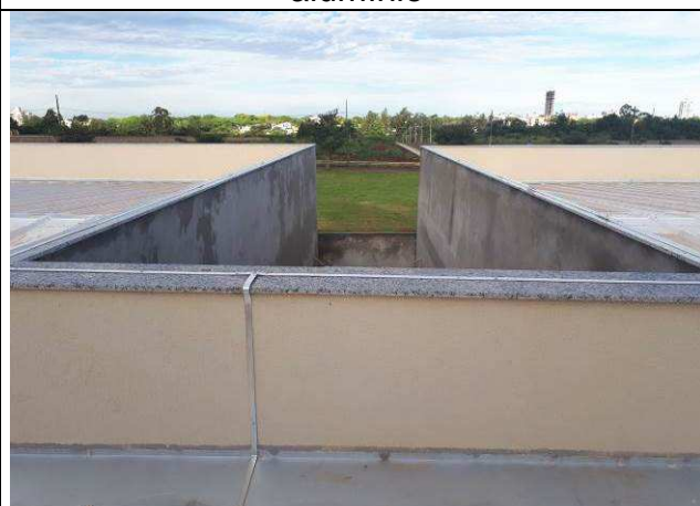
Figura 20E: captação SPDA com fitas de alumínio
