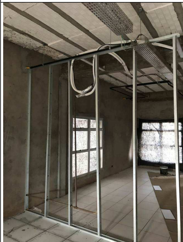
Figura 55C: Rede frigorígena e drenos embutidos nas paredes de gesso acartonado - 2ª Vara.
