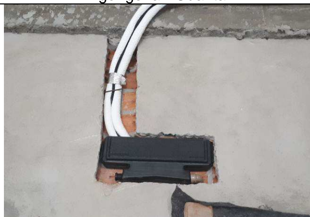
Figura 65C: Detalhe das caixas de interligação das evaporadoras.
