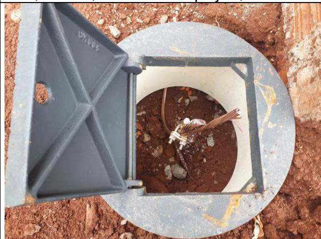
Figura 08E: malha de aterramento cobre nu, hastes, caixas de inspeção, descidas
