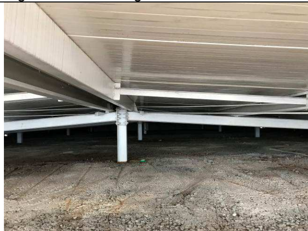
Figura 20C: Vista da face inferior das telhas de cobertura - 2ª Vara.
