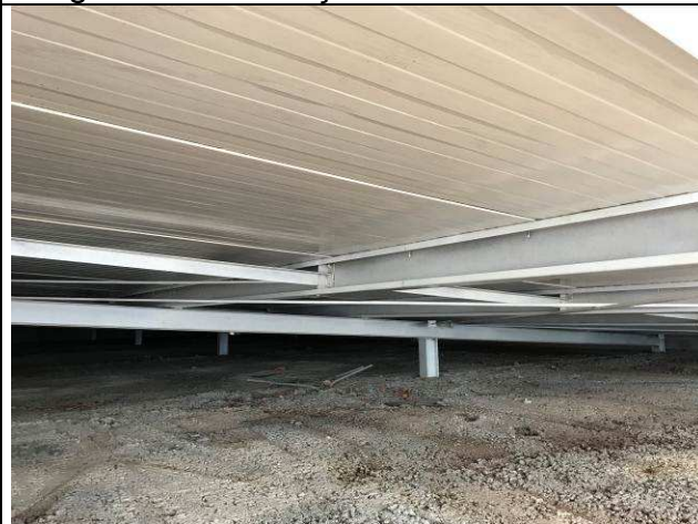
Figura 21C: Vista da face inferior das telhas de cobertura - 2ª Vara.
