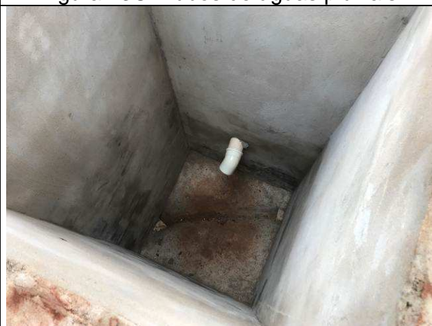
Figura 75C: Caixas de inspeção - rede de esgoto.
