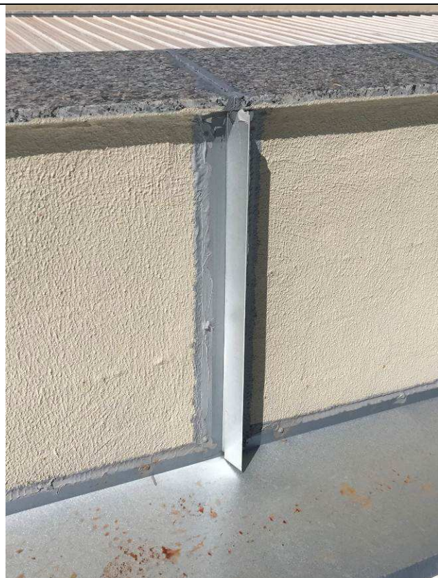
Figura 42C: Rufo na junta de dilatação.
