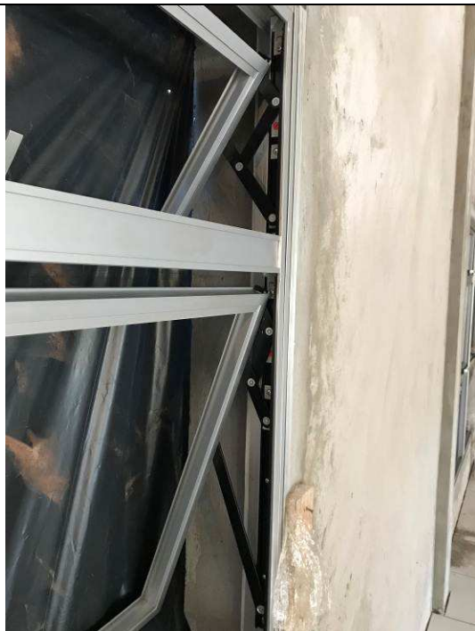
Figura 02C: Braços tipo projetante deslizante instalados nas janelas.
