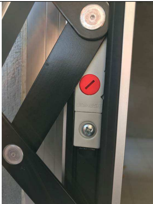
Figura 05C: Braços tipo projetante deslizante instalados nas janelas.
