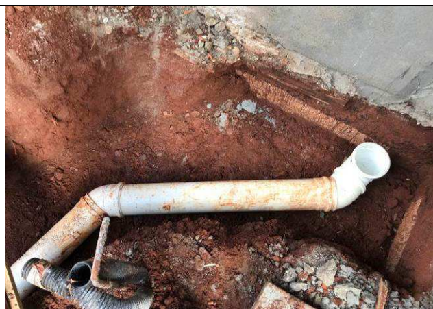
Figura 67C: Tubos de captação de águas pluviais.
