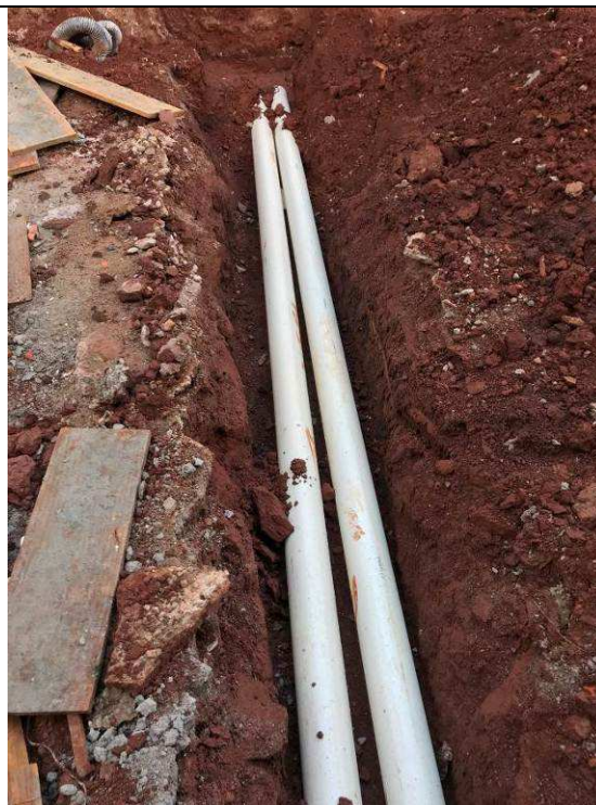
Figura 64C: Tubos de captação de águas pluviais.
