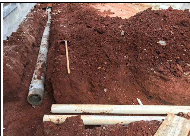
Figura 68C: Tubos de captação de águas pluviais.
