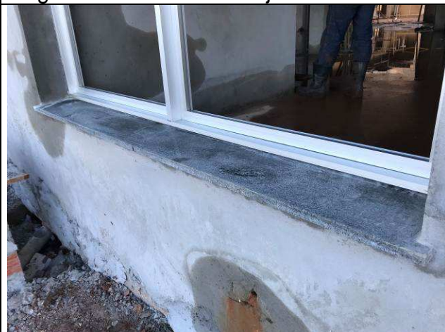
Figura 50C: Peitoris das janelas - Fórum.
