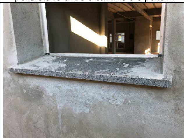
Figura 58C: Peitoris das janelas - Fórum.
