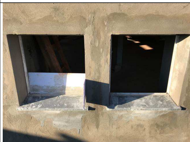
Figura 57C: Peitoris das janelas - Fórum.
