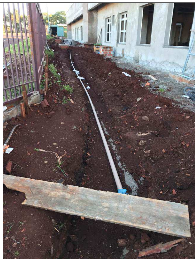
Figura 61C: Alimentação de água fria - tubo externo do cavalete aos reservatórios.
