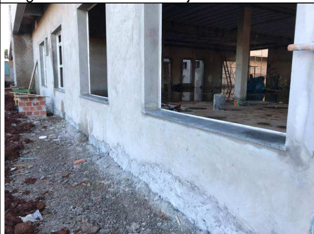
Figura 49C: Peitoris das janelas - Fórum.
