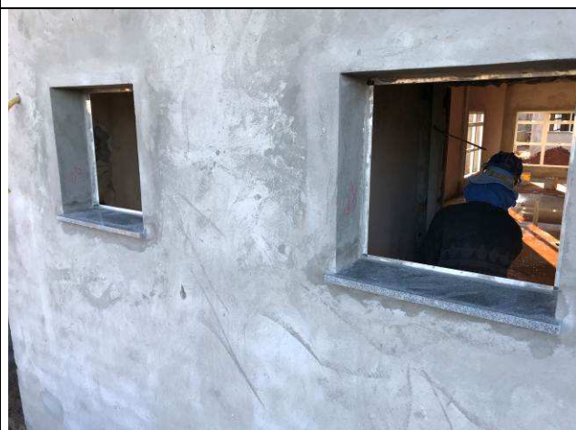
Figura 55C: Peitoris das janelas - Fórum.
