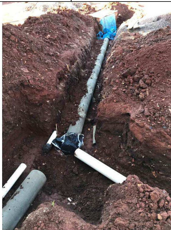
Figura 66C: Tubos de captação de águas pluviais.
