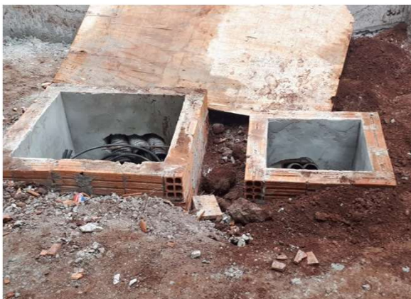
Figura 1E: Caixas de entrada de energia elétrica.
