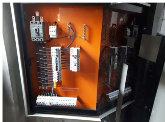
Figura 22E: Quadro elétrico QDACG.
