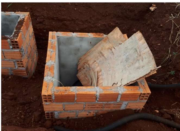
Figura 3E: Caixas de entrada de energia elétrica.
