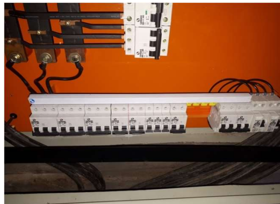
Figura 20E: Quadro elétrico QDG.
