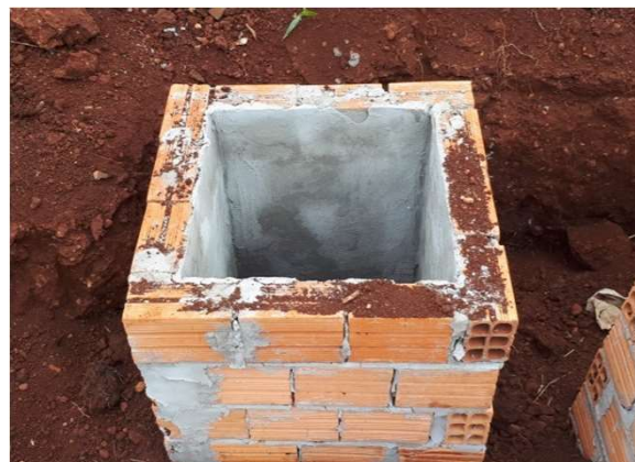
Figura 26E: Caixas de passagem e inspeção entrada de telecomunicações.
