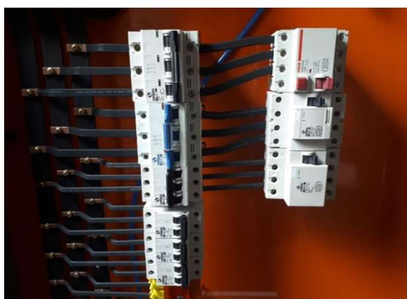
Figura 24E: Quadro elétrico QDACG.
