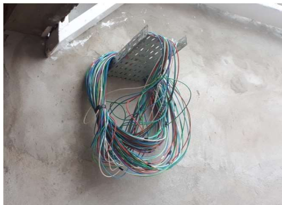
Figura 8E: Cabos elétricos #2,5mm 2 .
