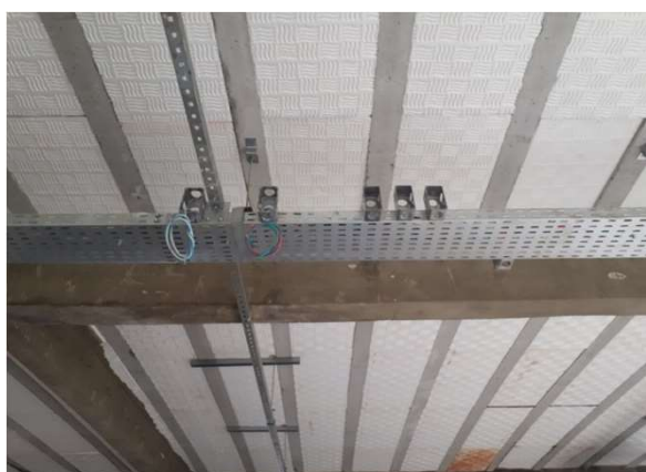
Figura 5E: Cabos elétricos #2,5mm 2 .
