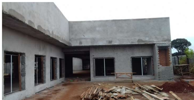
Figura 09C: paredes próximas a entrada principal do imóvel
