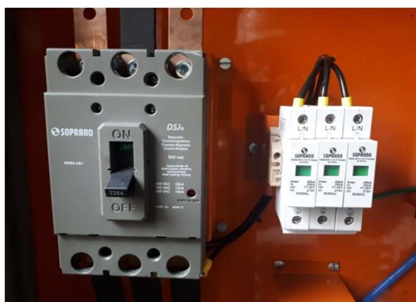
Figura 23E: Quadro elétrico QDACG.
