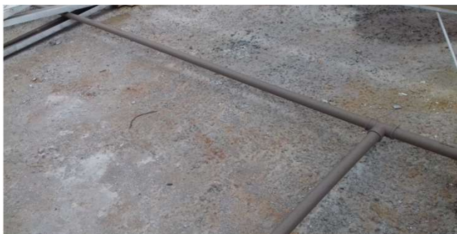
Figura 29C: rede alimentadora de 25mm, localizada no bloco da direita
