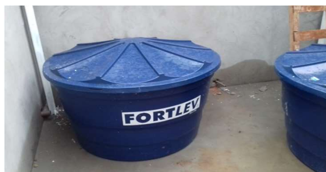
Figura 40C: reservatórios localizados no bloco da esquerda.
