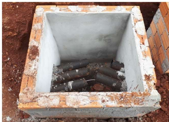
Figura 2E: Caixas de entrada de energia elétrica.
