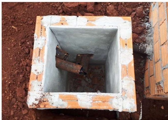
Figura 25E: Caixas de passagem e inspeção entrada de telecomunicações.
