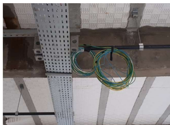
Figura 6E: Cabos elétricos #2,5mm 2 .
