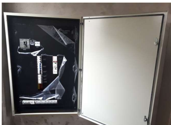
Figura 21E: Quadro elétrico QDACG.
