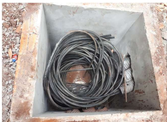
Figura 12E: Cabos elétricos #120mm 2 e 70mm 2 entrada de energia
