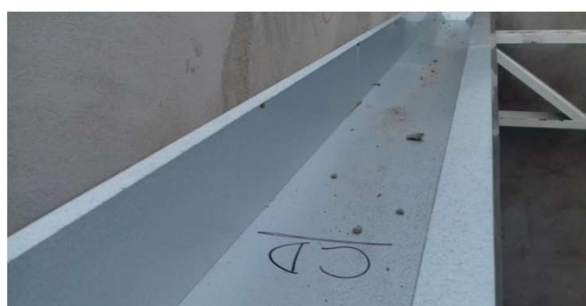
Figura 11C: detalhe de calha localizada no reservatório esquerdo (reúso)
