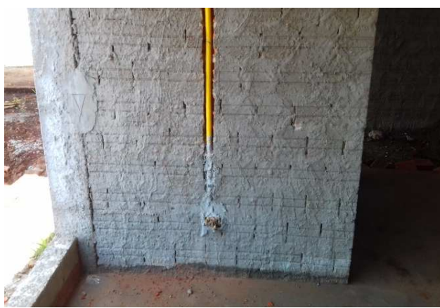
Figura 12E: Caixas 4x2\", eletrodutos corrugados, eletrodutos PVC rígidos
