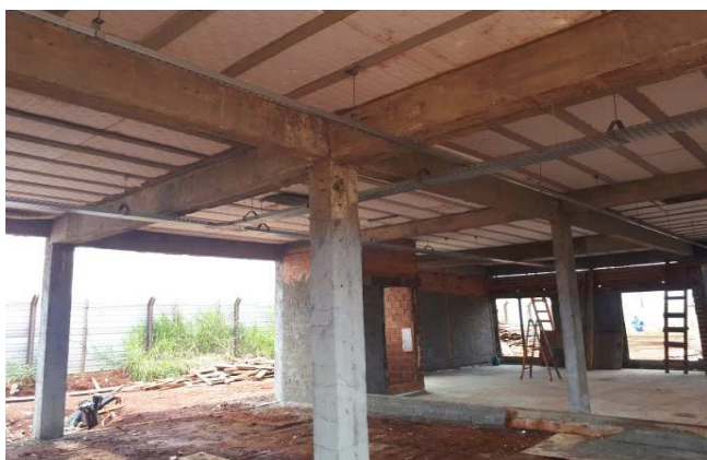
Figura 05E: Eletrocalha #200x50, perfilados - parte frontal
