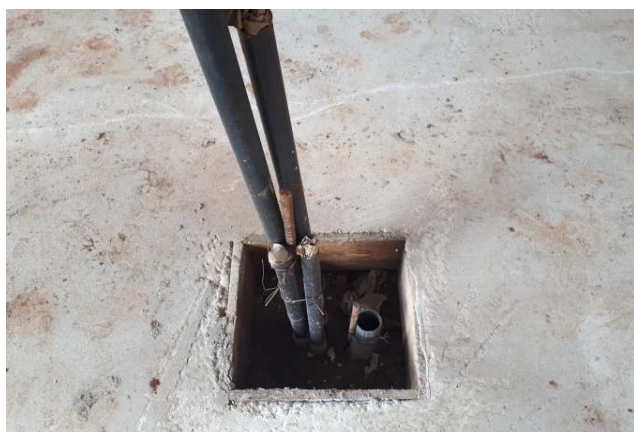
Figura 33E: Eletrodutos rígidos 1" e 2" - sala de audiências
