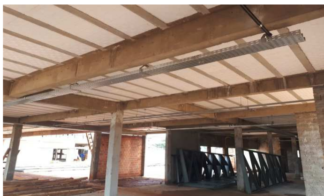
Figura 04E: Eletrocalha #200x50, perfilados - parte frontal
