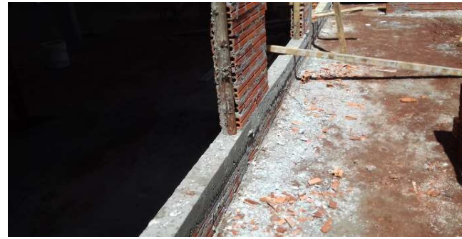
Figura 07C: Contraergas em janelas - fundos da obra
