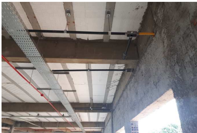
Figura 13E: Caixas 4x2", eletrodutos corrugados, eletrodutos PVC rígidos, condutes
