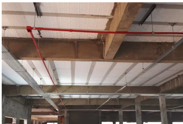
Figura 23E: Eletroduto rígido PVC, condutetes - SDAI
