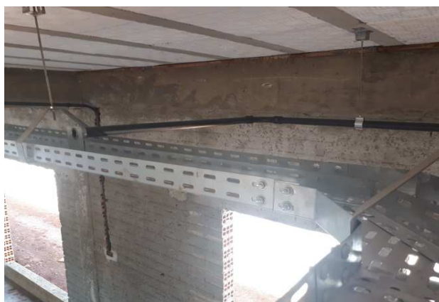
Figura 14E: Caixas 4x2", eletrodutos corrugados, eletrodutos PVC rígidos, condutes
