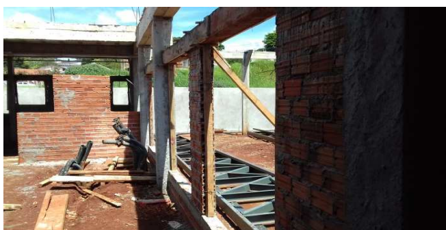
Figura 06C: Vergas e contravergas em janelas - bloco central
