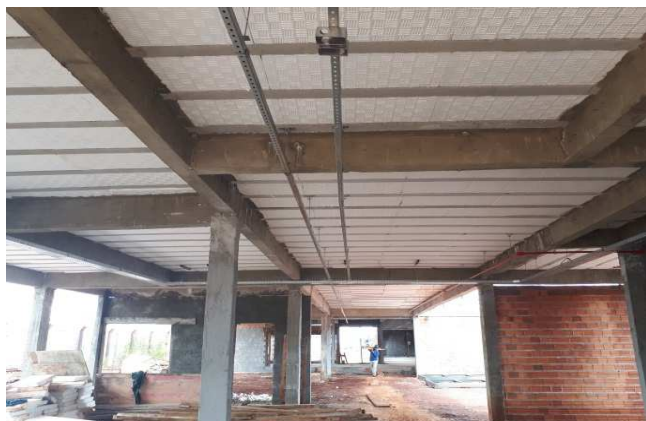
Figura 06E: Eletrocalha #200x50, perfilados - parte frontal
