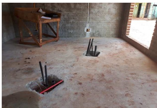
Figura 32E: Eletrodutos rígidos 1" e 2" - sala de audiências
