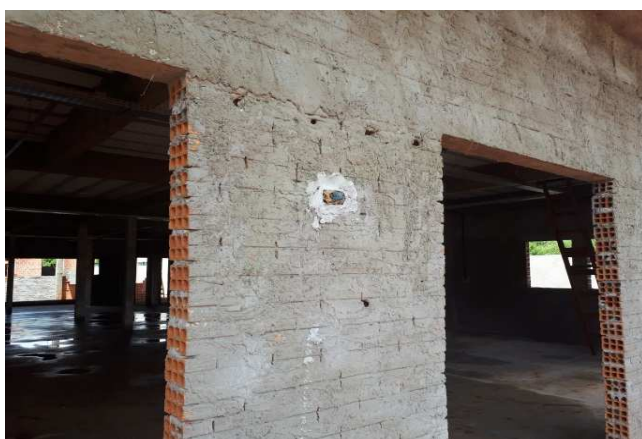
Figura 09E: Caixas 4x2\", eletrodutos corrugados, eletrodutos PVC rígidos
