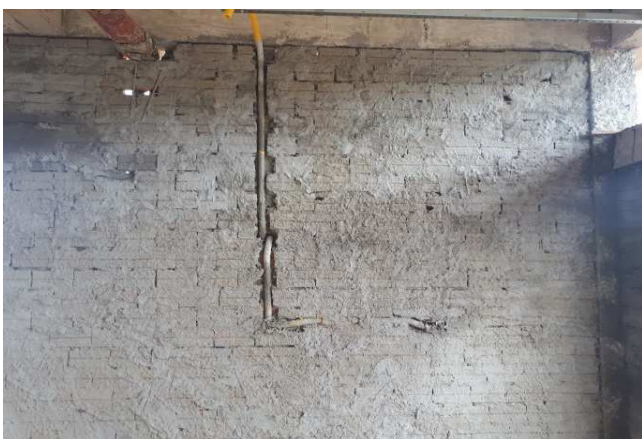
Figura 11E: Caixas 4x2\", eletrodutos corrugados, eletrodutos PVC rígidos
