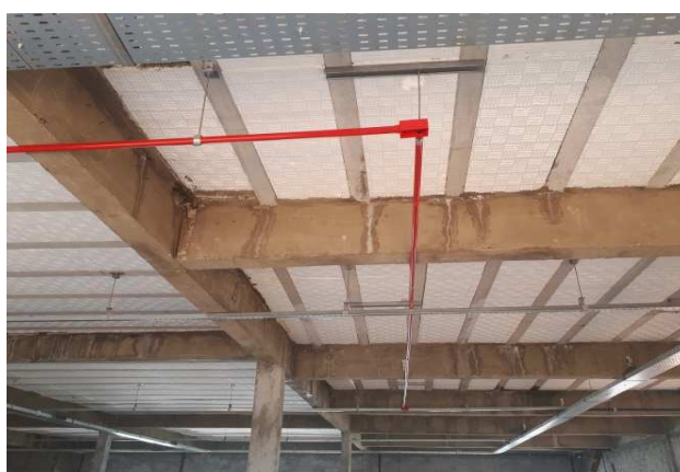
Figura 24E: Eletroduto rígido PVC, condutetes - SDAI
