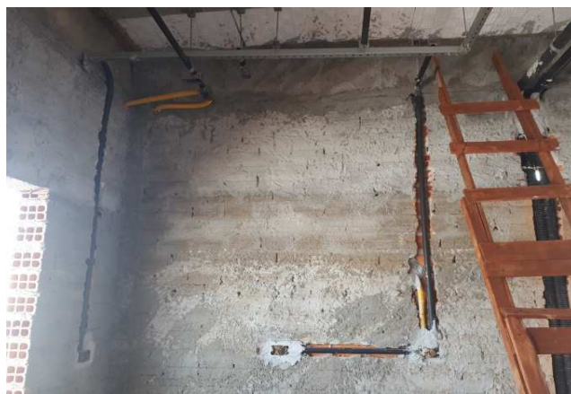
Figura 10E: Caixas 4x2\", eletrodutos corrugados, eletrodutos PVC rígidos
