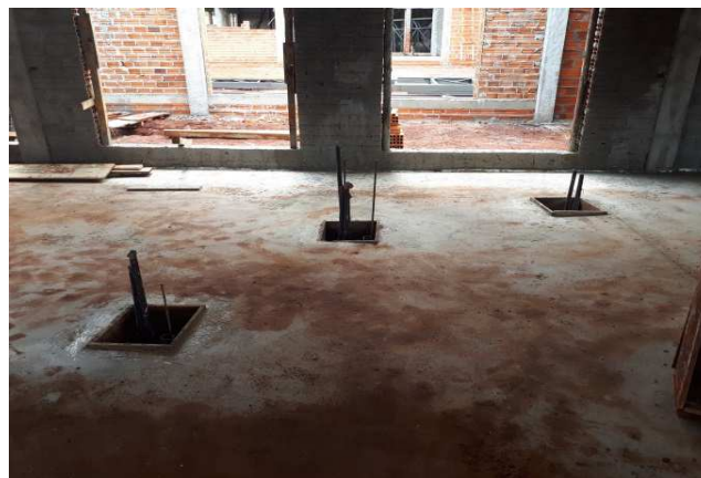
Figura 34E: Eletrodutos rígidos 1" e 2" - sala de audiências
