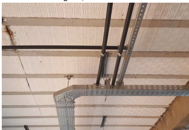
Figura 16E: Caixas 4x2", eletrodutos corrugados, eletrodutos PVC rígidos, condutes
