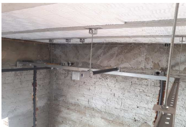
Figura 29E: Eletroduto rígido de 1" e condutes para Sistema de CFTV
