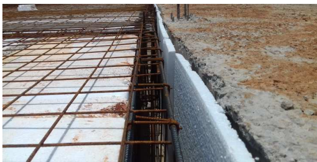
Figura 06C: Fôrmas e armaduras de viga dupla (separação com EPS da porção direita com porção central)
