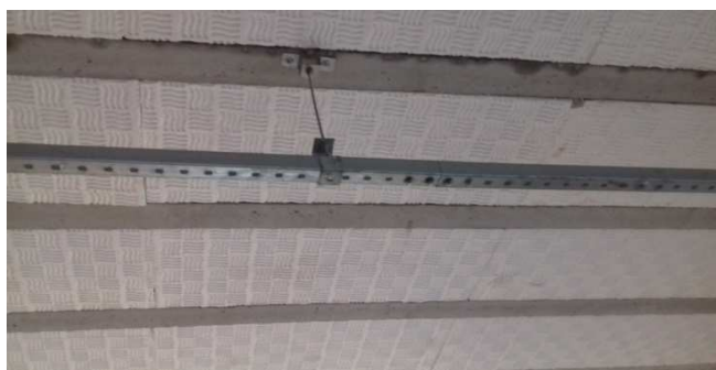
Figura 10E: Segmento de perfilado #38x38, no bloco da direita - fixação na vigota treliçada da laje
