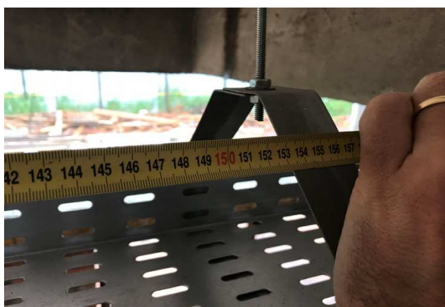
Figura 04E: Aferição da distância entre pontos de fixação de eletrocalha - aprox 150cm
