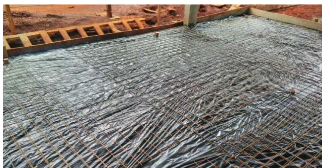
Figura 32C: Lona plástica preta instalada antes da concretagem do contrapiso - bloco da direita
