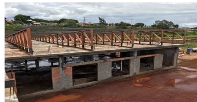
Figura 26C: Panos de alvenaria levantados até meia altura, na parte frontal do bloco da direita
