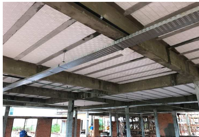
Figura 20E: Eletrodutos rígidos de 1", partindo de eletrocalha
