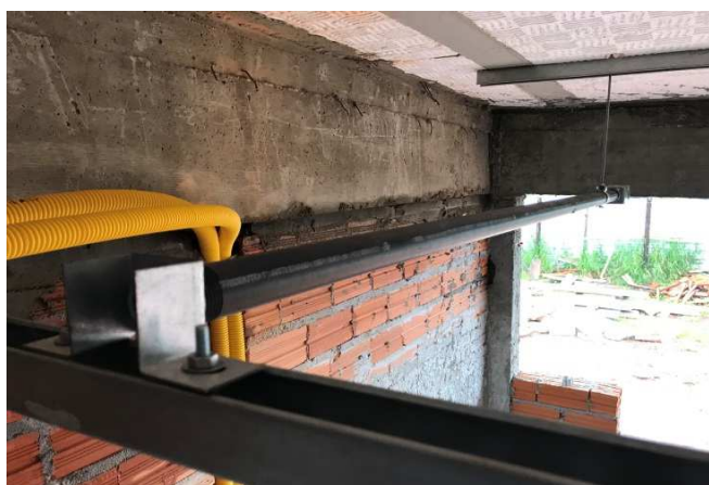
Figura 19E: Eletroduto rígido de 1", partindo de perfilado para ligar a eletroduto de parede
