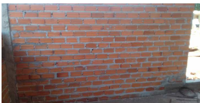
Figura 19C: Pano de parede com alvenaria de fechamento externo até a viga superior
