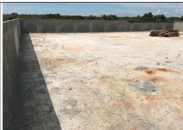
Figura 98C: Revestimento argamassado da face interna - platibandas Fórum.
