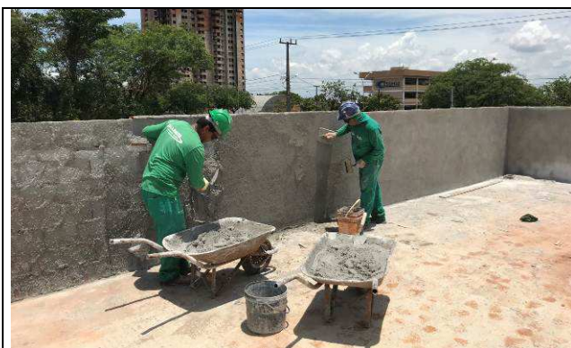
Figura 93C: Revestimento argamassado da face interna - platibandas Fórum.
