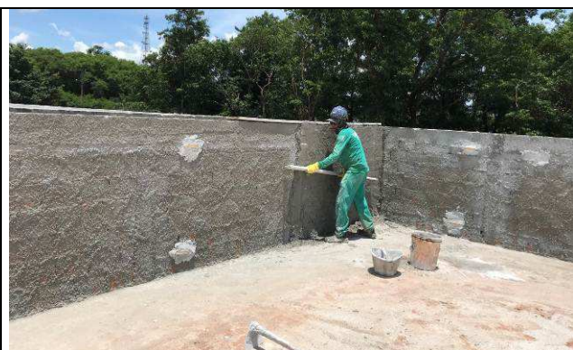
Figura 94C: Revestimento argamassado da face interna - platibandas Fórum.
