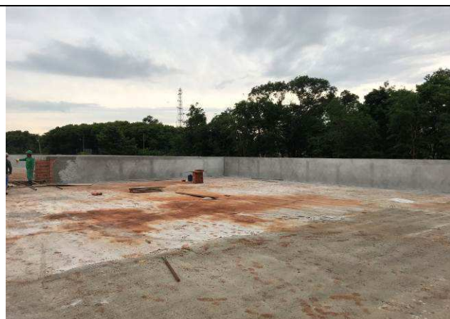
Figura 97C: Revestimento argamassado da face interna - platibandas Fórum.
