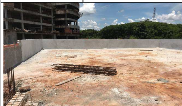
Figura 95C: Revestimento argamassado da face interna - platibandas Fórum.
