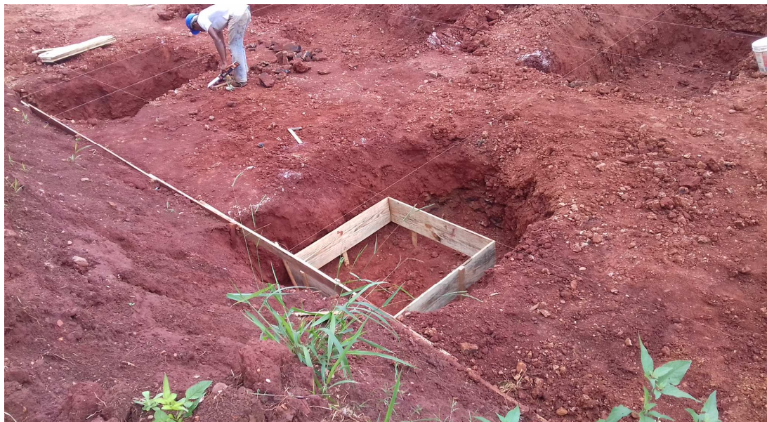
Início da execução das fôrmas das sapatas - Serviço representa item do primeiro termo aditivo e, portanto, não pode ser medido
