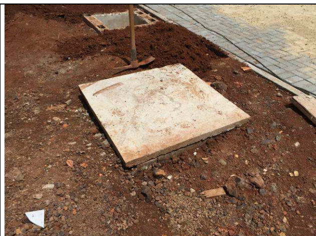
Figura 89C: Caixa de inspeção de esgoto com tampa.
