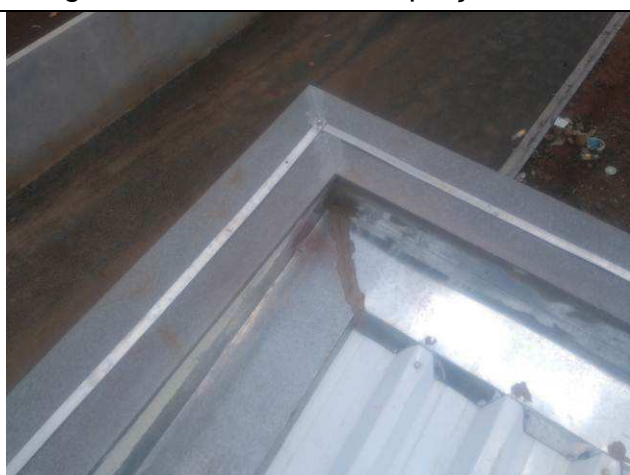
Figura 46E: sistema de captação SPDA
