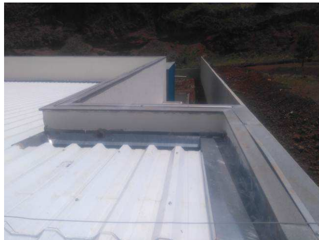
Figura 48E: sistema de captação SPDA
