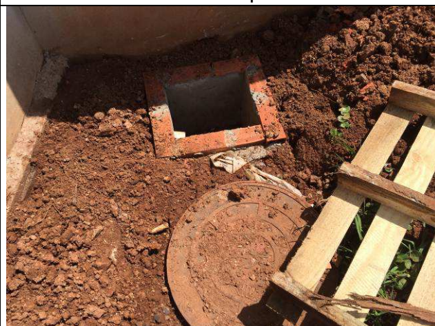
Figura 93C: Caixa de águas pluviais - fundos do terreno lado esquerdo.
