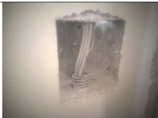
Figura 35E: infraestrutura e cabeamento UTP e alarme - arquivo
