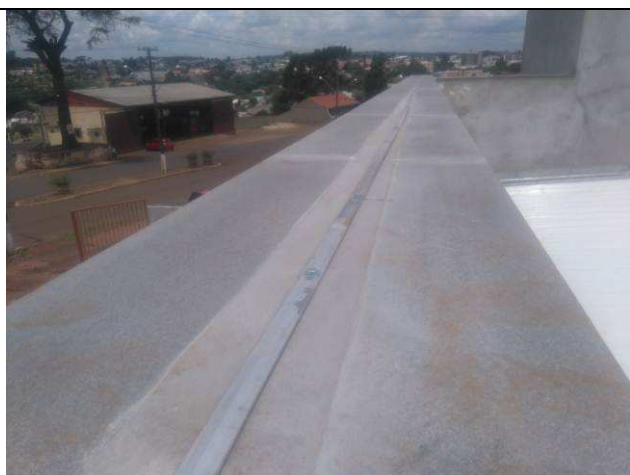
Figura 44E: sistema de captação SPDA
