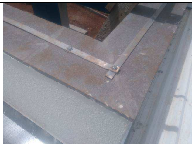
Figura 43E: sistema de captação SPDA
