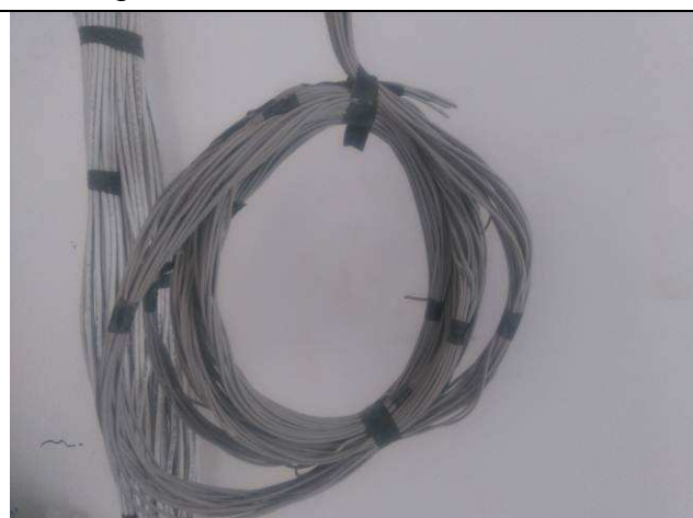
Figura 39E: cabeamento alarme
