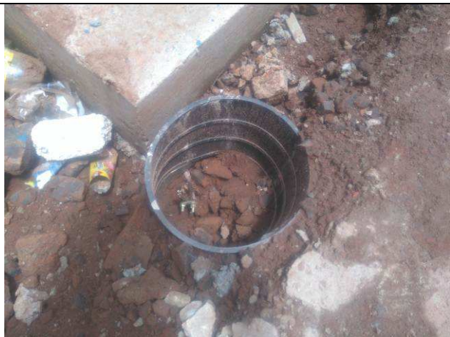
Figura 42E: malha de aterramento
