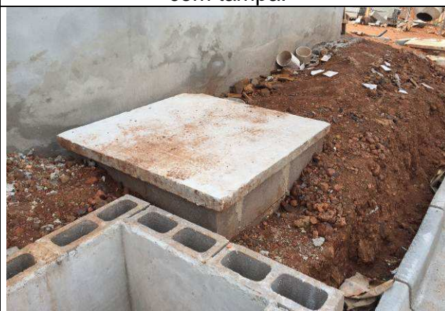
Figura 91C: Caixa de inspeção de esgoto com tampa.
