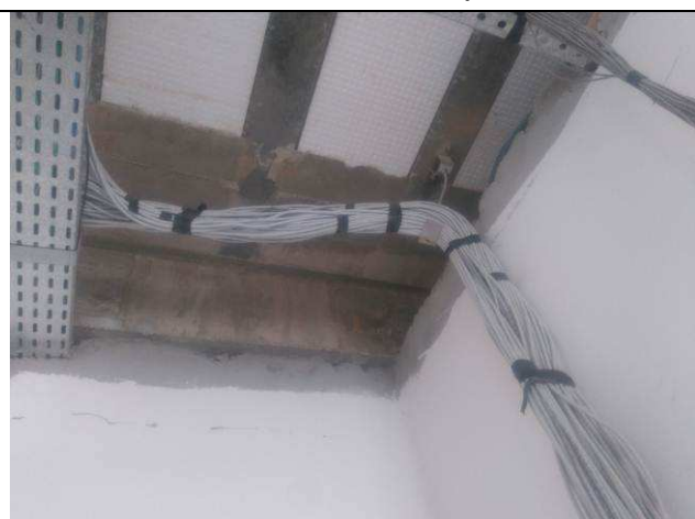
Figura 37E: cabeamento UTP cat6
