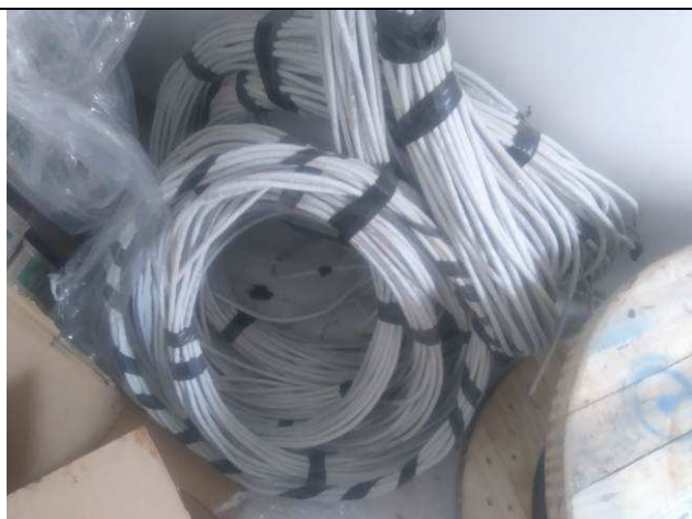
Figura 36E: cabeamento UTP cat6
