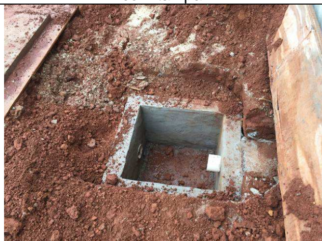
Figura 92C: Caixa de águas pluviais - coleta do dreno do muro de arrimo.
