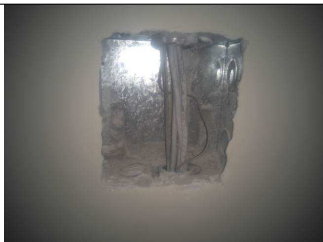
Figura 34E: infraestrutura e cabeamento UTP e alarme - arquivo
