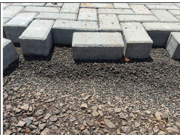
Figura 104C: Base de brita graduada e pó de pedra para pavimentação com blocos.
