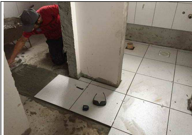
Figura 65C: Assentamento do piso - banheiros da secretaria.
