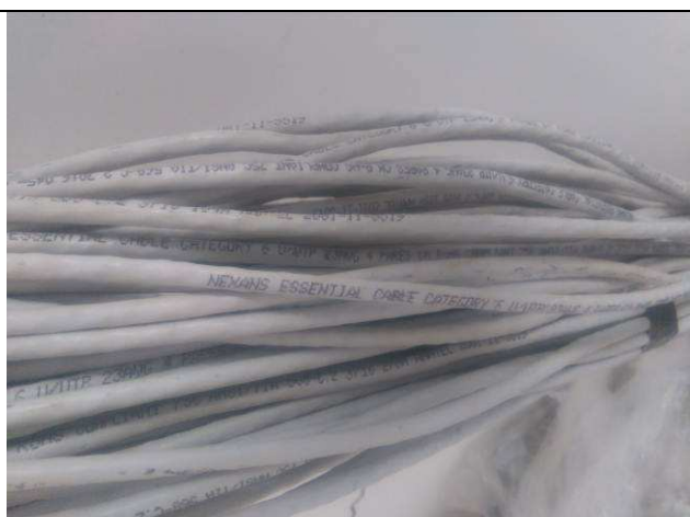
Figura 38E: cabeamento UTP cat6
