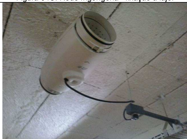
Figura 06C: Exaustores eólicos - estacionamento subsolo.
