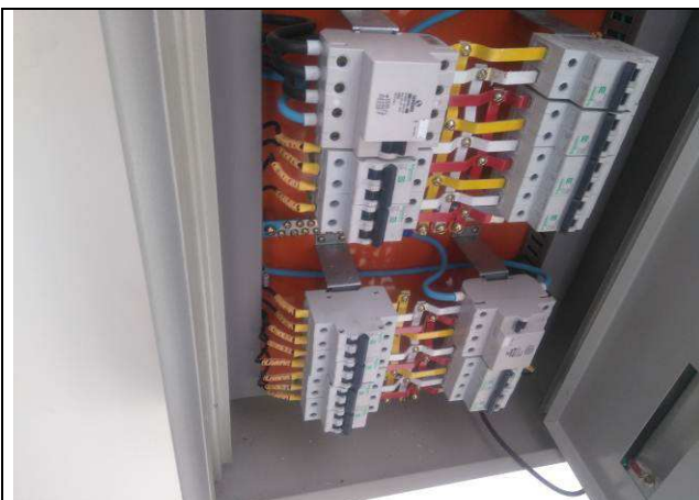
Figura 09E: Alimentação elétrica dos aparelhos - unidade interna.
