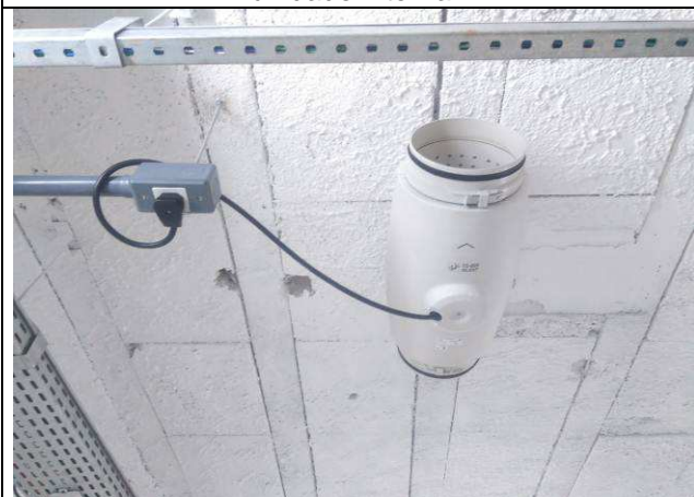
Figura 11E: Alimentação elétrica dos exaustores - estacionamento subsolo.
