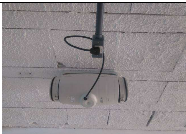
Figura 10E: Alimentação elétrica dos exaustores - estacionamento subsolo.
