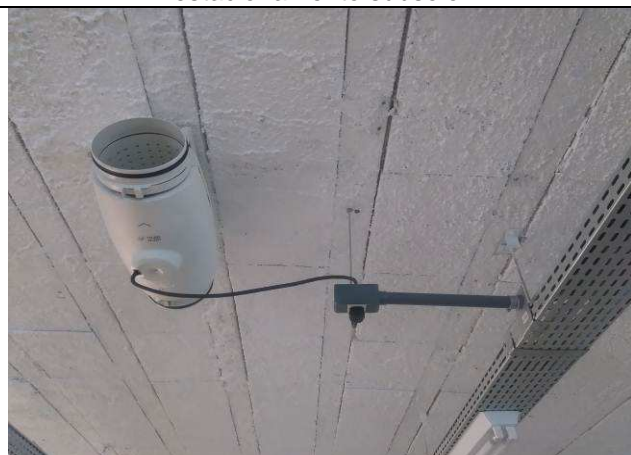
Figura 12E: Alimentação elétrica dos exaustores - estacionamento subsolo.
