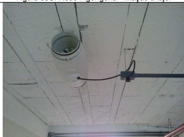
Figura 05C: Exaustores eólicos - estacionamento subsolo.
