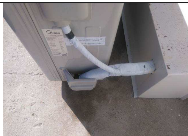
Figura 01E: Tubulação e cabeamento para alimentação dos aparelhos - unidade externa.
