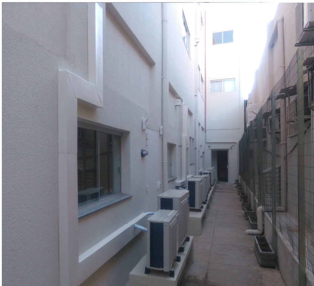
Figura 1 – Vista externa - condensadoras e redes frigorígenas.
