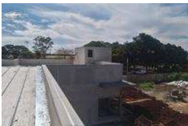
Figura 25 . 13 Fitas em alumínio sobre a platibanda e goivas, para captação SPDA.
