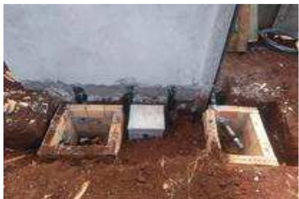
Figura 23 . 8 Caixas de piso externas para ramal de entrada de energia e caixa aterramento.
