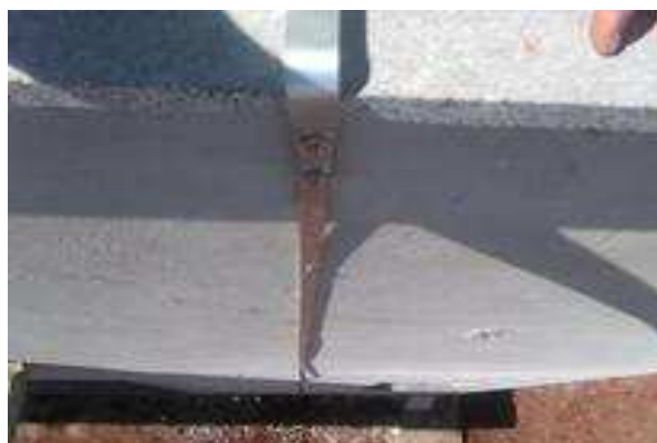
Figura 25 . 10 Fitas em alumínio nas descidas do SPDA.
