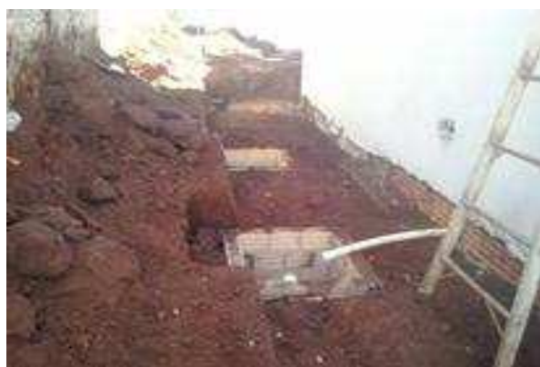
Figura 15 . 6 Caixas de inspeção de esgoto e caixa de gordura, todas sem acabamento interno.
