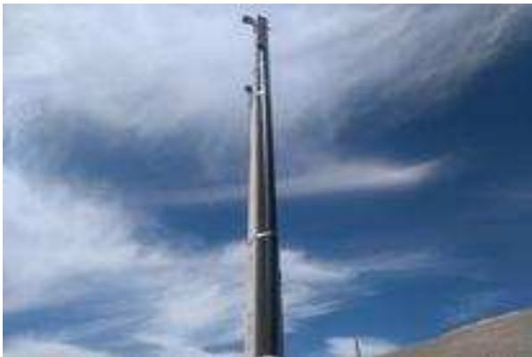
Figura 23 . 5 Entrada de energia elétrica - poste, eletrodutos de descida.
