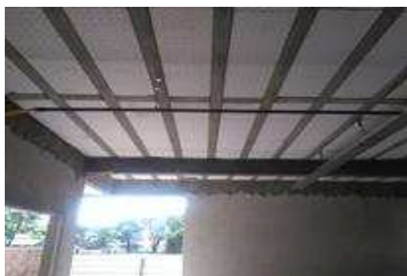
Figura 23 . 14 Eletrodutos rígidos para derivação entre eletrocalhas e parede em alvenaria.
