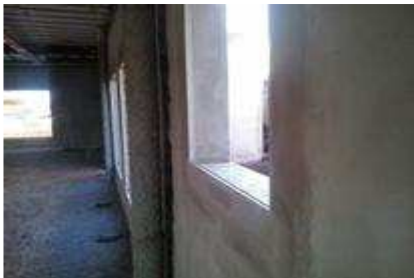
Figura 11 . 3 Rebôco de parede no prédio principal - secretaria.
