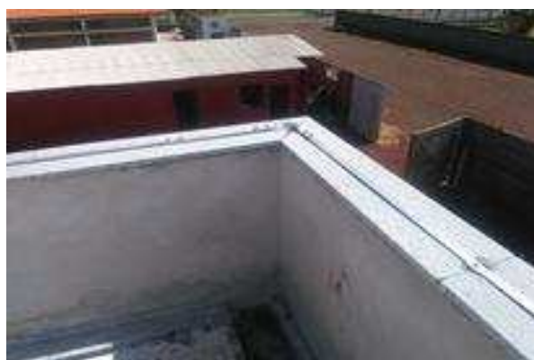
Figura 25 . 8 Fitas em alumínio sobre a platibanda e goivas, para captação SPDA.
