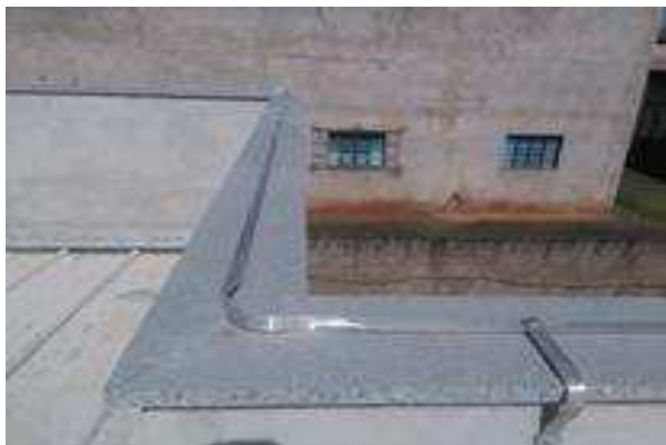
Figura 25 . 11 Fitas em alumínio sobre a platibanda e goivas, para captação SPDA.
