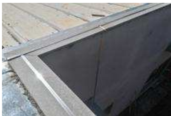
Figura 25 . 14 Fitas em alumínio sobre a platibanda e goivas, para captação SPDA.
