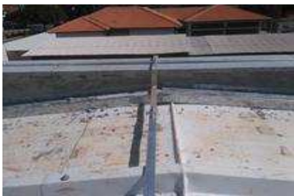
Figura 25 . 9 Fitas em alumínio sobre a platibanda e goivas, para captação SPDA.
