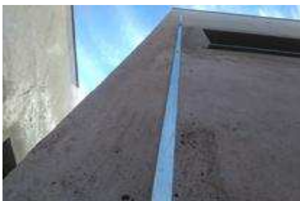
Figura 25 . 7 Fitas em alumínio nas descidas do SPDA.
