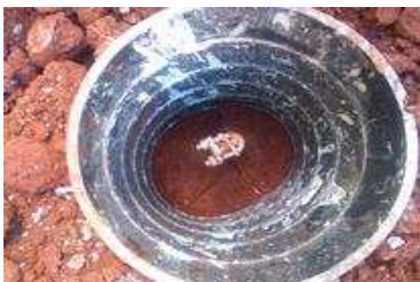
Figura 25 . 1 Malha de aterramento, hastes e caixas de inspeção nos pontos de descida SPDA.
