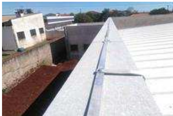
Figura 25 . 12 Fitas em alumínio sobre a platibanda e goivas, para captação SPDA.
