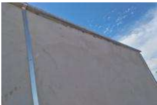
Figura 25 . 15 Fitas em alumínio nas descidas do SPDA.
