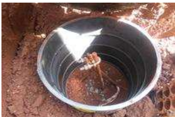
Figura 25 . 5 Malha de aterramento, hastes e caixas de inspeção nos pontos de descida SPDA.
