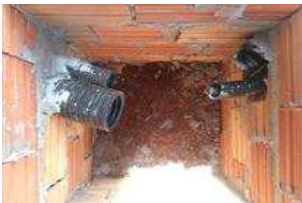
Figura 23 . 7 Caixas de piso externas para ramal de entrada de energia - dutos para TRT e PAB.
