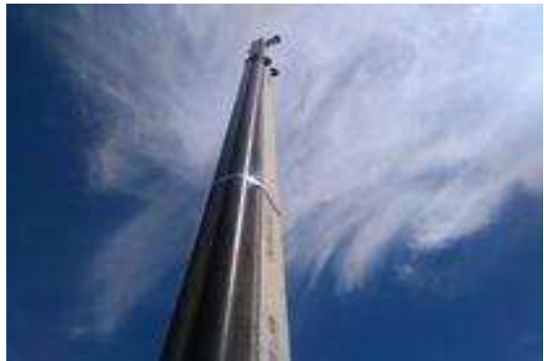
Figura 23 . 6 Entrada de energia elétrica - poste, eletrodutos de descida.
