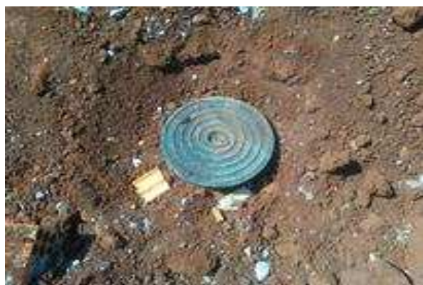
Figura 25 . 6 Malha de aterramento, hastes e caixas de inspeção nos pontos de descida SPDA.
