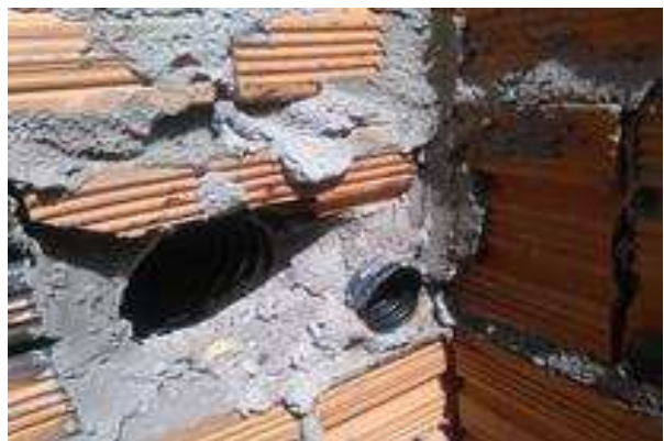
Figura 23 . 10 Caixas de piso externas para ramal de entrada de energia - dutos para TRT e PAB.
