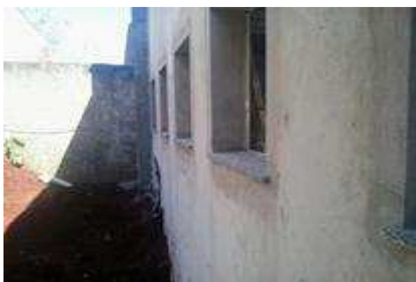
Figura 12 . 1 Rebôco da parede localizada nos fundos da copa e sanitários da secretaria.
