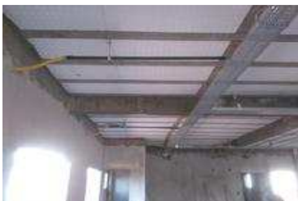
Figura 23 . 13 Eletrodutos rígidos para derivação entre eletrocalhas e parede em alvenaria.
