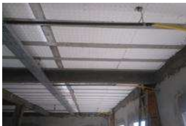
Figura 23 . 12 Eletrodutos rígidos para derivação entre eletrocalhas e parede em alvenaria.
