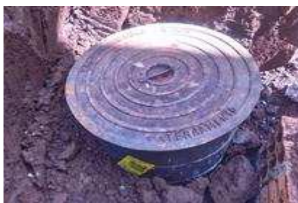
Figura 25 . 4 Malha de aterramento, hastes e caixas de inspeção nos pontos de descida SPDA.
