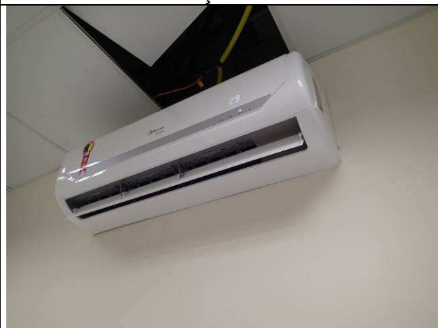
Figura 12C: Evaporadora 22.000 BTU's - sala múltiplo uso - térreo.
