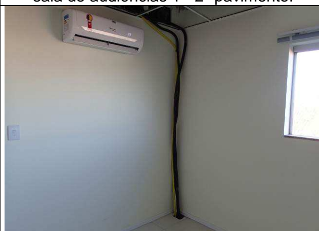
Figura 48C: Evaporadora 12.000 BTU's - sala de conciliação 1 - 2º pavimento.
