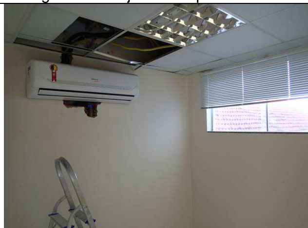
Figura 29C: Evaporadora 22.000 BTU's - assessoria 1 - 1º pavimento.
