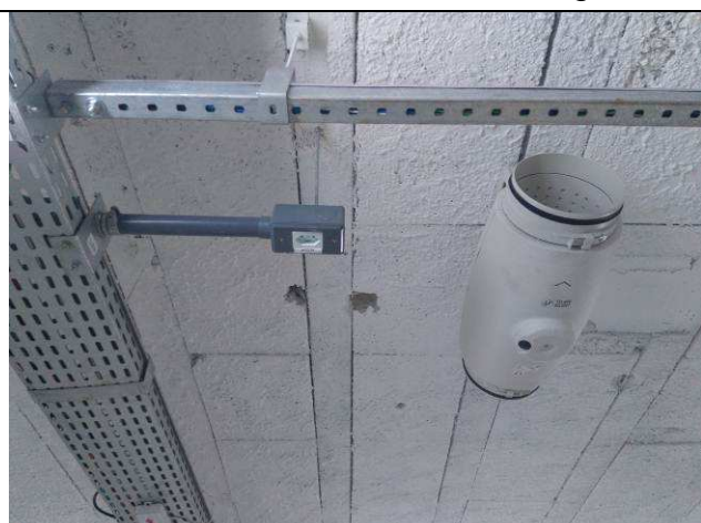
Figura 14E: condutores, tomadas elétricas, infraestrutura eletrodutos PVC rígido.
