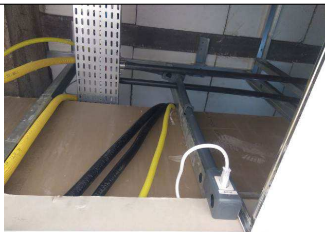
Figura 12E: condutores, tomadas elétricas, infraestrutura eletrodutos PVC rígido.
