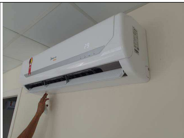
Figura 44C: Evaporadora 22.000 BTU's - gabinete de juiz 1 - 2º pavimento.
