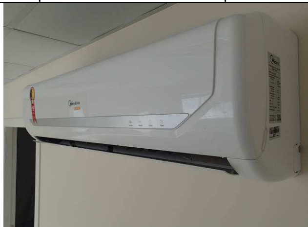
Figura 28C: Evaporadora 22.000 BTU's - gabinete de juiz 1 - 1º pavimento.
