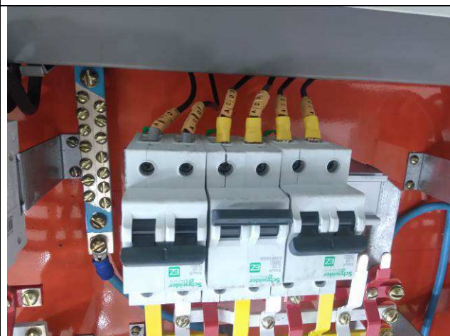
Figura 19E: disjuntores e alimentadores quadro elétrico do pavimento térreo.
