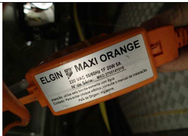
Figura 25C: Bomba de dreno - evaporadoras - secretaria - 1º pavimento.
