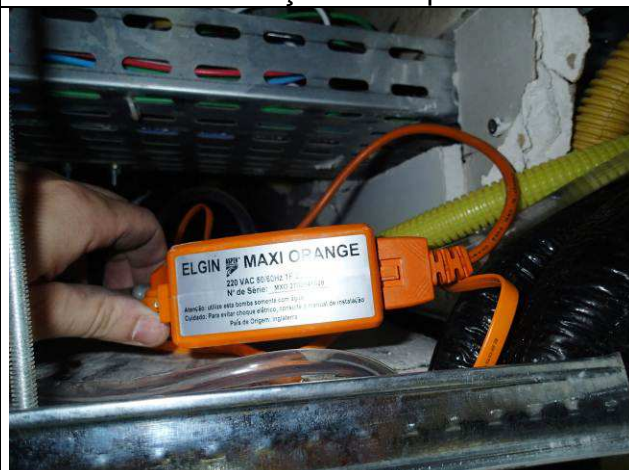
Figura 34C: Bomba de dreno - evaporadora - sala de audiências 2 - 2º pavimento.
