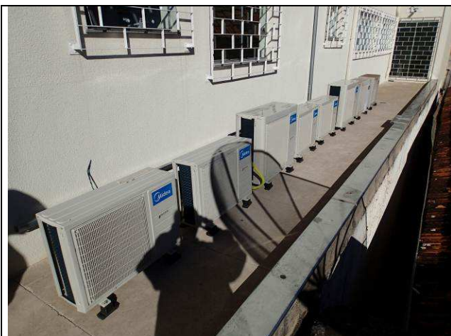
Figura 49C: Condensadoras - laje técnica do 1º pavimento.
