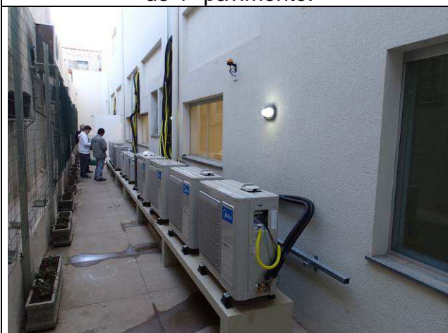
Figura 51C: Condensadoras - corredor técnico do térreo.
