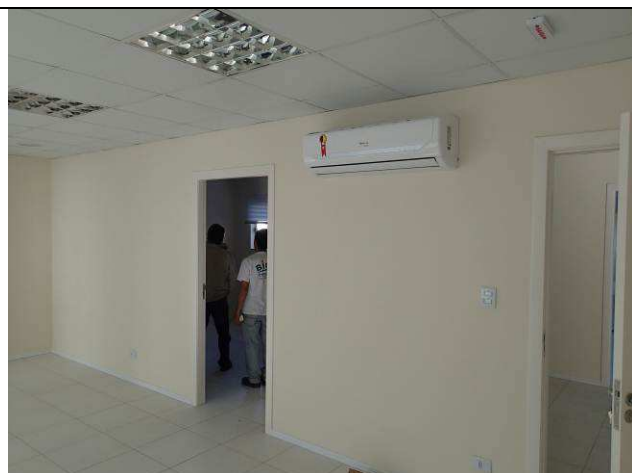
Figura 43C: Evaporadora 22.000 BTU's - gabinete de juiz 1 - 2º pavimento.
