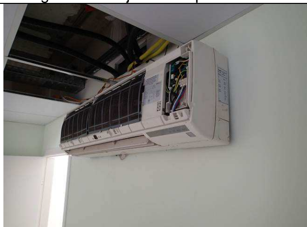
Figura 30C: Evaporadora 30.000 BTU's - sala de audiências 1 - 1º pavimento.
