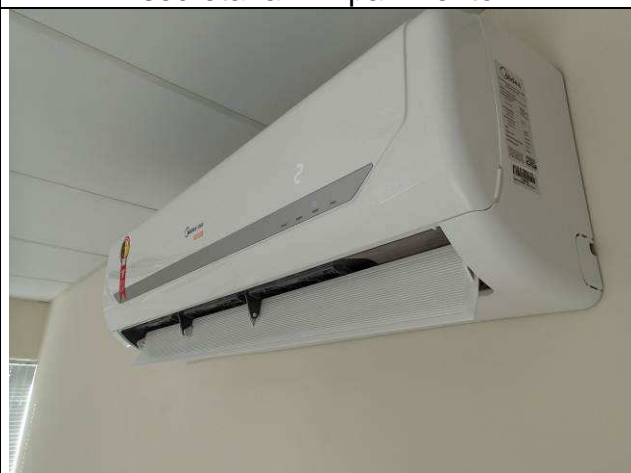
Figura 24C: Evaporadoras 22.000 BTU's - secretaria - 1º pavimento.
