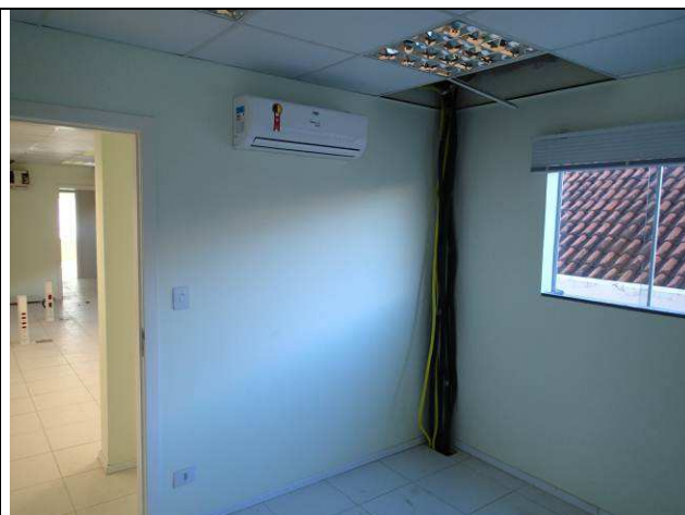
Figura 32C: Evaporadora 12.000 BTU's - sala de conciliação 1 - 1º pavimento.
