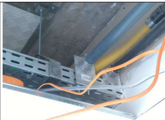
Figura 11E: condutores, tomadas elétricas, infraestrutura eletrodutos PVC rígido.
