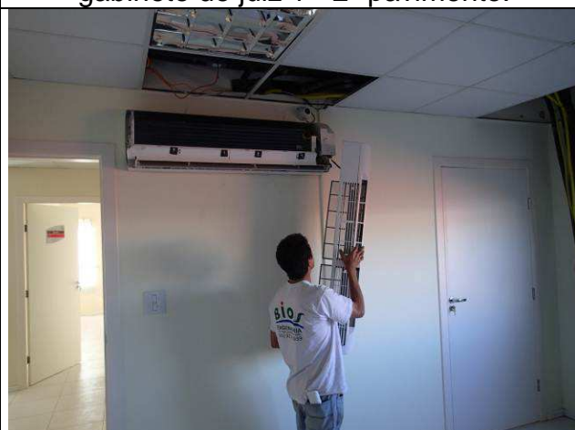
Figura 46C: Evaporadora 30.000 BTU's - sala de audiências 1 - 2º pavimento.
