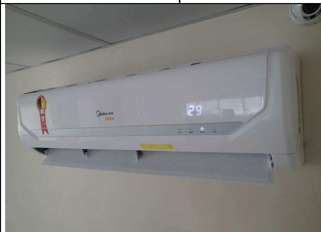
Figura 40C: Evaporadoras 22.000 BTU's - secretaria - 2º pavimento.
