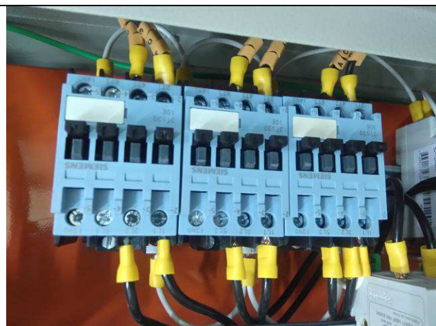
Figura 29E: contactores - automação ventiladores subsolo.
