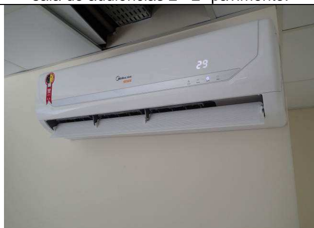
Figura 35C: Evaporadora 22.000 BTU's - gabinete de juiz 2 - 2º pavimento.
