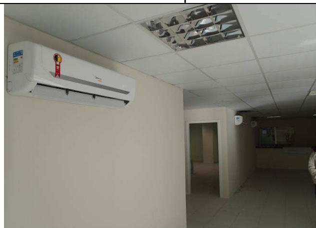
Figura 21C: Evaporadoras 22.000 BTU's - secretaria - 1º pavimento.
