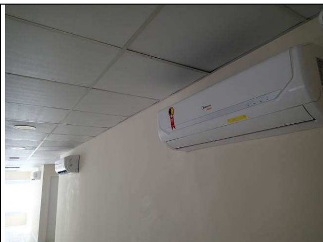
Figura 38C: Evaporadoras 22.000 BTU's - secretaria - 2º pavimento.
