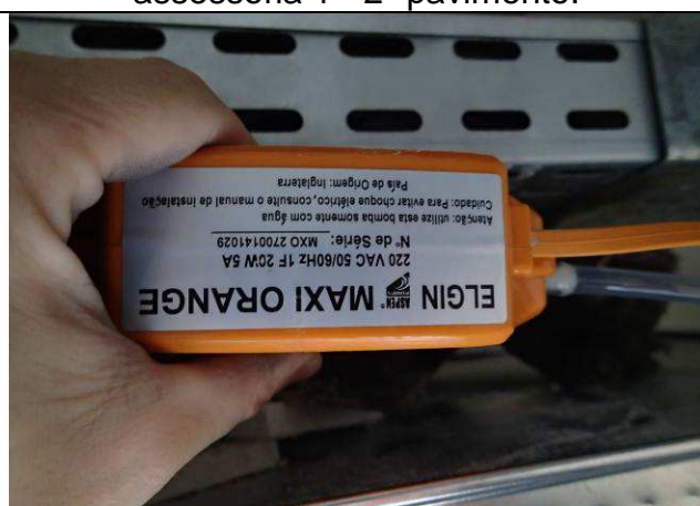
Figura 47C: Bomba de dreno - evaporadora - sala de audiências 1 - 2º pavimento.
