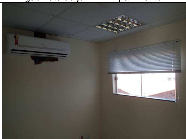
Figura 45C: Evaporadora 22.000 BTU's - assessoria 1 - 2º pavimento.
