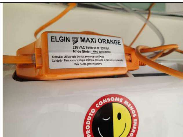
Figura 13C: Bomba de dreno - evaporadoras - sala múltiplo uso - térreo.
