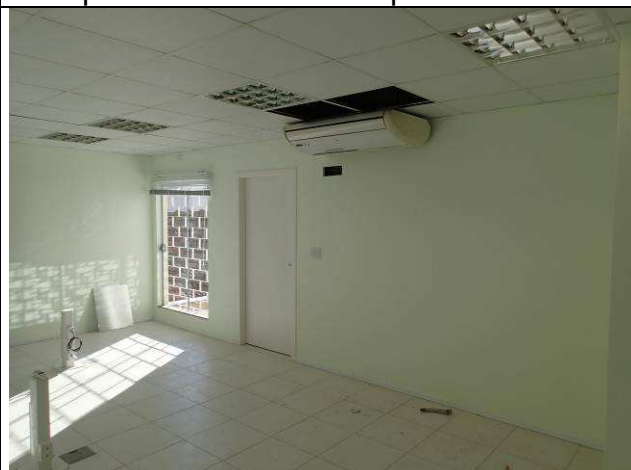
Figura 15C: Evaporadora 30.000 BTU's - sala de audiências 2 - 1º pavimento.
