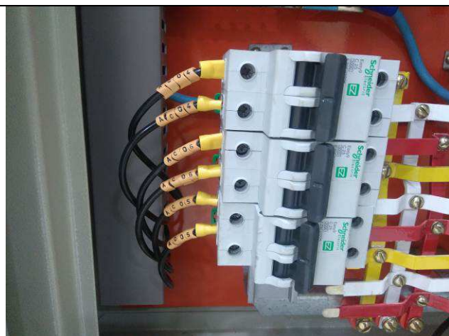
Figura 20E: disjuntores e alimentadores quadro elétrico do pavimento térreo.
