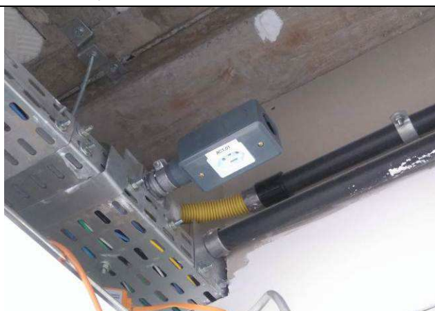
Figura 10E: condutores, tomadas elétricas, infraestrutura eletrodutos PVC rígido.
