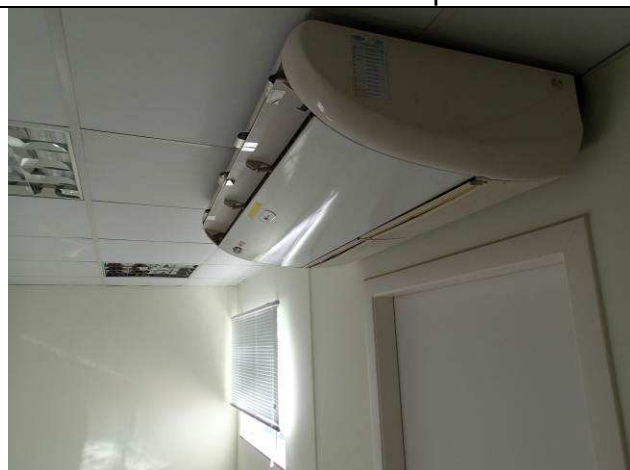
Figura 33C: Evaporadora 30.000 BTU's - sala de audiências 2 - 2º pavimento.
