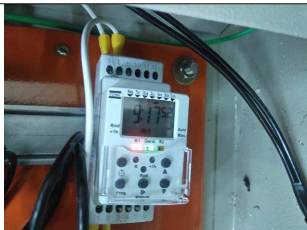
Figura 30E: temporizador - automação ventiladores subsolo.
