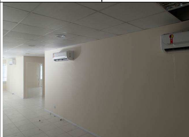
Figura 22C: Evaporadoras 22.000 BTU's - secretaria - 1º pavimento.
