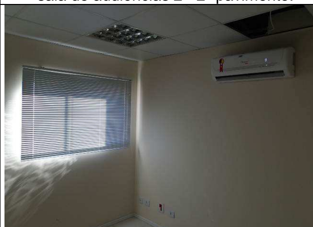
Figura 36C: Evaporadora 12.000 BTU's - assessoria 2 - 2º pavimento.
