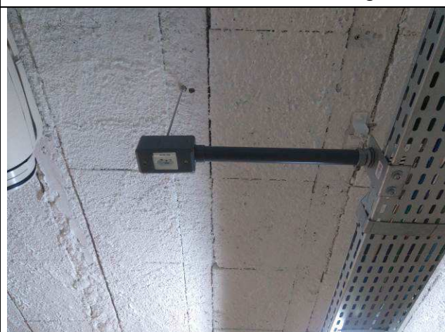
Figura 13E: condutores, tomadas elétricas, infraestrutura eletrodutos PVC rígido.
