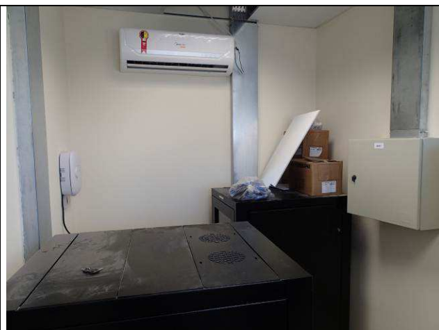
Figura 20C: Evaporadora 12.000 BTU's - sala site - 1º pavimento.
