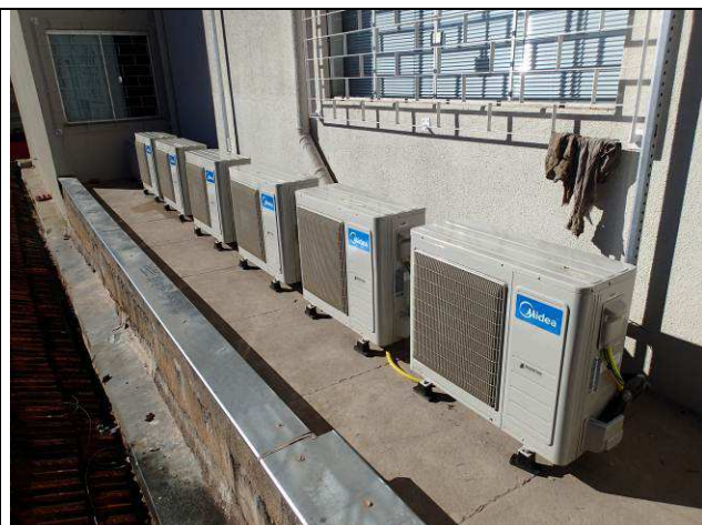
Figura 50C: Condensadoras - laje técnica do 1º pavimento.
