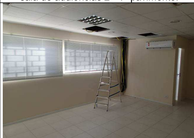
Figura 17C: Evaporadora 22.000 BTU's - gabinete de juiz 2 - 1º pavimento.
