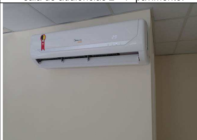
Figura 18C: Evaporadora 22.000 BTU's - gabinete de juiz 2 - 1º pavimento.
