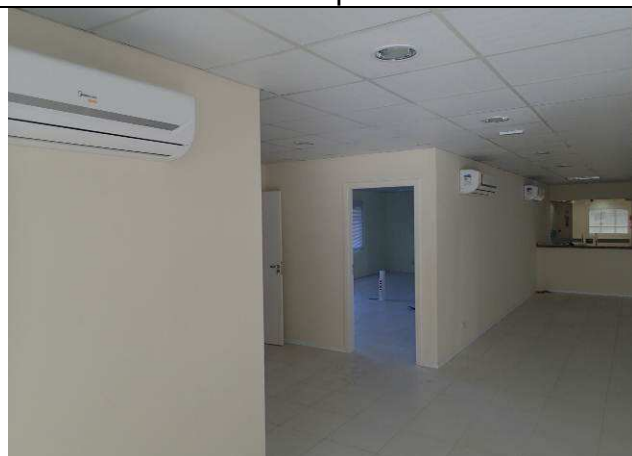
Figura 39C: Evaporadoras 22.000 BTU's - secretaria - 2º pavimento.
