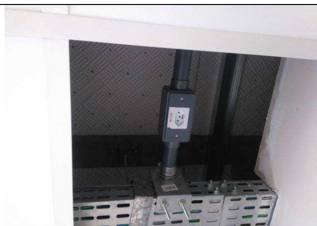
Figura 09E: condutores, tomadas elétricas, infraestrutura eletrodutos PVC rígido.
