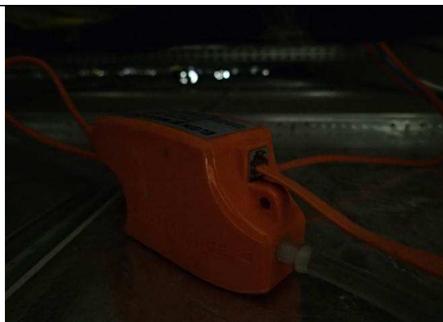
Figura 26C: Bomba de dreno - evaporadoras - secretaria - 1º pavimento.
