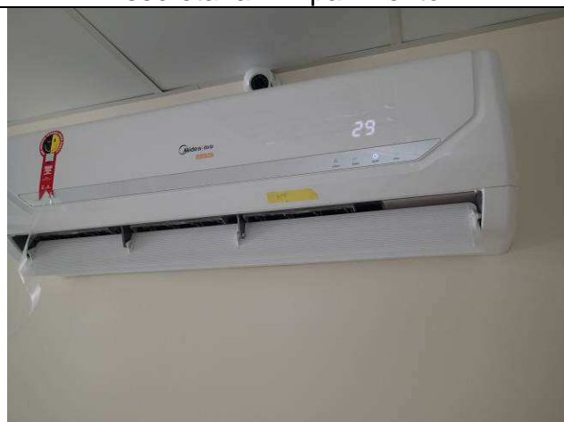
Figura 23C: Evaporadoras 22.000 BTU's - secretaria - 1º pavimento.
