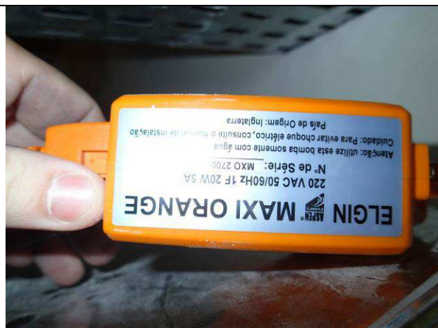
Figura 31C: Bomba de dreno - evaporadora - sala de audiências 1 - 1º pavimento.
