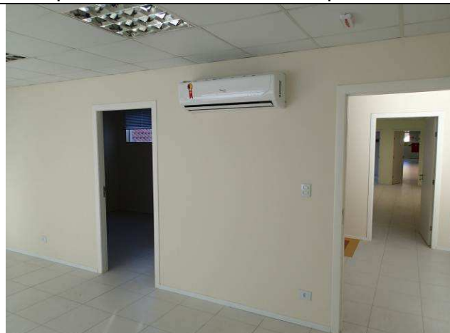
Figura 27C: Evaporadora 22.000 BTU's - gabinete de juiz 1 - 1º pavimento.
