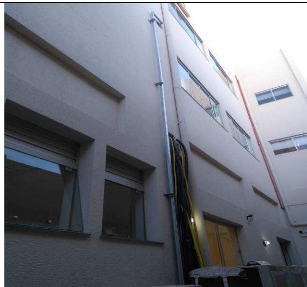
Figura 01E: Infraestrutura perfilados - comunicação externa entre 1º pavimento e térreo.
