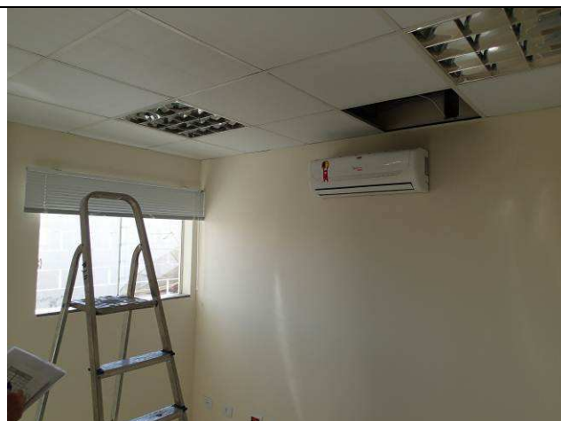
Figura 19C: Evaporadora 12.000 BTU's - assessoria 2 - 1º pavimento.
