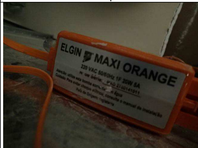
Figura 42C: Bomba de dreno - evaporadoras - secretaria - 1º pavimento.
