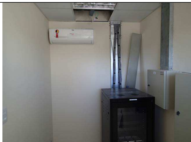
Figura 37C: Evaporadora 12.000 BTU's - sala site - 2º pavimento.
