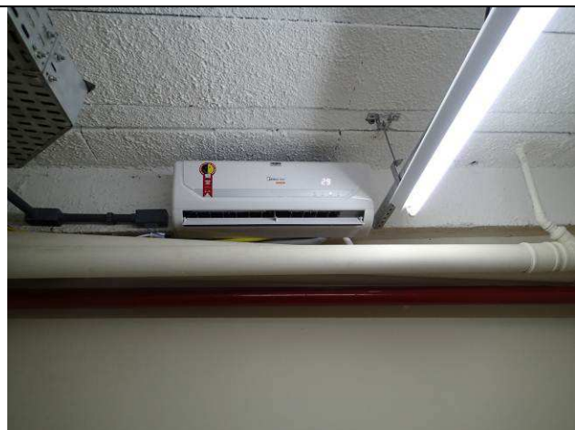
Figura 09C: Evaporadora 12.000 BTU's - sala técnica - subsolo.
