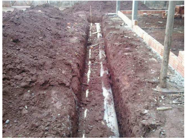
Figura 04C: Abertura de vala para execução da rede de esgoto e pluvial externa
