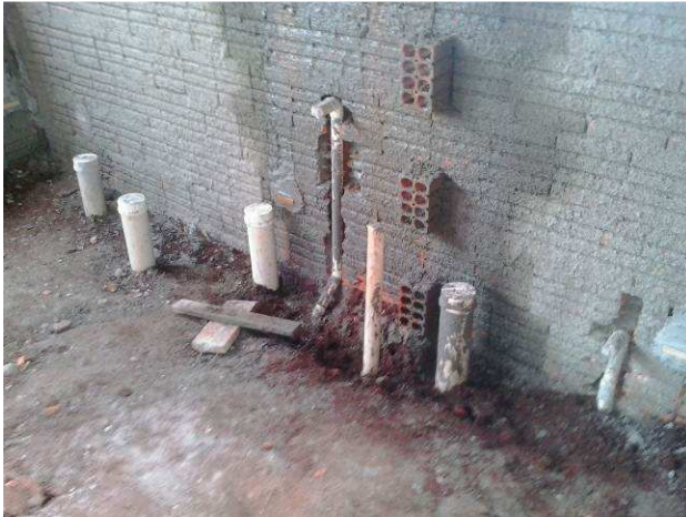
Figura 36C: Pontos de esgoto primário e secundário, no interior do arquivo
