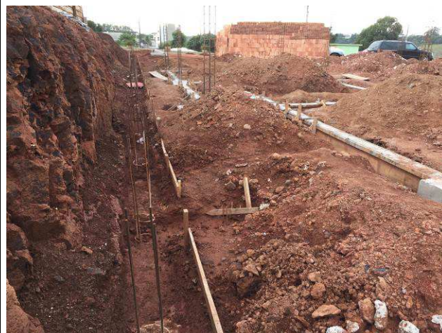
Figura 66C: Estacas concretadas e escavação da viga baldrame e blocos - muro de arrimo.
