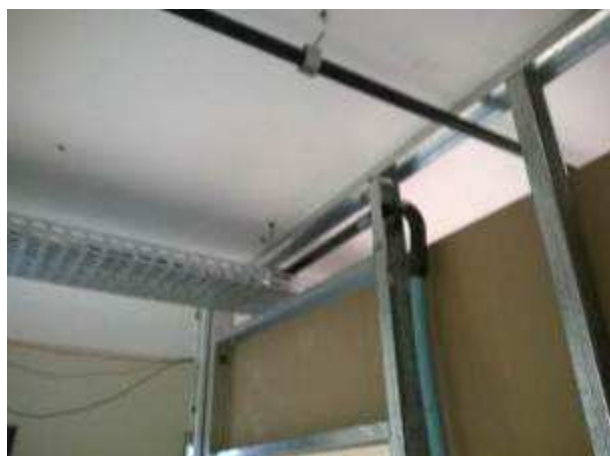
Figura 07E: Eletrodutos corrugados e de PVC rígido
