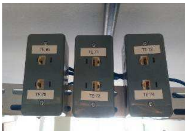
Figura 12E: Tomadas RJ 45 e tampas de condutele
