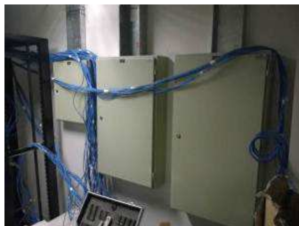
Figura 08E: Novos quadros elétricos
