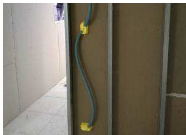
Figura 06E: Eletrodutos corrugados e caixas de ligação 4x2".
