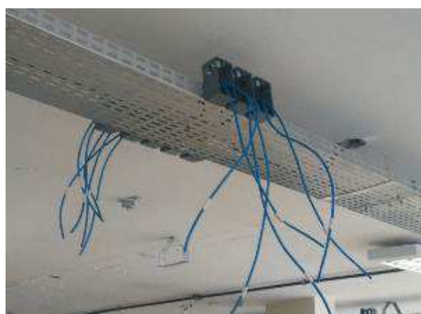
Figura 10E: Cabeamento lógico instalado
